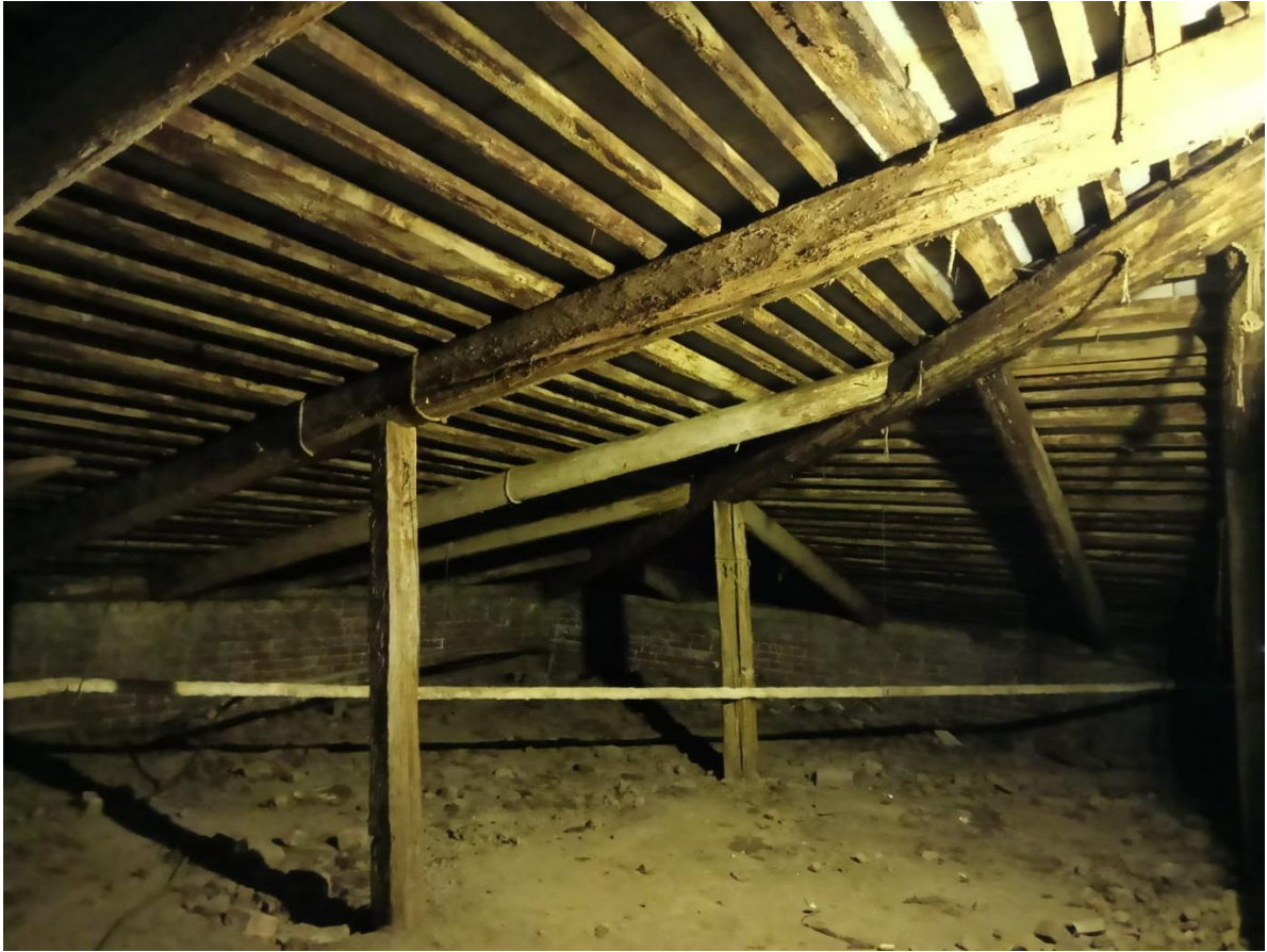
Фото 5. Выявленный объект культурного наследия «Здание Александро-Мариинского детского приюта Ивана Базилевского», расположенный по адресу: Санкт-Петербург, Большой Сампсониевский проспект, дом 34, лит.А. Конструкция (деревянная, стропильная) крыши.
