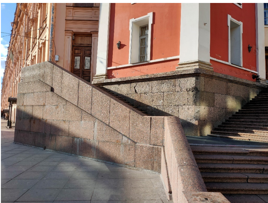
20. «Дума городская с башней (1752-1753 г.г., 1799-1804 г.г., арх. Феррари Д. 1848-1852 г.г., арх. Ефимов Н.Е., 1913-1914 г.г., арх. Кенель А.В.)», ул. Думская, д 1-3, Невский просп. лит. А. Восточный фасад. Фрагмент. Фото 17.10.2023г.
