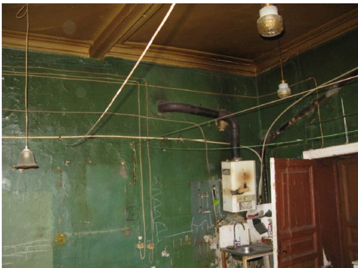
17. Помещение № 17 квартиры №14 в уровне 4-го этажа объекта культурного наследия федерального значения «Дом, где в 1887-1891 гг. жил композитор Рубинштейн А.Г. Здесь в 1905-1906 гг. проходили заседания ЦК РСДРП», расположенного по адресу: г. Санкт-Петербург, Загородный пр., д. 9, литера А. 15.09.2022
