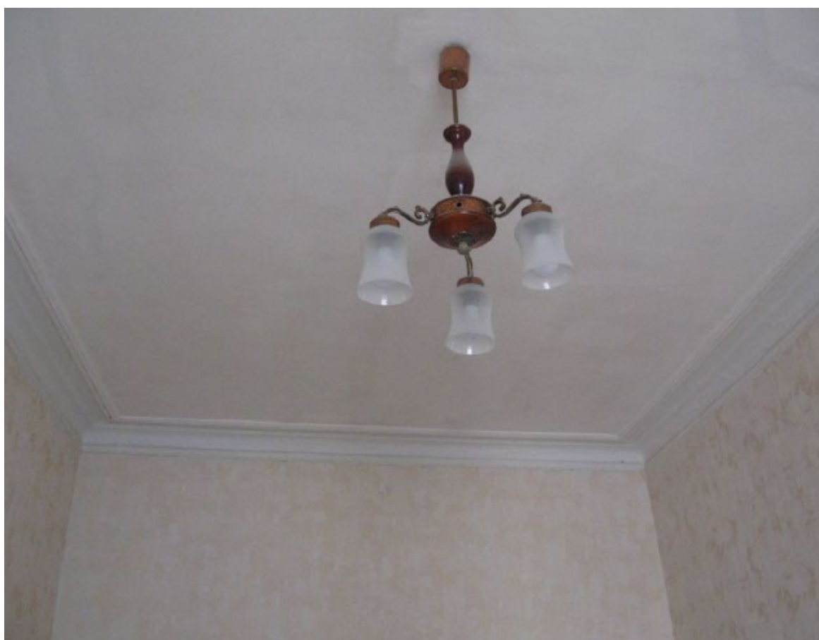
15. Помещение № 11 квартиры №14 в уровне 4-го этажа объекта культурного наследия федерального значения «Дом, где в 1887-1891 гг. жил композитор Рубинштейн А.Г. Здесь в 1905-1906 гг. проходили заседания ЦК РСДРП», расположенного по адресу: г. Санкт-Петербург, Загородный пр., д. 9, литера А. 15.09.2022
