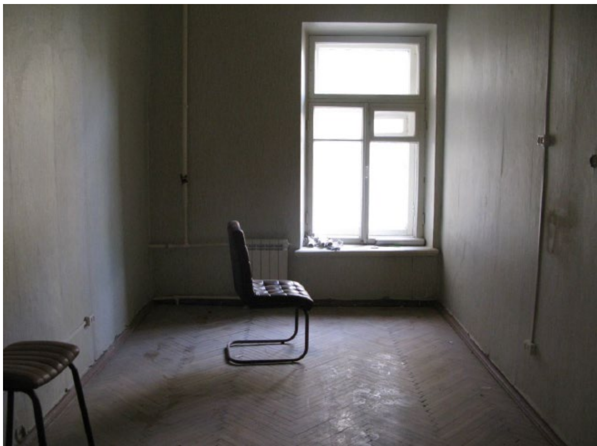
13. Помещение № 13 квартиры №14 в уровне 4-го этажа объекта культурного наследия федерального значения «Дом, где в 1887-1891 гг. жил композитор Рубинштейн А.Г. Здесь в 1905-1906 гг. проходили заседания ЦК РСДРП», расположенного по адресу: г. Санкт-Петербург, Загородный пр., д. 9, литера А. 15.09.2022
