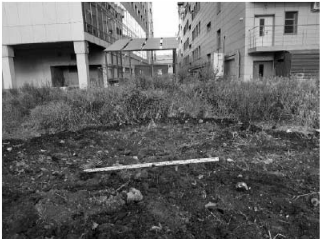
Рис. 169. Санкт-Петербург, «Строительство Красносельско-Калининской линии от станции «Казаковская» до станции «Обводный канал-2» с электродепо «Красносельское». Участок обследования «Строительная площадка шахты 848. Рабочий ствол». Шурф 1. Фотофиксация после рекультивации Вид на восток.
