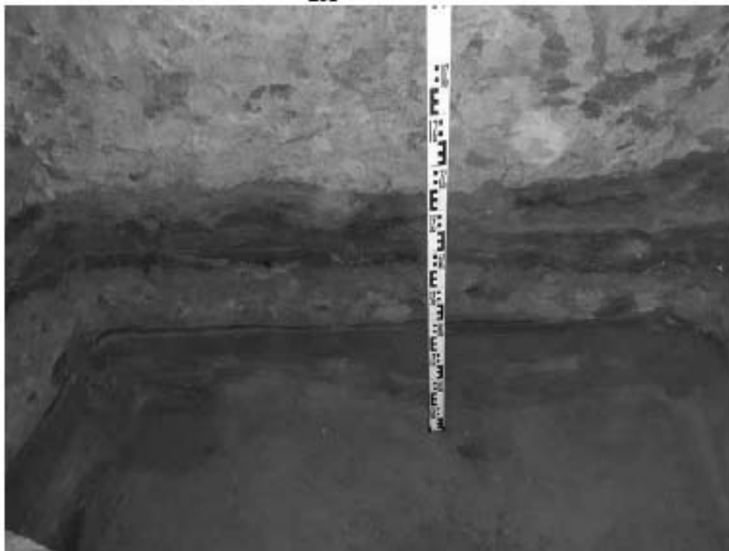
Рис. 134 Санкт-Петербург, «Строительство Красносельско-Калининской линии от станции «Казаковская» до станции «Обводный канал-2» с электродепо «Красносельское». Участок обследования «Строительная площадка вестибюля №1 станции «Черниговская». Шурф 1. Фотофиксация нижней части стратиграфии западной стенки.
