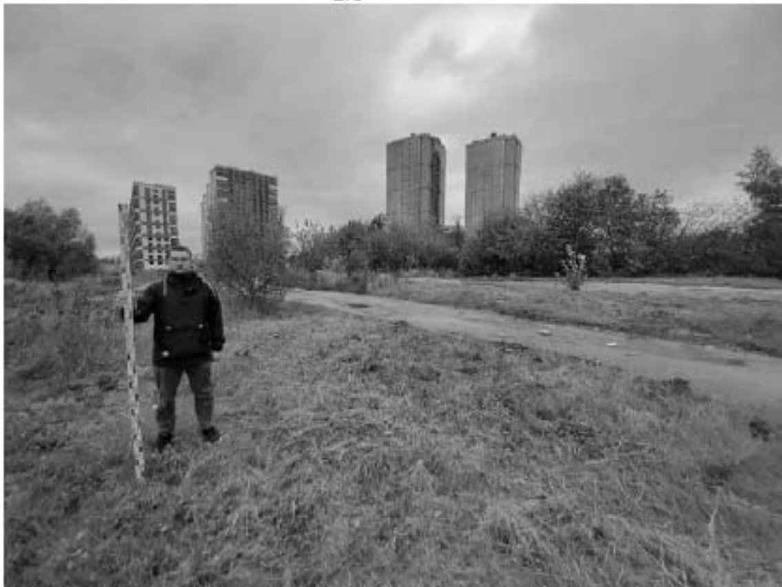
Рис. 111 Санкт-Петербург, «Строительство Красносельско-Калининской линии от станции «Казаковская» до станции «Обводный канал-2» с электродепо «Красносельское». Участок обследования «Строительная площадка вестибюля №1 станции «Черниговская». Общие виды.
