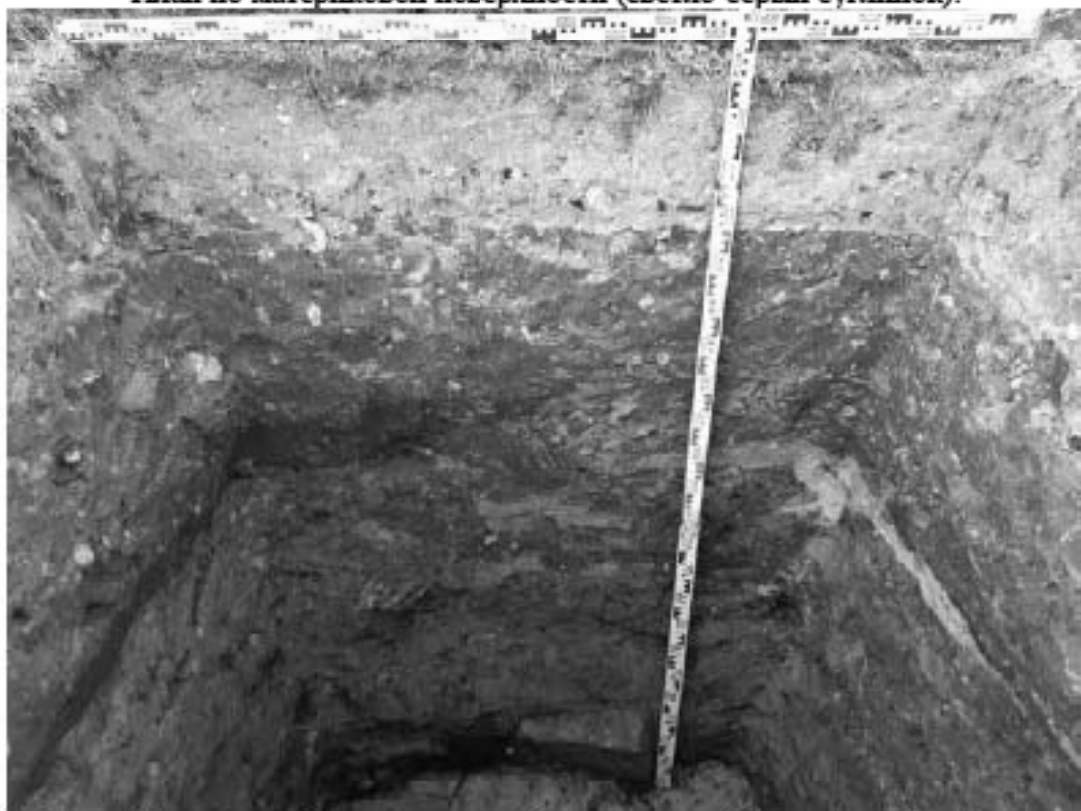
Рис. 81. Санкт-Петербург, «Строительство Красносельско-Калининской линии от станции «Казакская» до станции «Обводный канал-2» с электродепо «Красносельское». Участок обследования «Строительная площадка вестибюля станции «Броневая». Шурф 1. Фотофиксация стратиграфии северной стенки.
