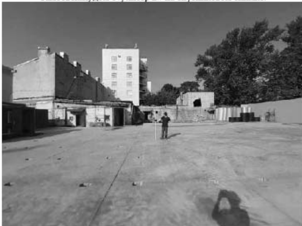
Рис. 280. Санкт-Петербург. «Строительство Красносельско-Калининской линии от станции «Казаконская» до станции «Обводный канал-2» с электродепо «Красносельское». Участок от станции «Путиловская» до станции «Каретная». Участок обследования «Строительная площадка шахты 852 по адресу: Фрунзенский район, западнее здания по адресу ул. Тамбовская, дом 17, литер Б». Общие виды.
