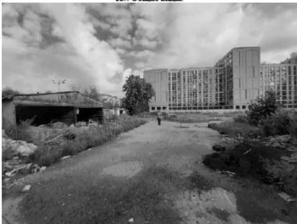
Рис. 201 Санкт-Петербург, «Строительство Красносельско-Калининской линии от станции «Казаковская» до станции «Обводный канал-2» с электродепо «Красносельское». Участок обследования «Строительная площадка вестибюля № 2 станции «Боровая». Строительная площадка шахты № 850 по адресу: Фрунзенский район, Лиговский проспект, дом 26, литера И». Общие виды.
