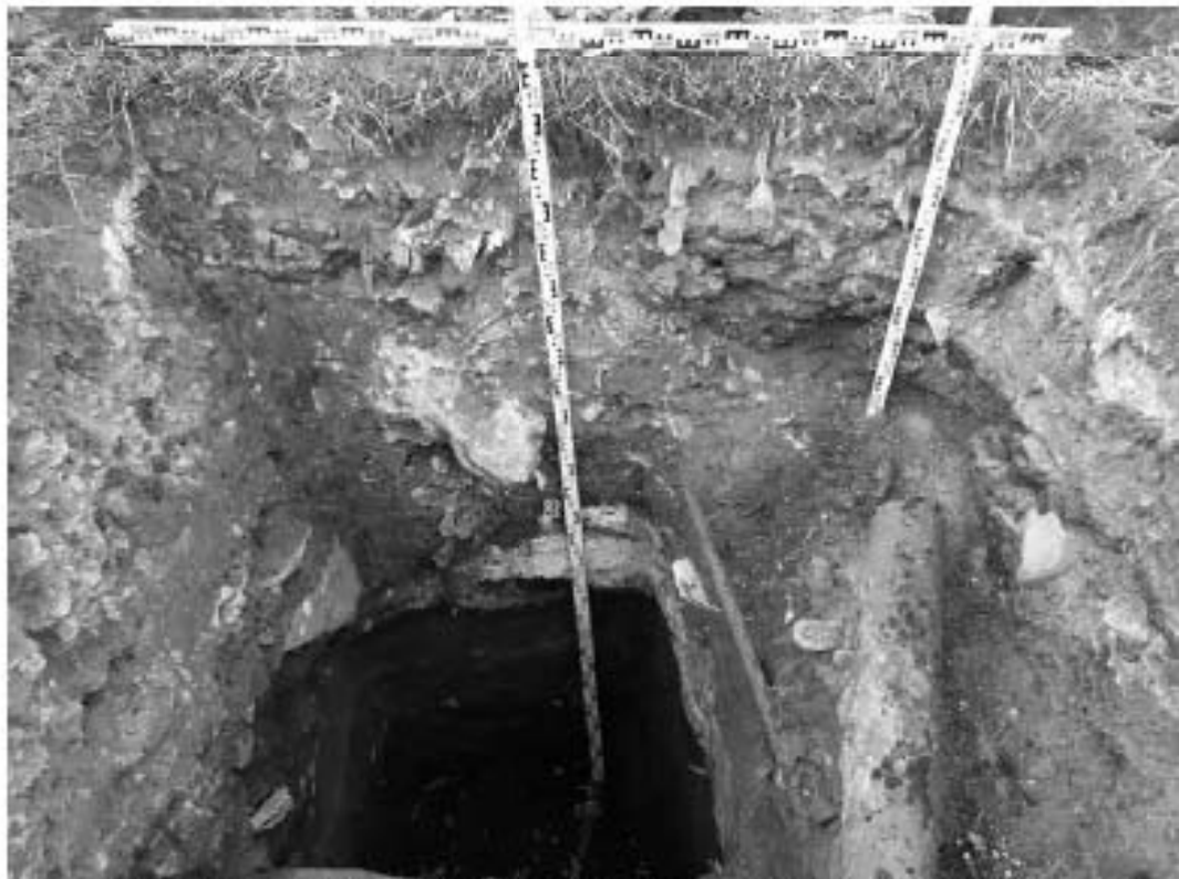
Рис. 158 Санкт-Петербург, «Строительство Красносельско-Калининской линии от станции «Казаконская» до станции «Обводный канал-2» с электродепо «Красносельское». Участок обследования «Строительная площадка шахты 848. Рабочий ствол». Шурф 1. Фотофиксация стратиграфии северной стенки.
