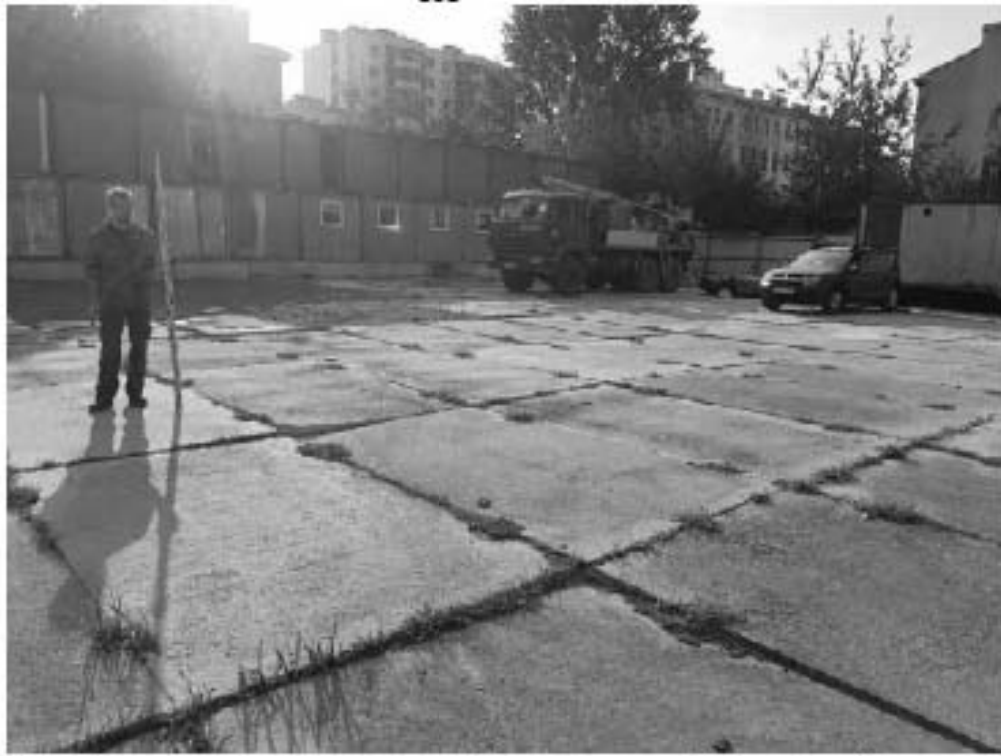
Рис. 303 Санкт-Петербург. «Строительство Красносельско-Калининской линии от станции «Казаковская» до станции «Обводный канал-2» с электродепо «Красносельское». Участок от станции «Путиловская» до станции «Каретная». Участок обследования «Строительная площадка шахты №853 по адресу: Центральный район, южнее здания по адресу ул. Черняховского, дом 19». Общие виды.
