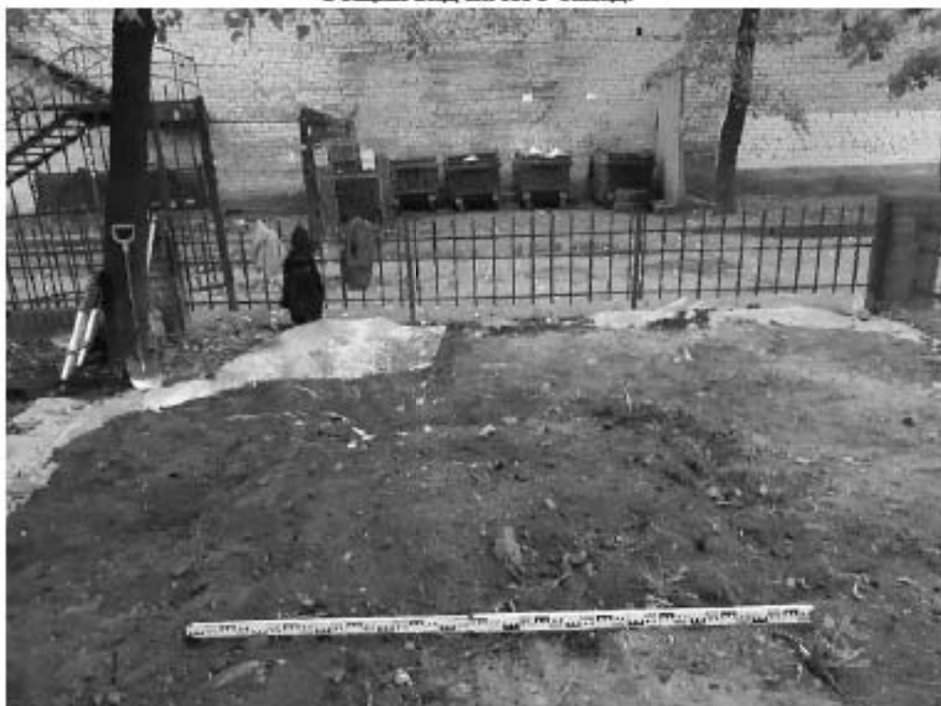
Рис. 278. Санкт-Петербург. «Строительство Красносельско-Калининской линии от станции «Казаковская» до станции «Обводный канал-2» с электродепо «Красносельское». Участок от станции «Путиловская» до станции «Каретная». Участок обследования «Строительная площадка вестибюля № 1 станции «Каретная». Шурф 1. Фотофиксация после рекультивации. Вид на юго-запад.
