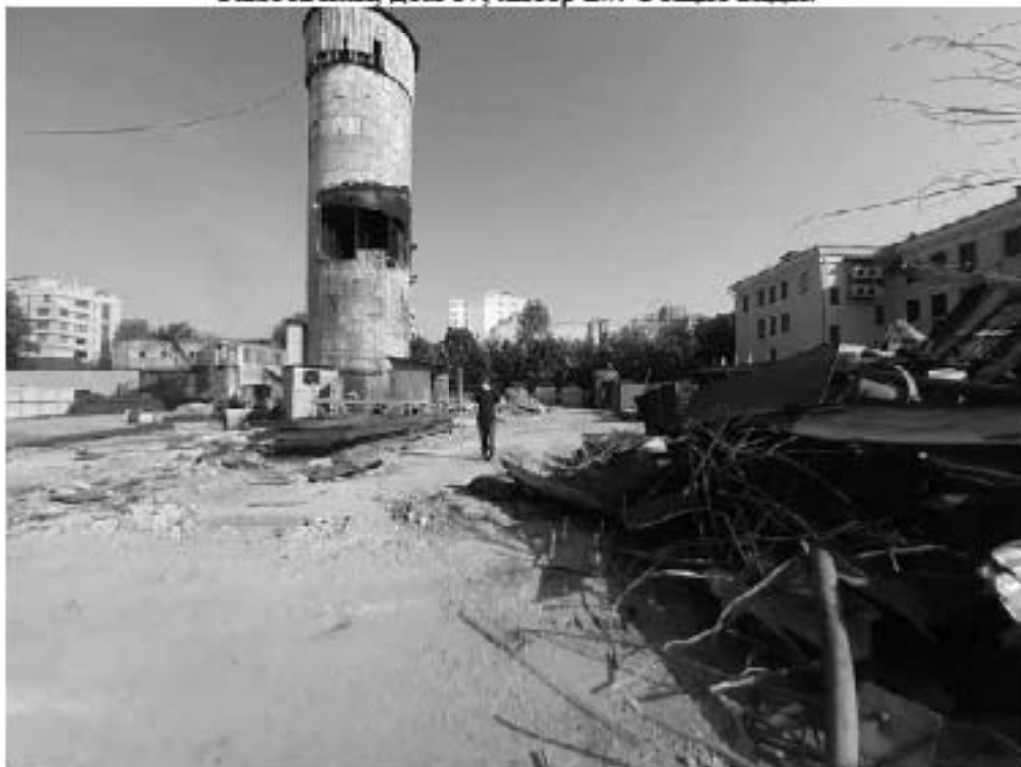
Рис. 288 Санкт-Петербург. «Строительство Красносельско-Калининской линии от станции «Казакская» до станции «Обводный канал-2» с электродепо «Красносельское». Участок от станции «Путиловская» до станции «Каретная». Участок обследования «Строительная площадка шахты 852 по адресу: Фрунзенский район, западнее здания по адресу ул. Тамбовская, дом 17, литер Б». Общие виды.
