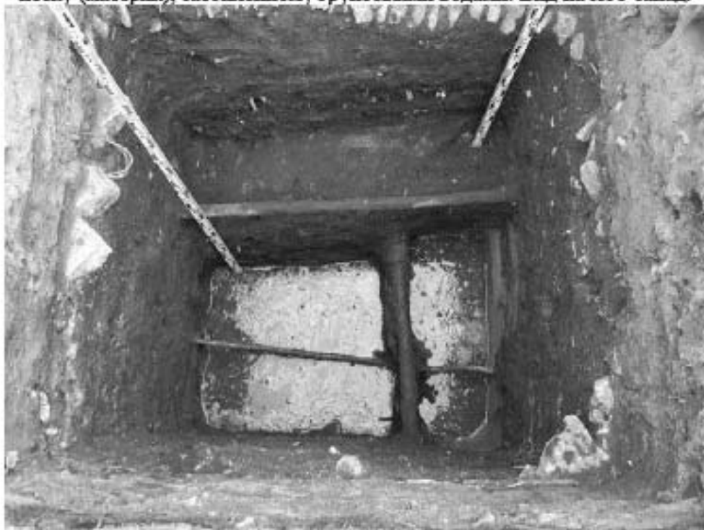
Рис. 235. Санкт-Петербург. «Строительство Красносельско-Калининской линии от станции «Казаковская» до станции «Обводный канал-2» с электродепо «Красносельское». Участок от станции «Путиловская» до станции «Каретная». Участок обследования «Строительная площадка шахты № 851 по адресу: Фрунзенский район, Расстанная улица на свободной территории между домами №7 и №13». Шурф 1. Фотофиксация по Серовато-коричневому песку (материк), затопленному грунтовыми водами. Вид на юго-запад.
