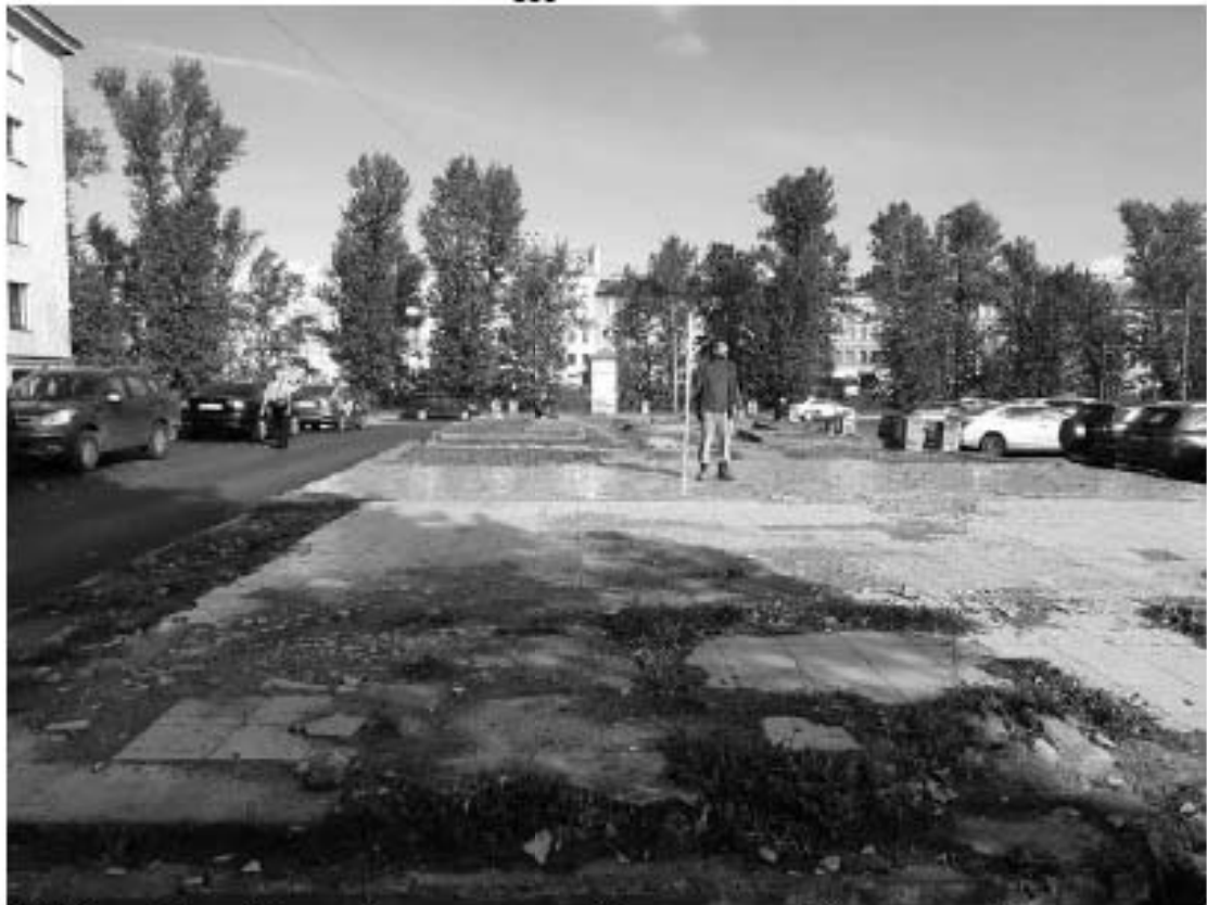
Рис. 244. Санкт-Петербург. «Строительство Красносельско-Калининской линии от станции «Казаковская» до станции «Обводный канал-2» с электродепо «Красносельское». Участок от станции «Путиловская» до станции «Каретная». Участок обследования «Строительная площадка вестибюля № 1 станции «Каретная». Общие виды.
