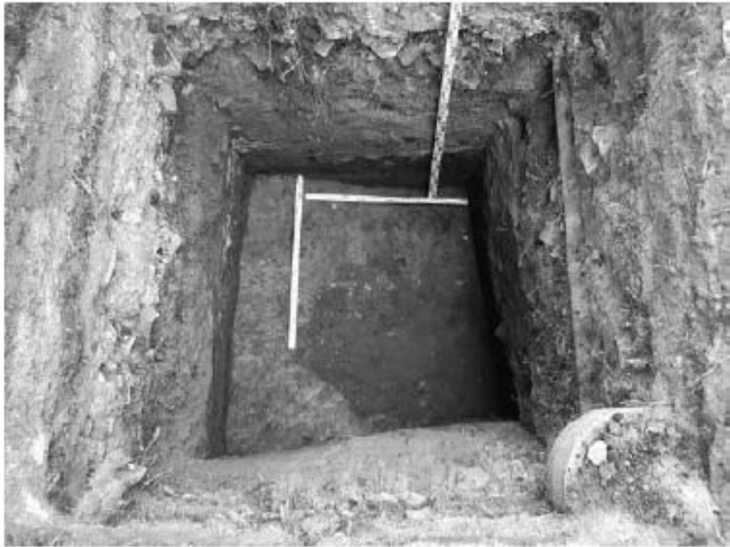
Рис. 264. Санкт-Петербург. «Строительство Красносельско-Калининской линии от станции «Казаковская» до станции «Обводный канал-2» с электродепо «Красносельское». Участок от станции «Путиловская» до станции «Каретная». Участок обследования «Строительная площадка вестибюля № 1 станции «Каретная». Шурф 1. Фотофиксация материковой поверхности (желтовато-коричневая супеси) с размытыми контурами ямы 1. Вид на юго-запад.
