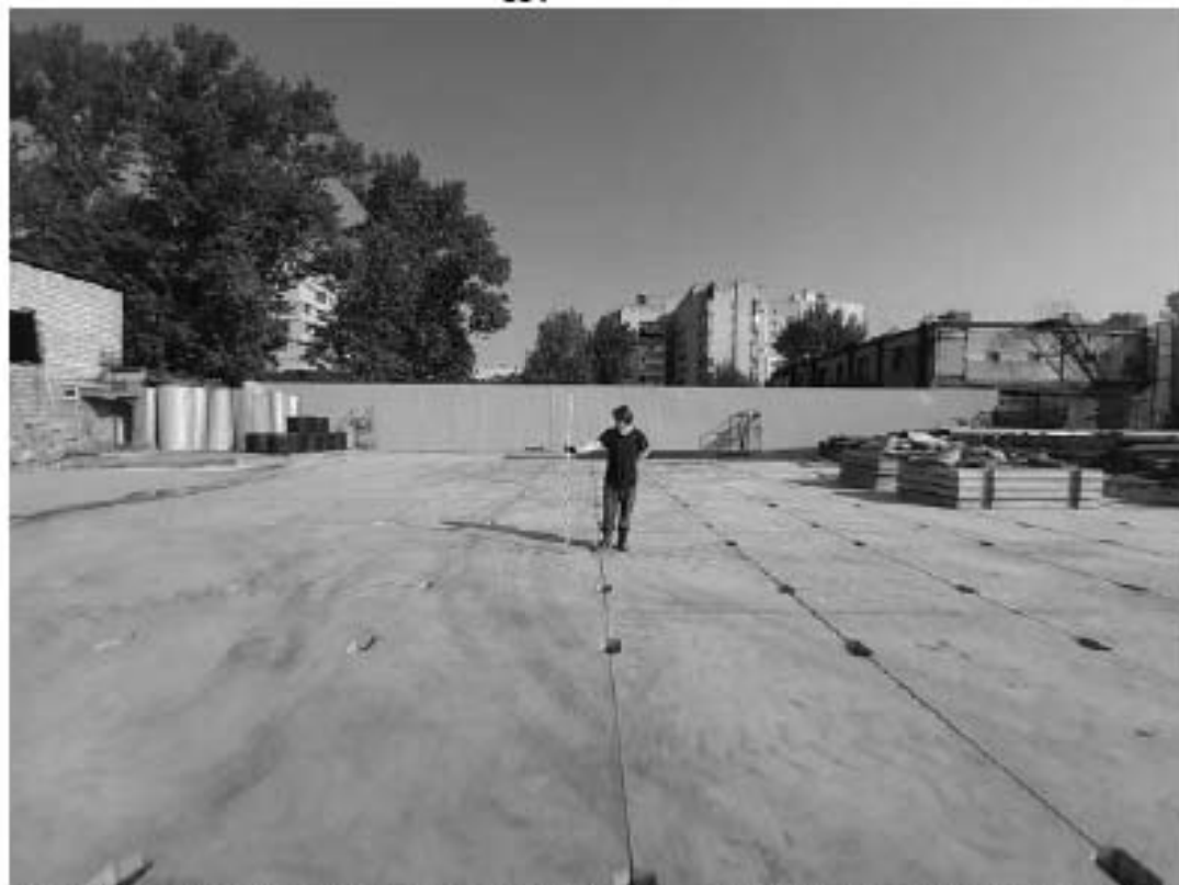
Рис. 281. Санкт-Петербург. «Строительство Красносельско-Калининской линии от станции «Казаконская» до станции «Обводный канал-2» с электродепо «Красносельское». Участок от станции «Путиловская» до станции «Каретная». Участок обследования «Строительная площадка шахты 852 по адресу: Фрунзенский район, западнее здания по адресу ул. Тамбовская, дом 17, литер Б». Общие виды.
