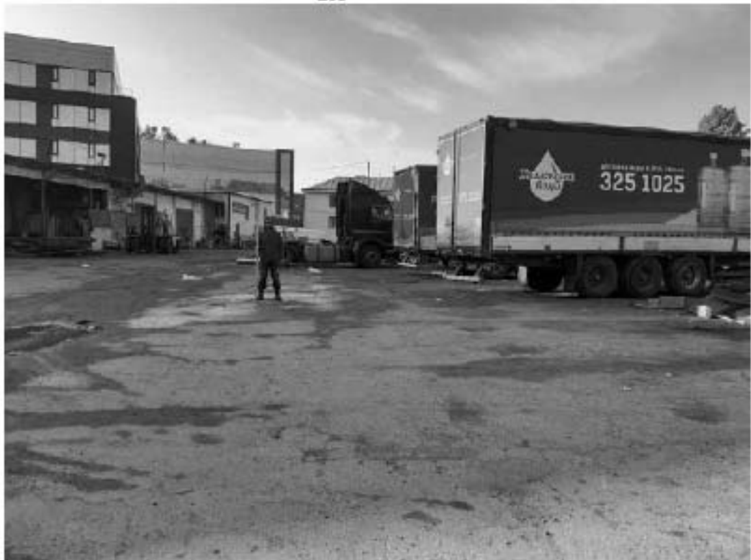
Рис. 92. Санкт-Петербург, «Строительство Красносельско-Калининской линии от станции «Казаковская» до станции «Обводный канал-2» с электродепо «Красносельское». Участок обследования «Строительная площадка шахты 847. Рабочий ствол». Общие виды.
