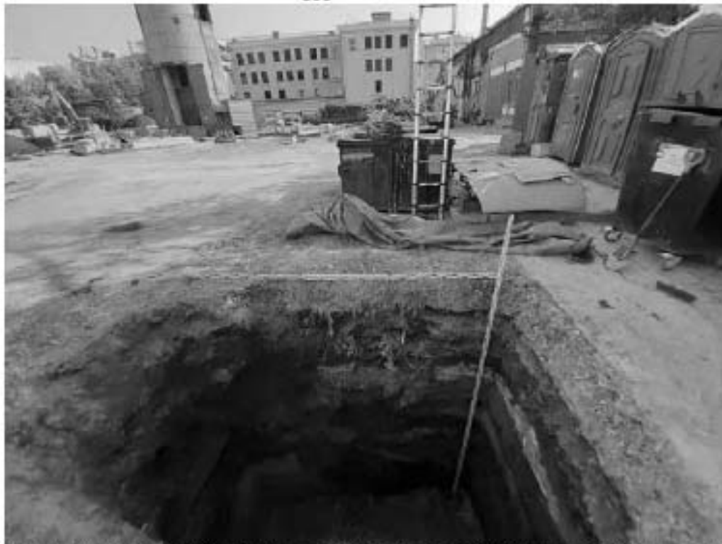
Рис. 299 Санкт-Петербург. «Строительство Красносельско-Калининской линии от станции «Казаковская» до станции «Обводный канал-2» с электродепо «Красносельское». Участок от станции «Путиловская» до станции «Каретная». Участок обследования «Строительная площадка шахты 852 по адресу: Фрунзенский район, западнее здания по адресу ул. Тамбовская, дом 17, литер Б». Шурф 1. Фотофиксация после окончания работ. Общий вид на юго-восток.
