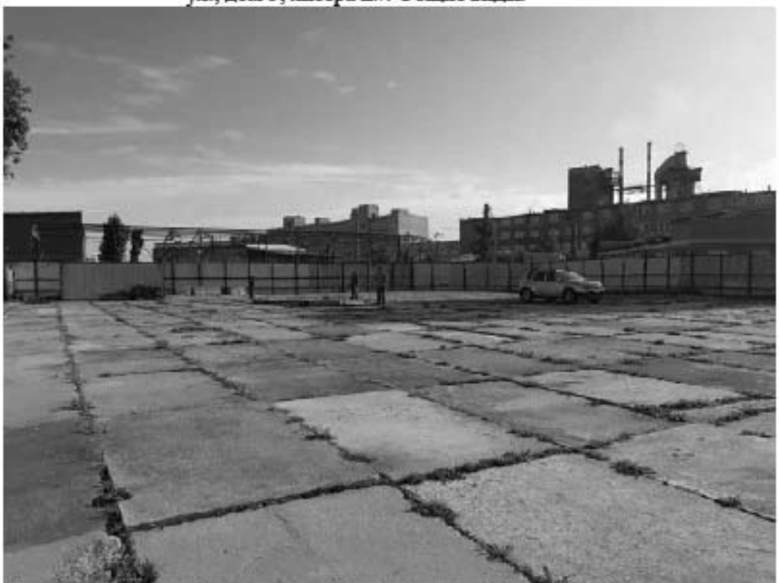
Рис. 173 Санкт-Петербург, «Строительство Красносельско-Калининской линии от станции «Казаковская» до станции «Обводный канал-2» с электродепо «Красносельское». Участок обследования «Строительная площадка шахты 849 по адресу: Московский район, Киевская ул., дом 5, литера Е». Общие виды.
