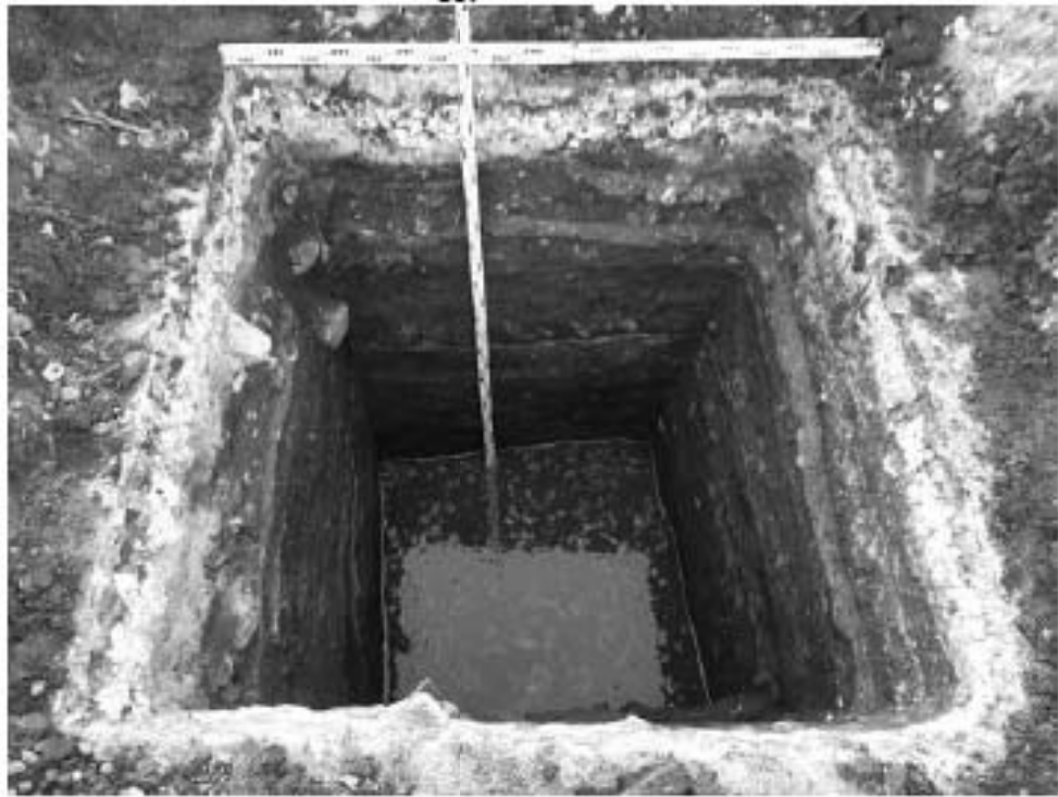
Рис. 210 Санкт-Петербург, «Строительство Красносельско-Калининской линии от станции «Казаковская» до станции «Обводный канал-2» с электродепо «Красносельское». Участок обследования «Строительная площадка вестибюля № 2 станции «Боровая». Строительная площадка шахты № 850 по адресу: Фрунзенский район, Лиговский проспект, дом 26, литера И». Шурф 1. Фотофиксация по темно-серому песку (материку) затопленному грунтовыми водами. Вид на северо-запад.
