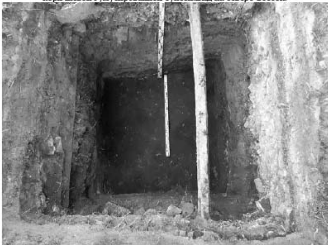
Рис. 260 Санкт-Петербург. «Строительство Красносельско-Калининской линии от станции «Казаконская» до станции «Обводный канал-2» с электродепо «Красносельское». Участок от станции «Путиловская» до станции «Каретная». Участок обследования «Строительная площадка вестибюля № 1 станции «Каретная». Шурф 1. Фотофиксация по слою темно-коричневой гумусированной супеси. Вид на северо-восток.
