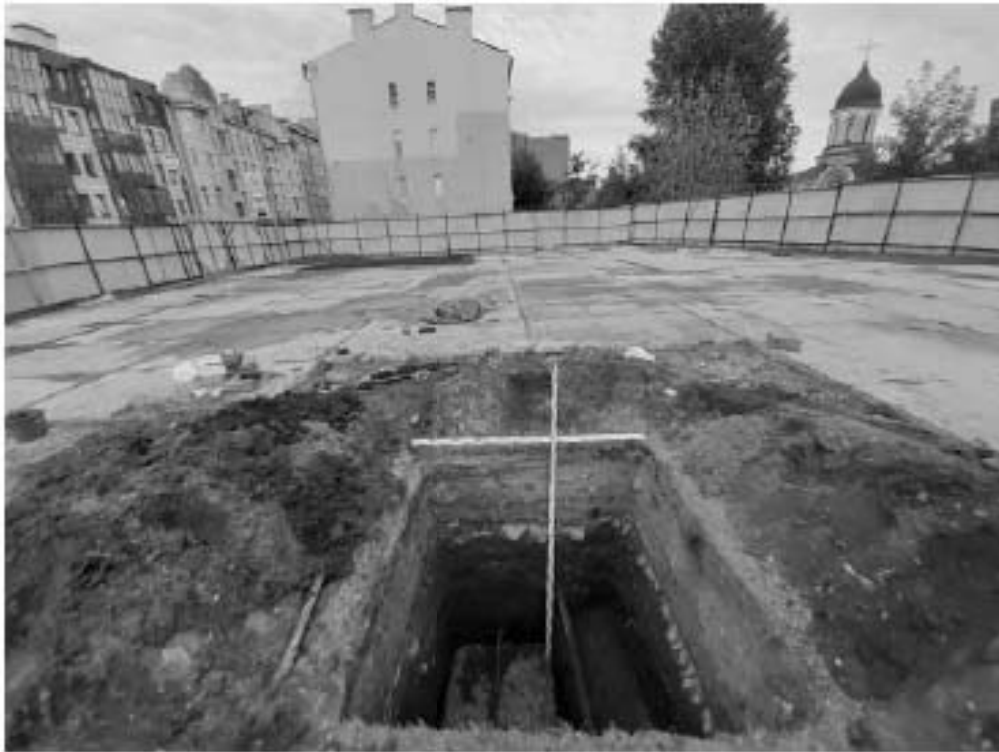
Рис. 236. Санкт-Петербург. «Строительство Красносельско-Калининской линии от станции «Казаковская» до станции «Обводный канал-2» с электродепо «Красносельское». Участок от станции «Путиловская» до станции «Каретная». Участок обследования «Строительная площадка шахты № 851 по адресу: Фрунзенский район, Расстанная улица на свободной территории между домами №7 и №13». Шурф 1. Фотофиксация после окончания работ. Общий вид на юго-восток.
