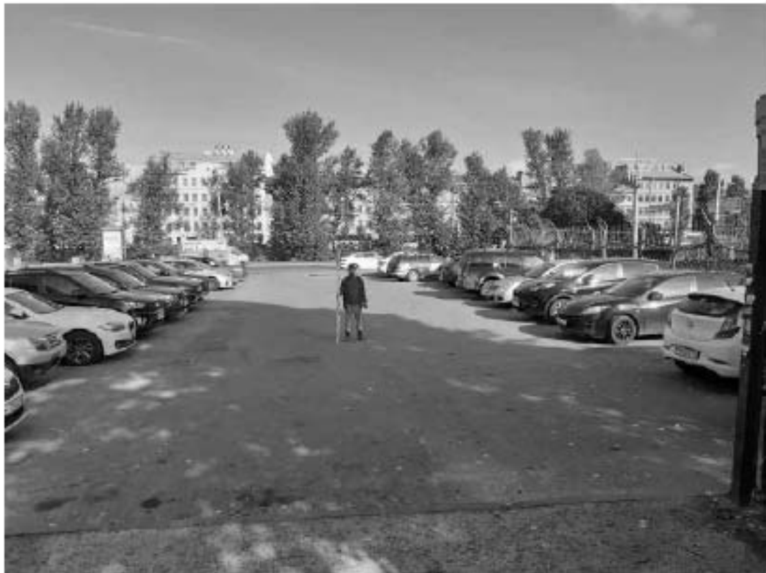
Рис. 247 Санкт-Петербург. «Строительство Красносельско-Калининской линии от станции «Казаковская» до станции «Обводный канал-2» с электродепо «Красносельское». Участок от станции «Путиловская» до станции «Каретная». Участок обследования «Строительная площадка вестибюля № 1 станции «Каретная». Общие виды.
