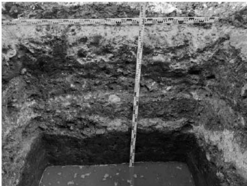
Рис. 181. Санкт-Петербург, «Строительство Красносельско-Калининской линии от станции «Казаковская» до станции «Обводный канал-2» с электродепо «Красносельское». Участок обследования «Строительная площадка шахты 849 по адресу: Московский район, Киевская ул., дом 5, литера Е». Шурф 1. Фотофиксация стратиграфии северо-западной стенки.
