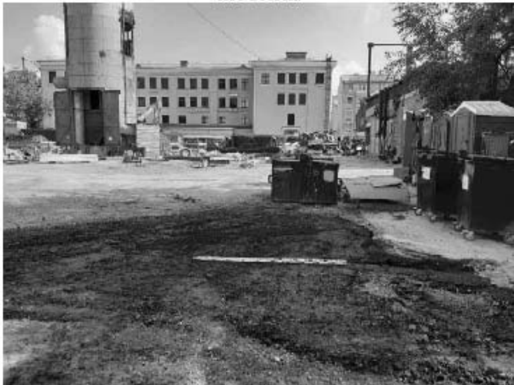
Рис. 300. Санкт-Петербург. «Строительство Красносельско-Калининской линии от станции «Казаковская» до станции «Обводный канал-2» с электродепо «Красносельское». Участок от станции «Путиловская» до станции «Каретная». Участок обследования «Строительная площадка шахты 852 по адресу: Фрунзенский район, западнее здания по адресу ул. Тамбовская, дом 17, литер Б». Шурф 1. Фотофиксация после рекультивации Вид на юго-восток.
