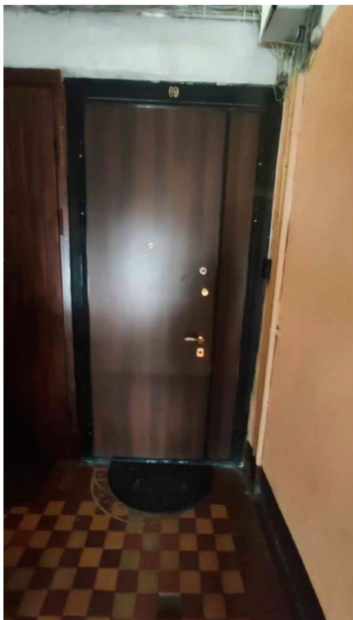
4. Дверное заполнение со стороны парадной лестницы кв. №69 в уровне 5-го этажа выявленного объекта культурного наследия «Дом Б.Е. Фурмана», расположенного по адресу: г. Санкт-Петербург, ул. Смольячкова, д. 15-17, литера А. 22.03.2022.
