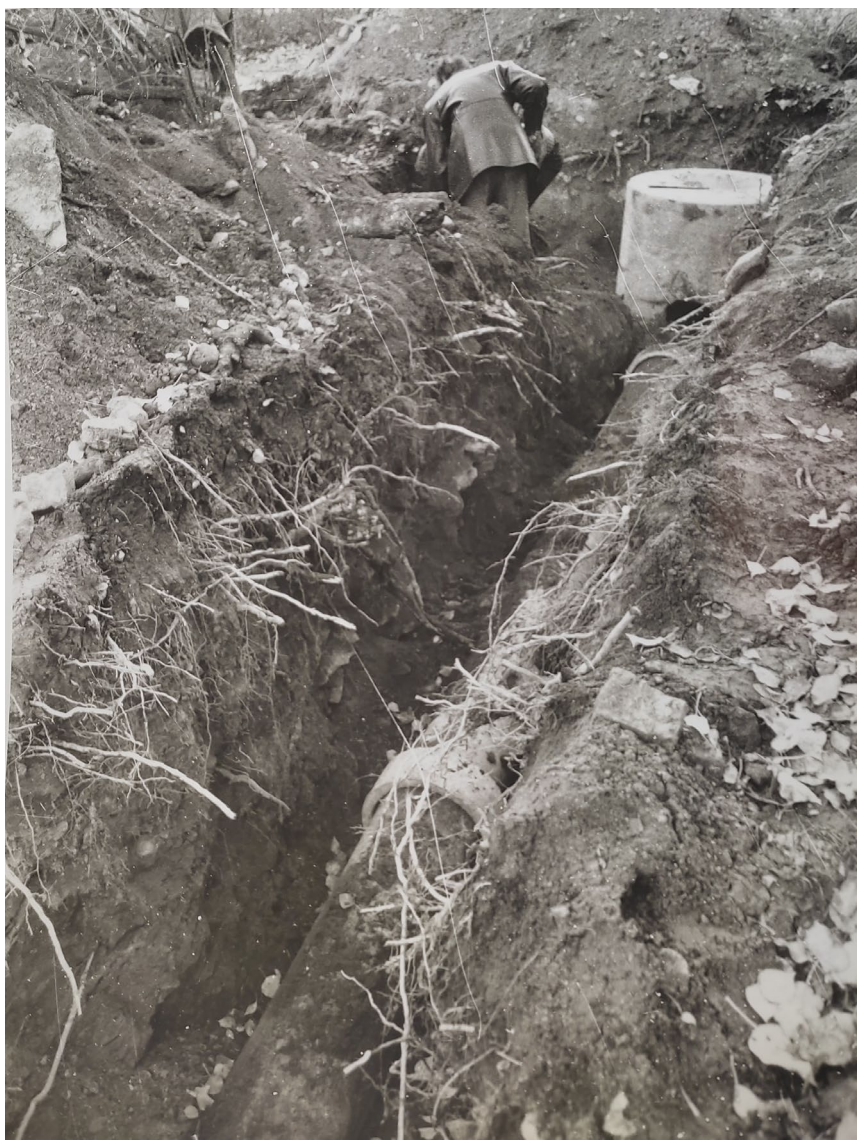
Илл. 96. Археологические работы на площади Тургенева. Прокладка траншеи и устройство дренажа на месте, где стояла Покровская церковь. Фото В. Ф. Егоровский. Октябрь 1996 // Фототека отдела охраны памятников № 941/8-Н
