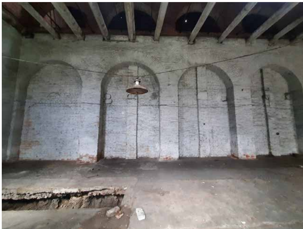
Фото 11 Интерьер объекта культурного наследия федерального значения «Сарай (магазин) пенькового канатного завода» (система кирпичных столбов и арок)
