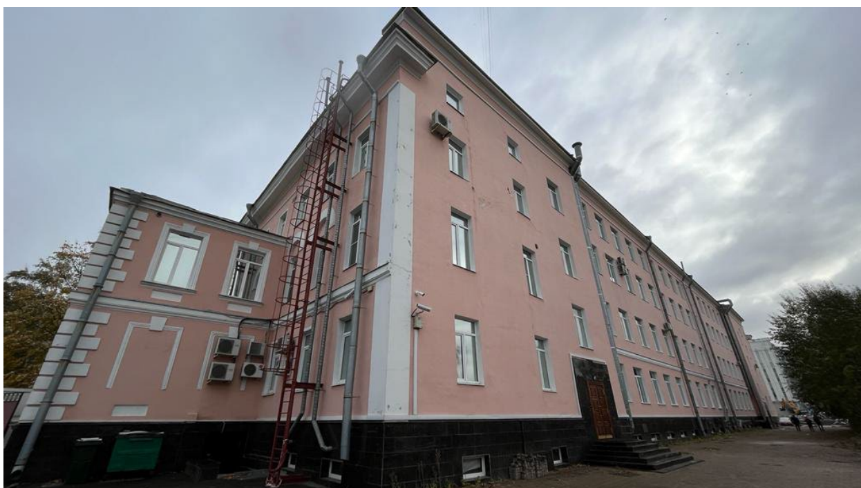
6. Вид на дворовый юго-западный фасад выявленного объекта культурного наследия «Комплекс построек «Невского железодельного, механического и корабельного завода» («Невского железопрокатного завода» П.Ф. Семянникова и В.А. Полетики). Заводоуправление», расположенного по адресу: г. Санкт-Петербург, пр. Обуховской Обороны, д. 51, литеры АФ. 18.10.2023
