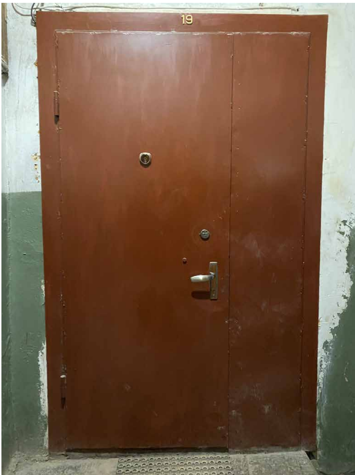
Фото 16. Вид на входную дверь в квартиру № 19 объекта культурного наследия.
