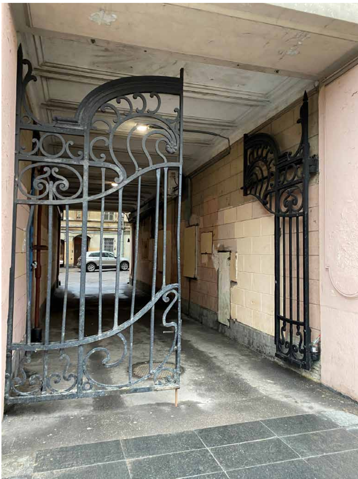
Фото 7. Вид на воротное заполнение арочного проезда, расположенного с улицы Марта, объекта культурного наследия.
