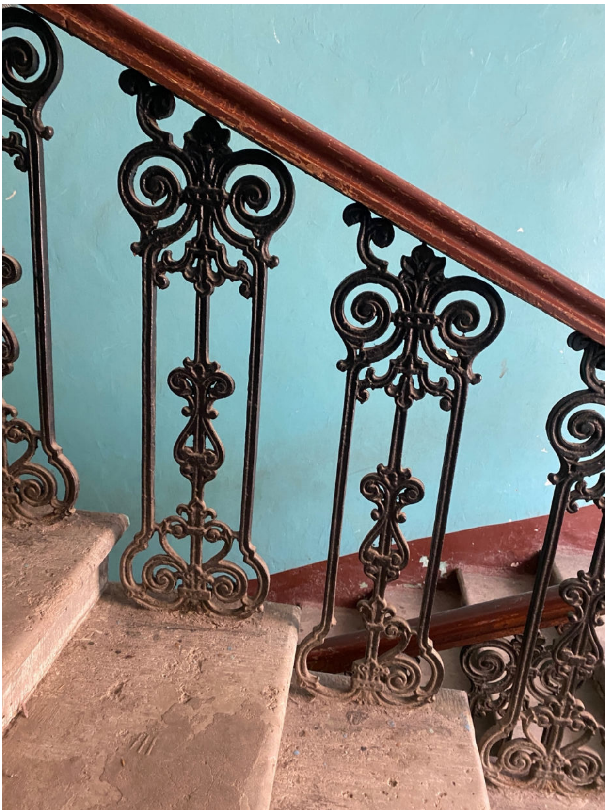
Фото 32. Вид на ограждение лестницы, ведущей в квартиру № 45, объекта культурного наследия.
