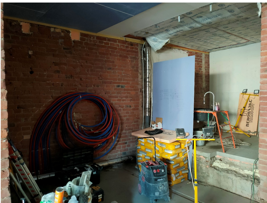
6. «Дом А.И.Семеновой», Санкт-Петербург, Рыбацкая ул., д.10, литера А. Помещение №1-Н. Общий вид. Фото 26.05.2023г.
