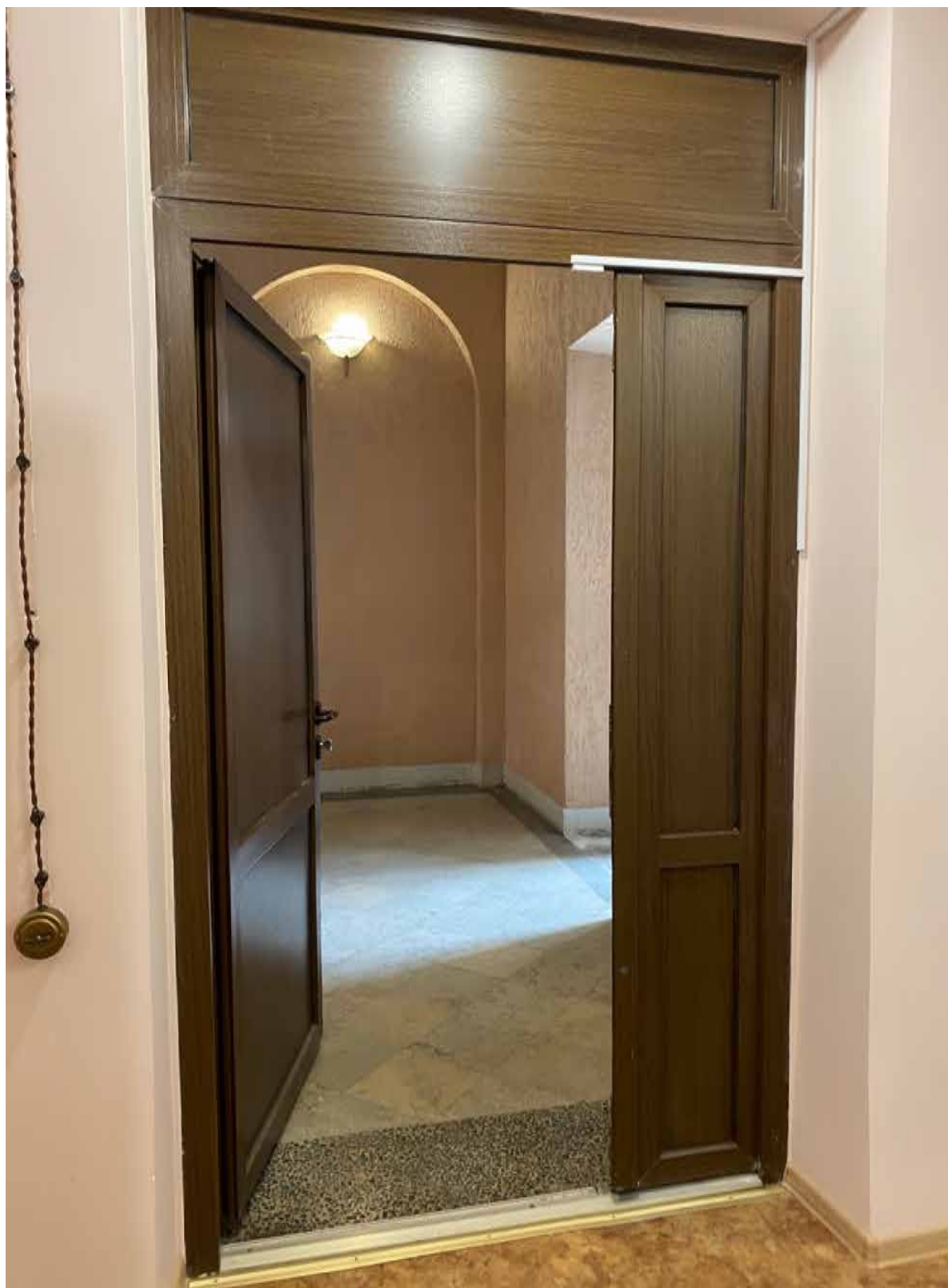
40. Интерьер объекта культурного наследия в уровне 2-го этажа – помещение 8Н(17). Автор фото: Штиглиц М.С. Дата: 17.04.2023 г.
