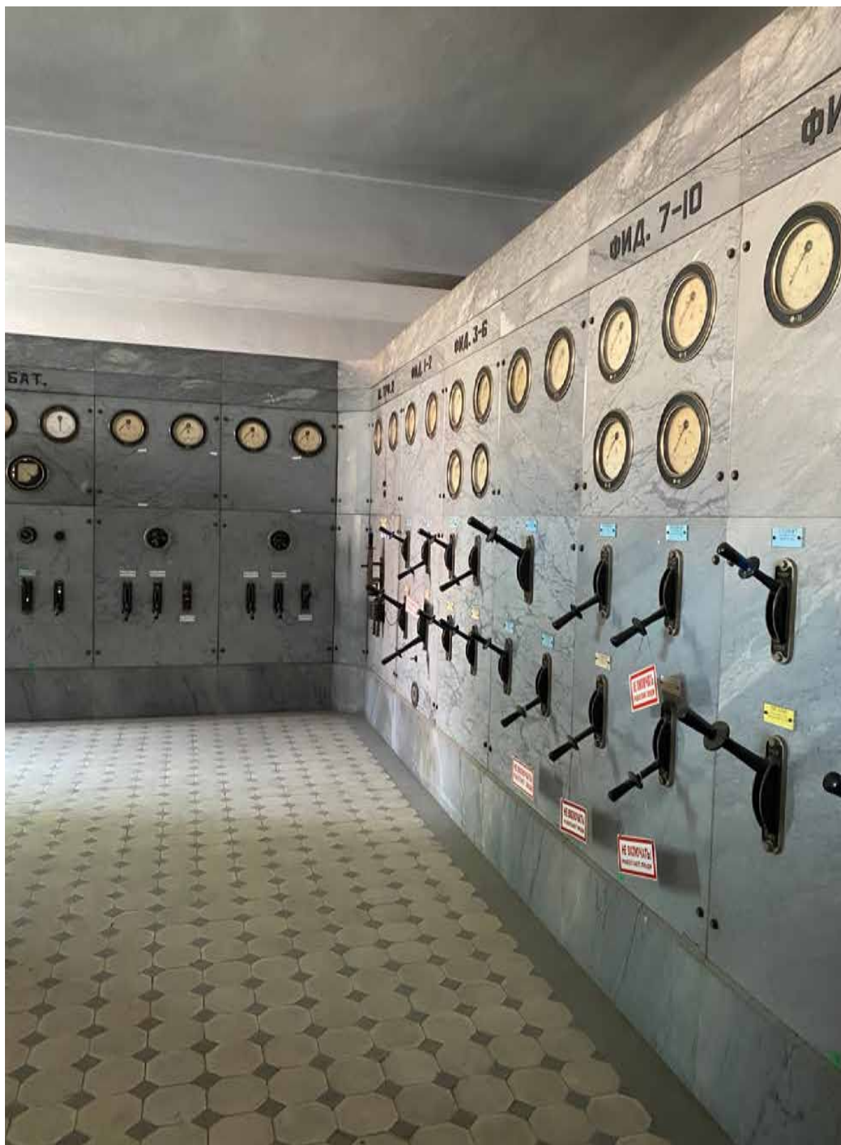
64. Интерьер объекта культурного наследия в уровне 2-го этажа - — помещение 4Н(46). Автор фото: Штиглиц М.С. Дата: 17.04.2023 г.
