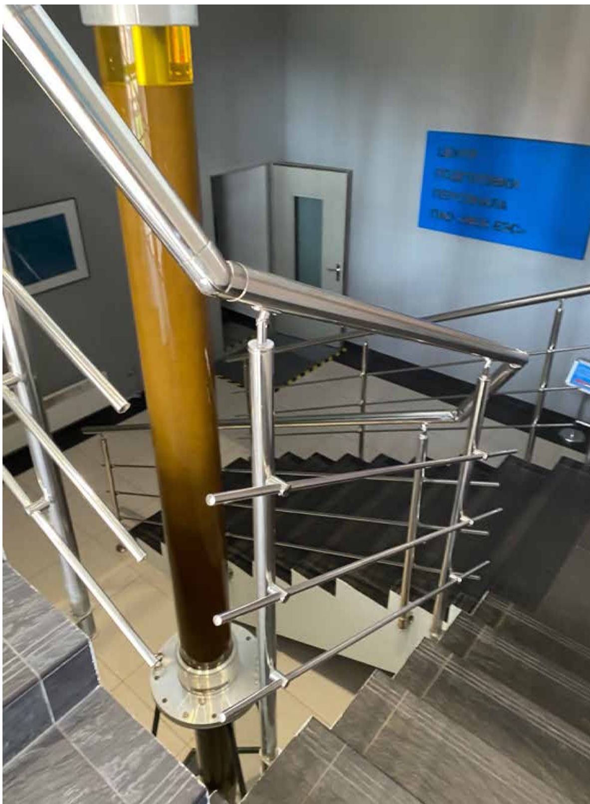
78. Лестница объекта культурного наследия в уровне 1-го этажа – помещение ЗН(22). Автор фото: Штиглиц М.С. Дата: 17.04.2023 г.
