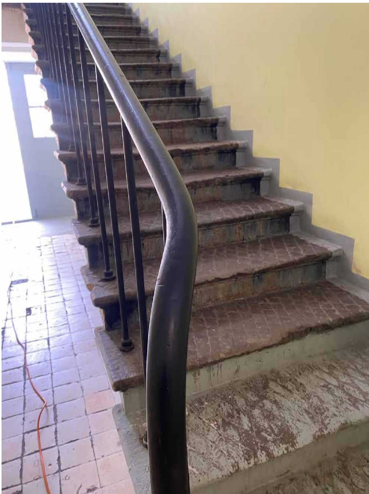
100. Лестница объекта культурного наследия в уровне 1-го этажа. Автор фото: Штиглиц М.С. Дата: 17.04.2023 г.
