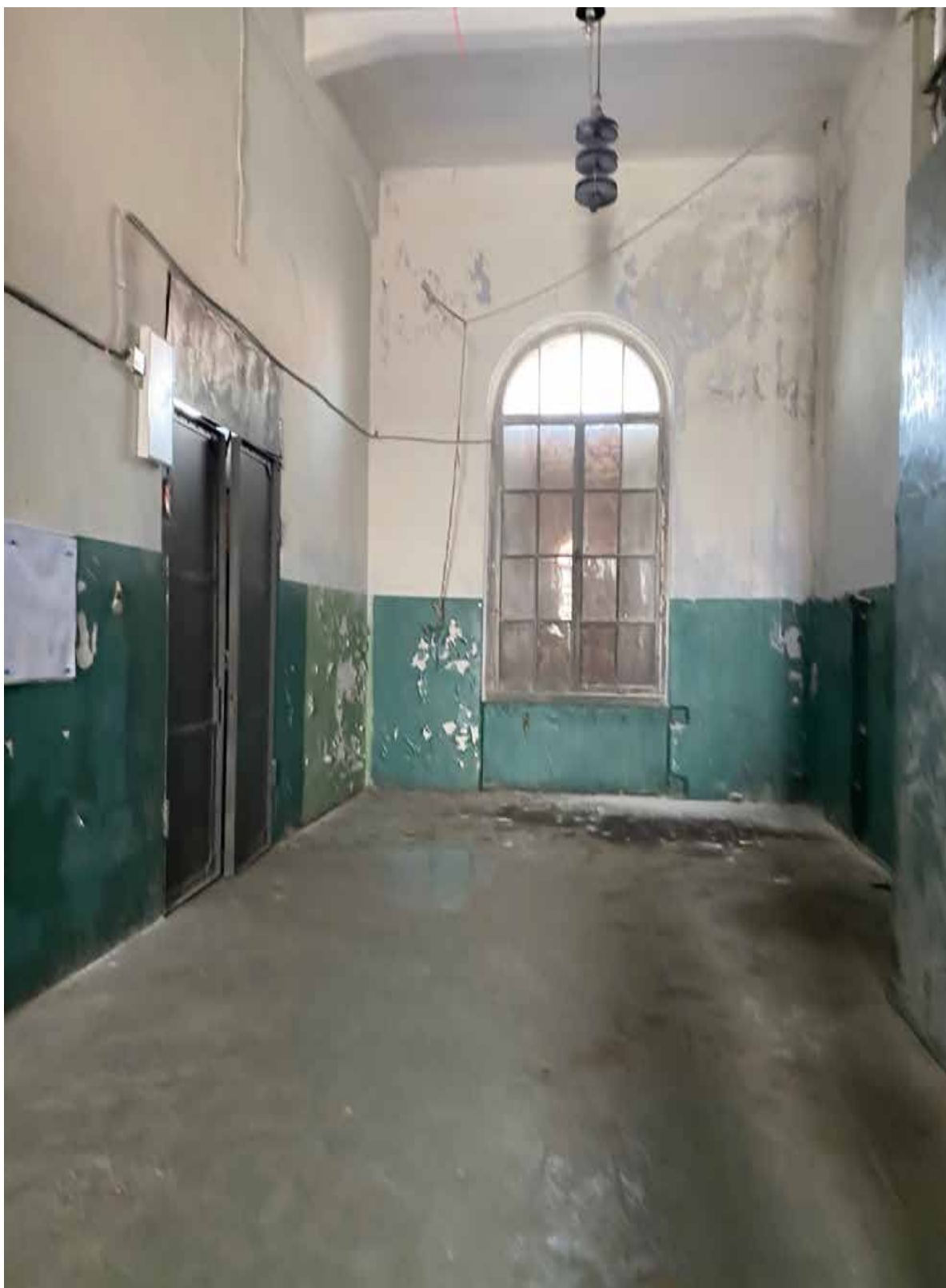
60. Интерьер объекта культурного наследия в уровне 2-го этажа – помещение 4Н(32). Автор фото: Штиглиц М.С. Дата: 17.04.2023 г.
