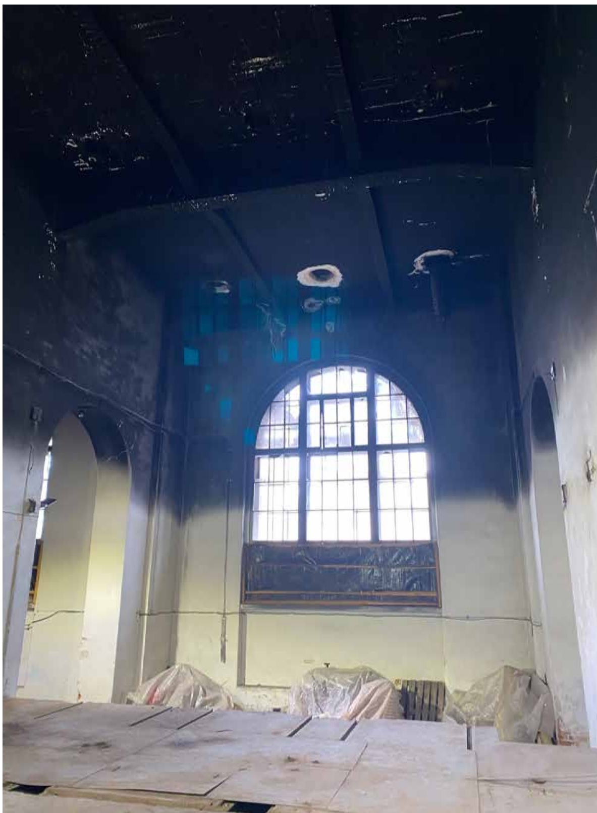
89. Интерьер объекта культурного наследия в уровне 1-го этажа. – помещение ЗН(4). Автор фото: Штиглиц М.С. Дата: 17.04.2023 г.
