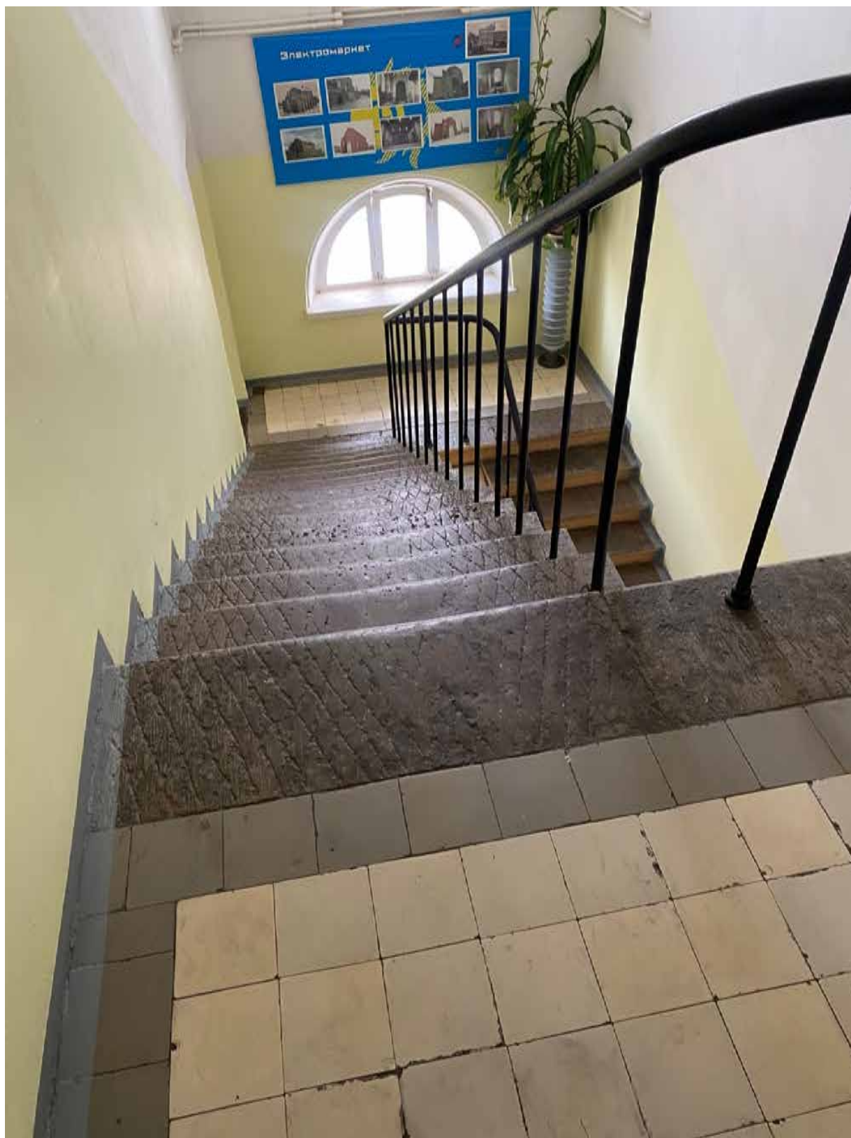
106. Лестница объекта культурного наследия в уровне 2-го этажа. Автор фото: Штиглиц М.С. Дата: 17.04.2023 г.
