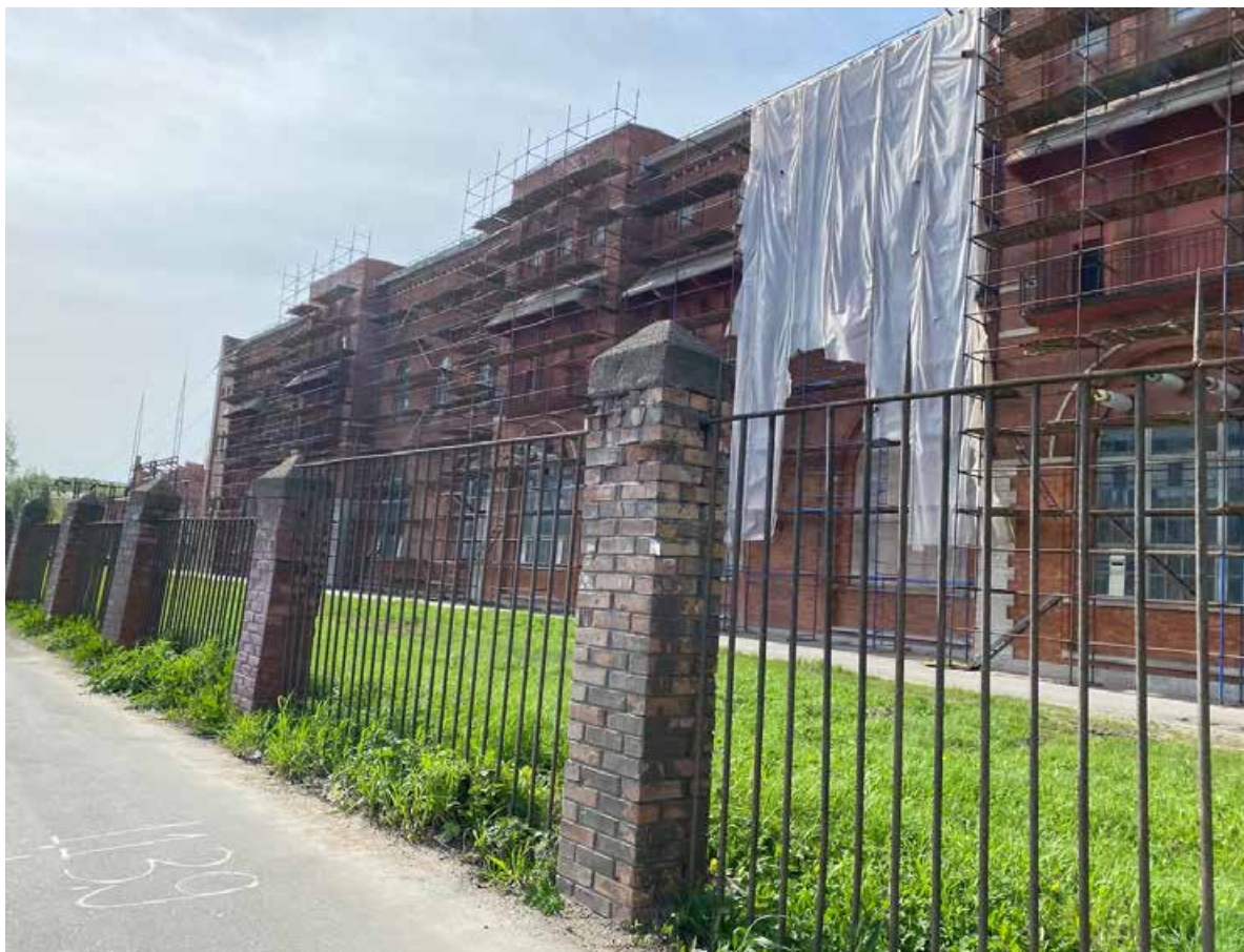
24. Фрагмент лицевого фасада по Полюстровскому проспекту объекта культурного наследия. Автор фото: Штиглиц М.С. Дата: 17.04.2023 г.
