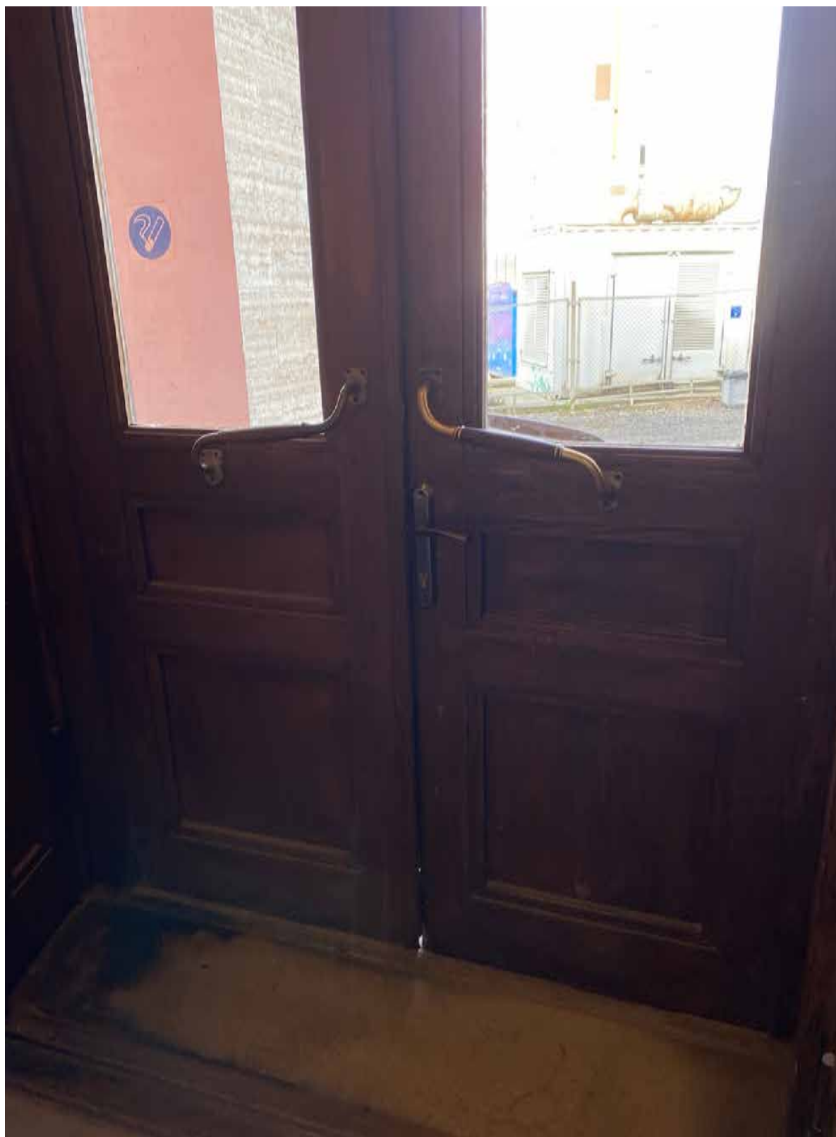
27. Дверное заполнение объекта культурного наследия в уровне 1-го этажа – помещение 4-Н(1). Автор фото: Штиглиц М.С. Дата: 17.04.2023 г.
