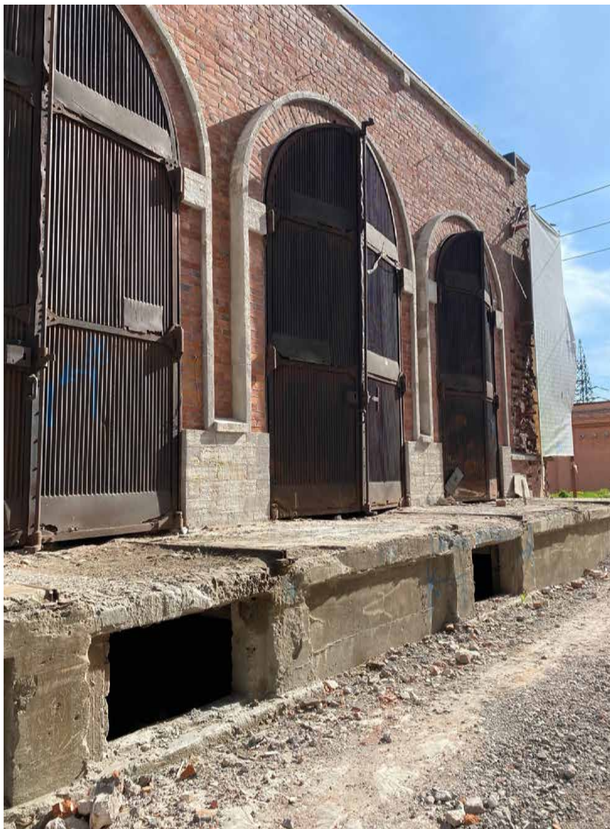
9. Фрагмент южного торцевого фасада объекта культурного наследия. Автор фото: Штиглиц М.С. Дата: 17.04.2023 г.
