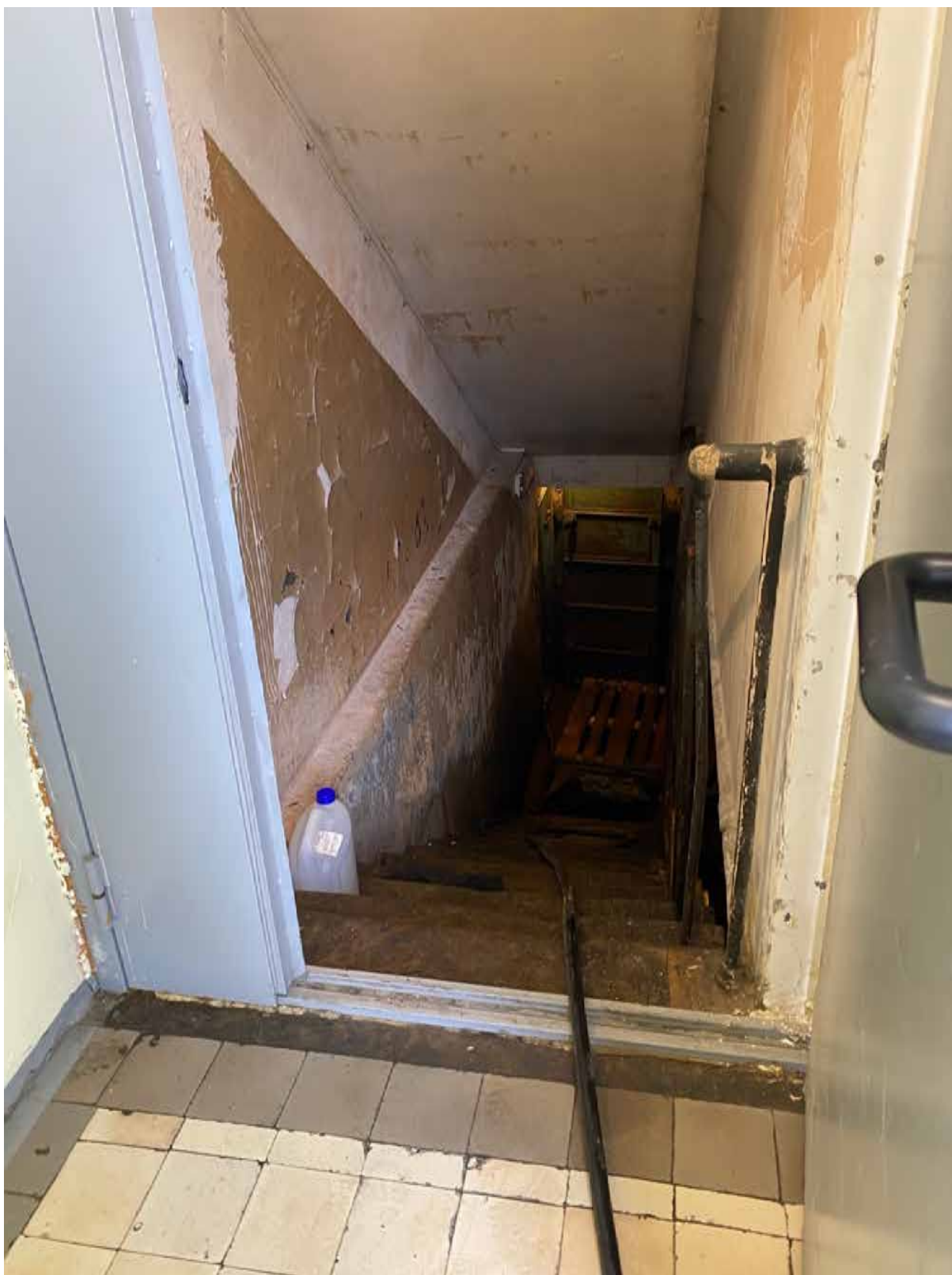
113. Интерьер подвала объекта культурного наследия в уровне подвального этажа. Автор фото: Штиглиц М.С. Дата: 17.04.2023 г.
