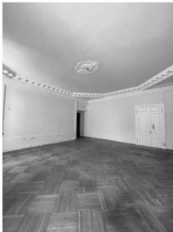
55. Здание по адресу: Санкт-Петербург, Моховая улица, д. 10, строение 1. Помещение с лепными элементами отделки на втором этаже. Фрагмент. Пом. 30-Н
