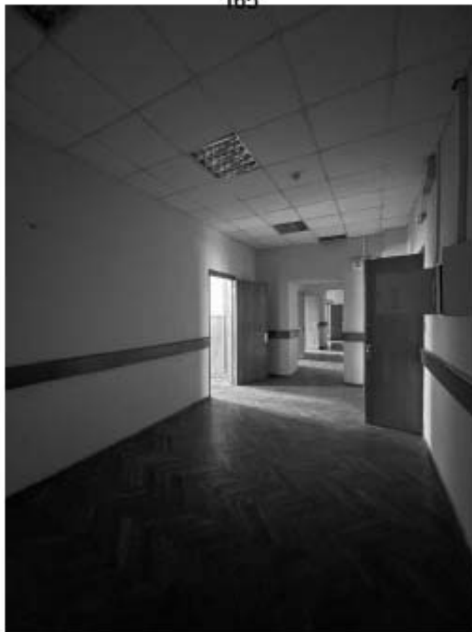
64. Здание по адресу: Санкт-Петербург, Моховая улица, д. 10, строение 1. Коридор 3 этажа. Пом. МОП 1
