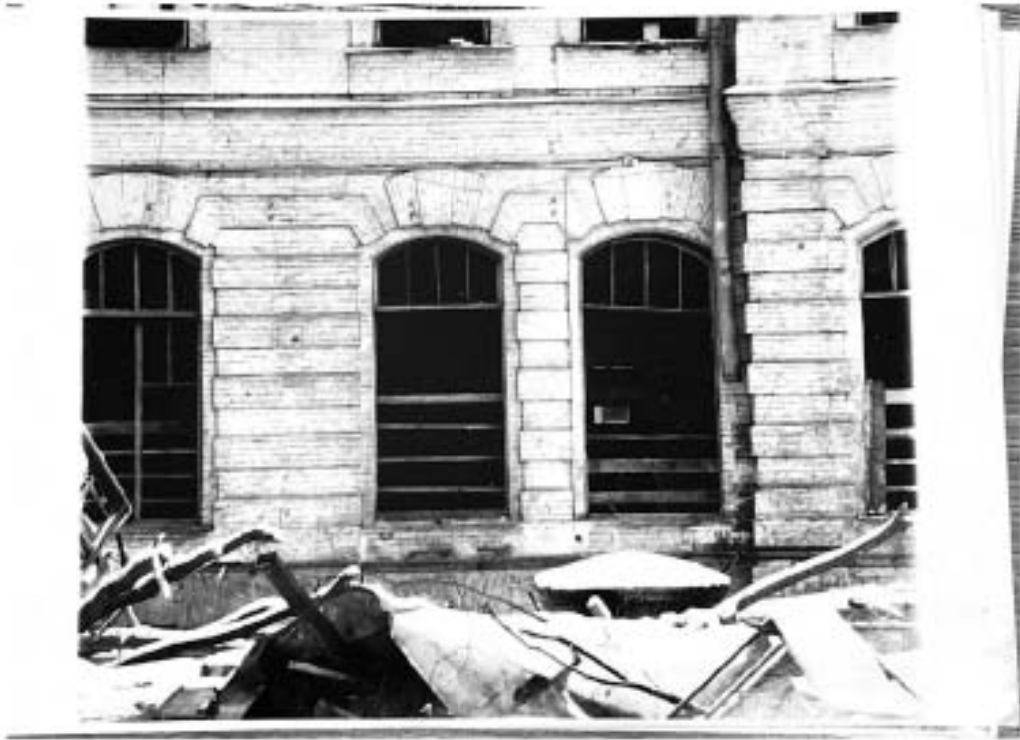
61. Лицевой корпус, дворовой фасад, фрагмент окна 2 этажа. Фотофиксация в процессе реставрации. 1990–1991. ЦГАНТД СПб. Ф. Р-488. Оп. 314. Д. 161. Л. 1/8
