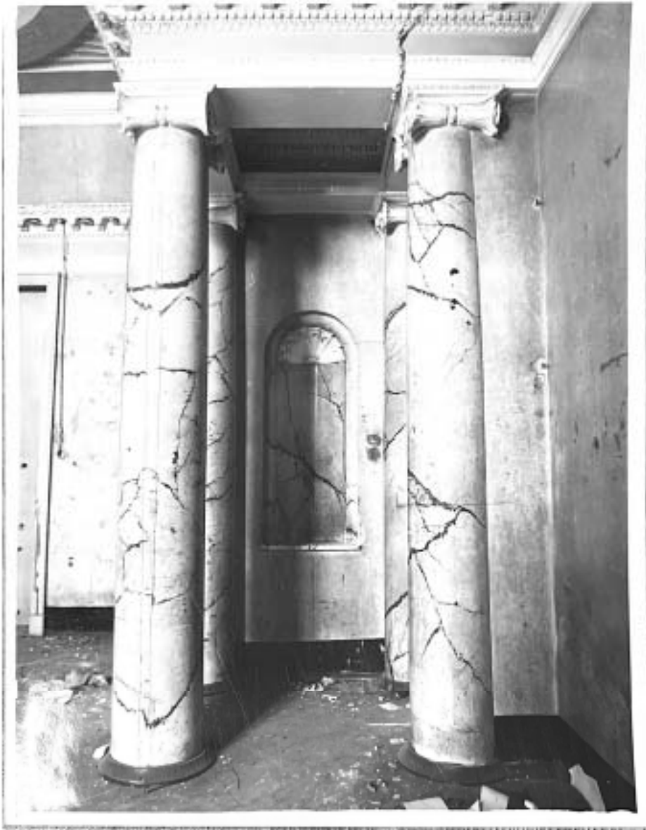
51. Лицевой флигель, главный фасад, 1 этаж, пом. №3, восточная стена. Фотофиксация интерьеров до реставрации. 1990–1991. ЦГАНТД СПб. Фонд Р-488. Опись 314. Дело 162. Л. 4/14
