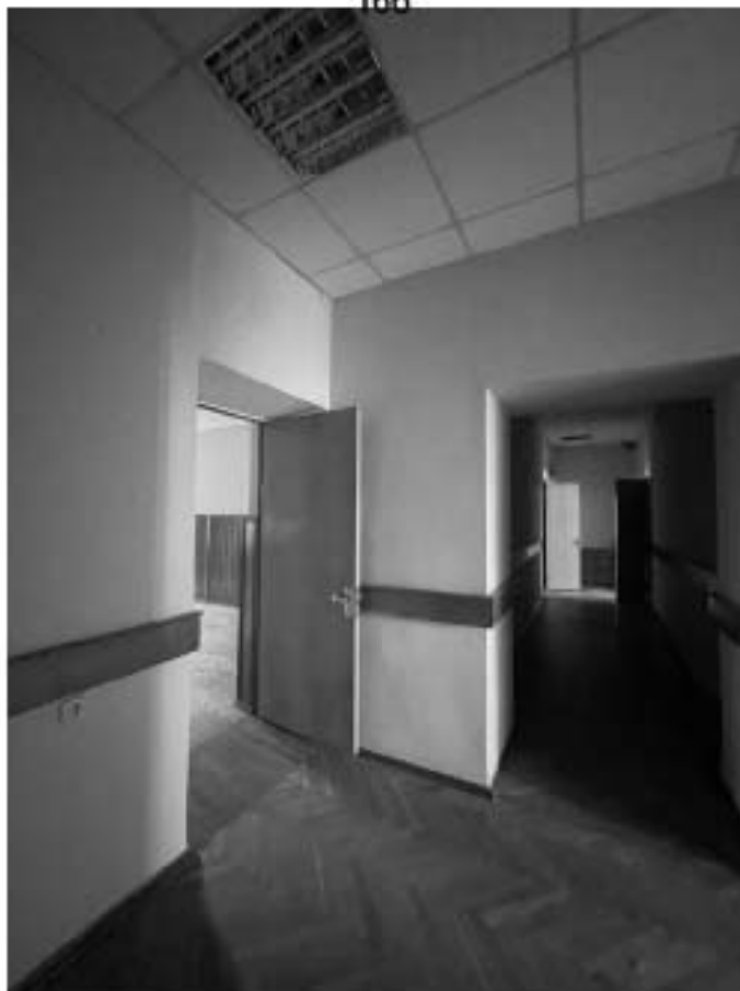
66. Здание по адресу: Санкт-Петербург, Моховая улица, д. 10, строение 1. Вид помещений МОП1 и 43-Н
