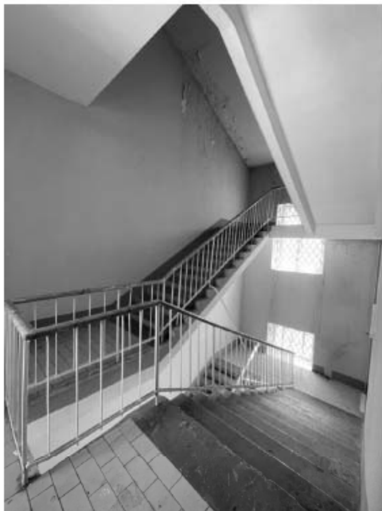
87. Здание по адресу: Санкт-Петербург, Моховая улица, д. 10, строение 1. Межлестничное пространство в уровне 3 этажа. Пом. МОП
