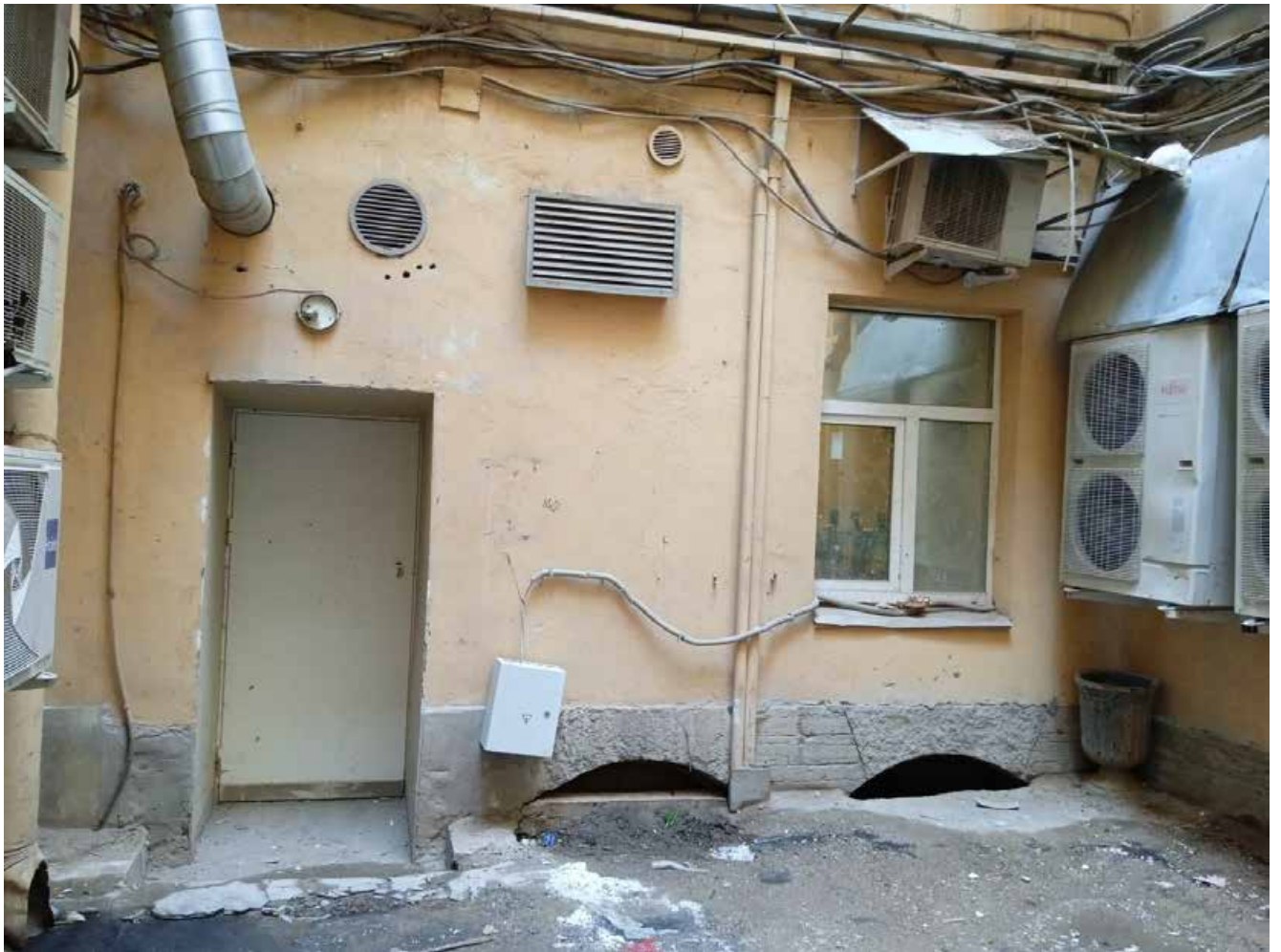
19. Западный дворовой фасад (фрагмент) здания по адресу: Санкт-Петербург, ул. Малая Конюшенная, д. 16/26, литера А
