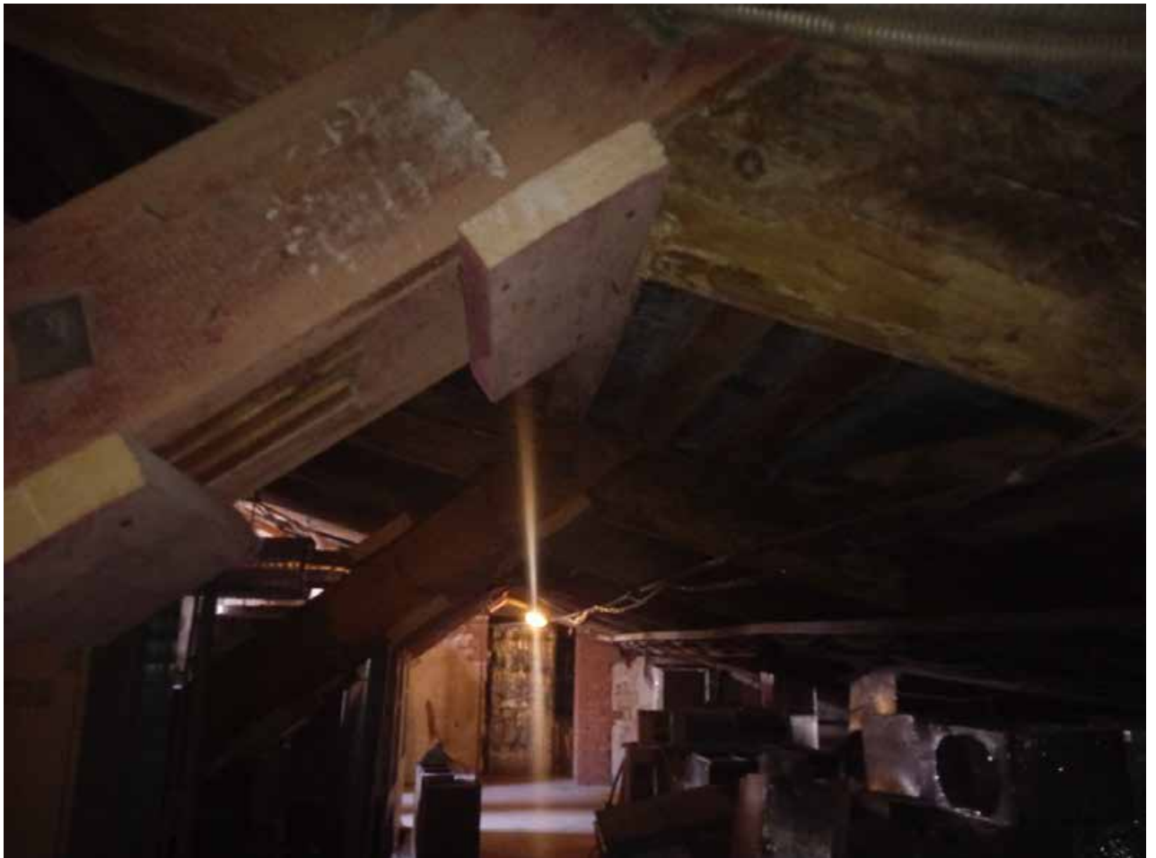
39. Здание по адресу: Санкт-Петербург, ул. Малая Конюшенная, д. 16/26, литера А. Общий вид пространства чердака с севера на юг.
