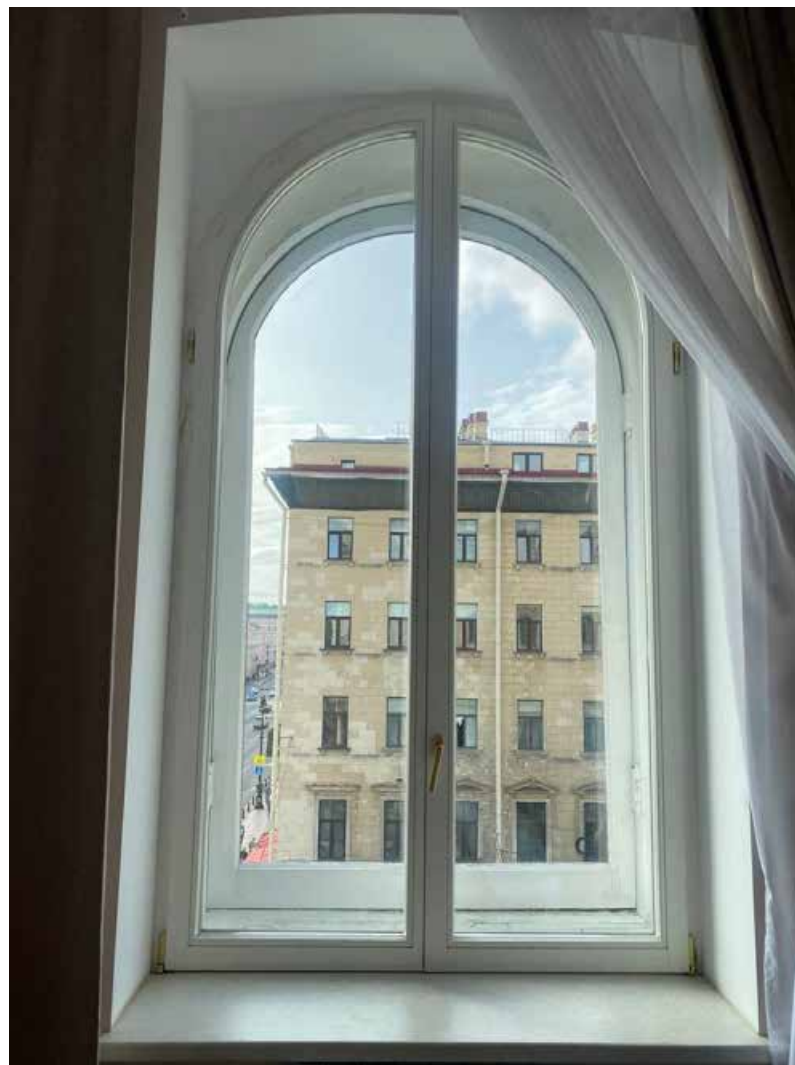
30. Здание по адресу: Санкт-Петербург, ул. Малая Конюшенная, д. 16/26, литера А. Окно четвертого этажа.
