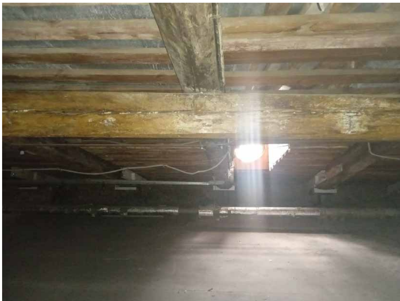
46. Здание по адресу: Санкт-Петербург, ул. Малая Конюшенная, д. 16/26, литера А. Стропильные конструкции.
