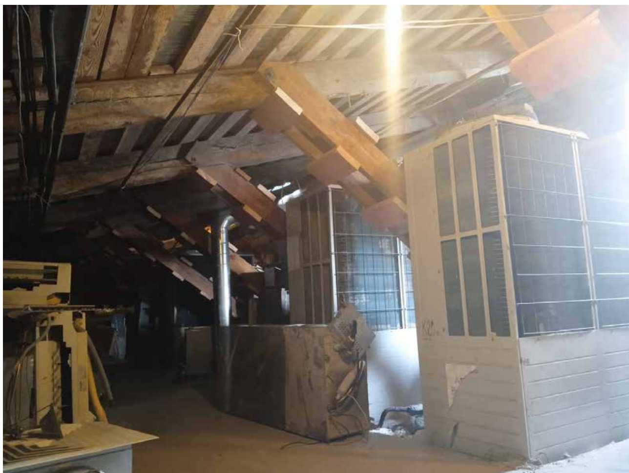
40. Здание по адресу: Санкт-Петербург, ул. Малая Конюшенная, д. 16/26, литера А. Стропильные конструкции.
