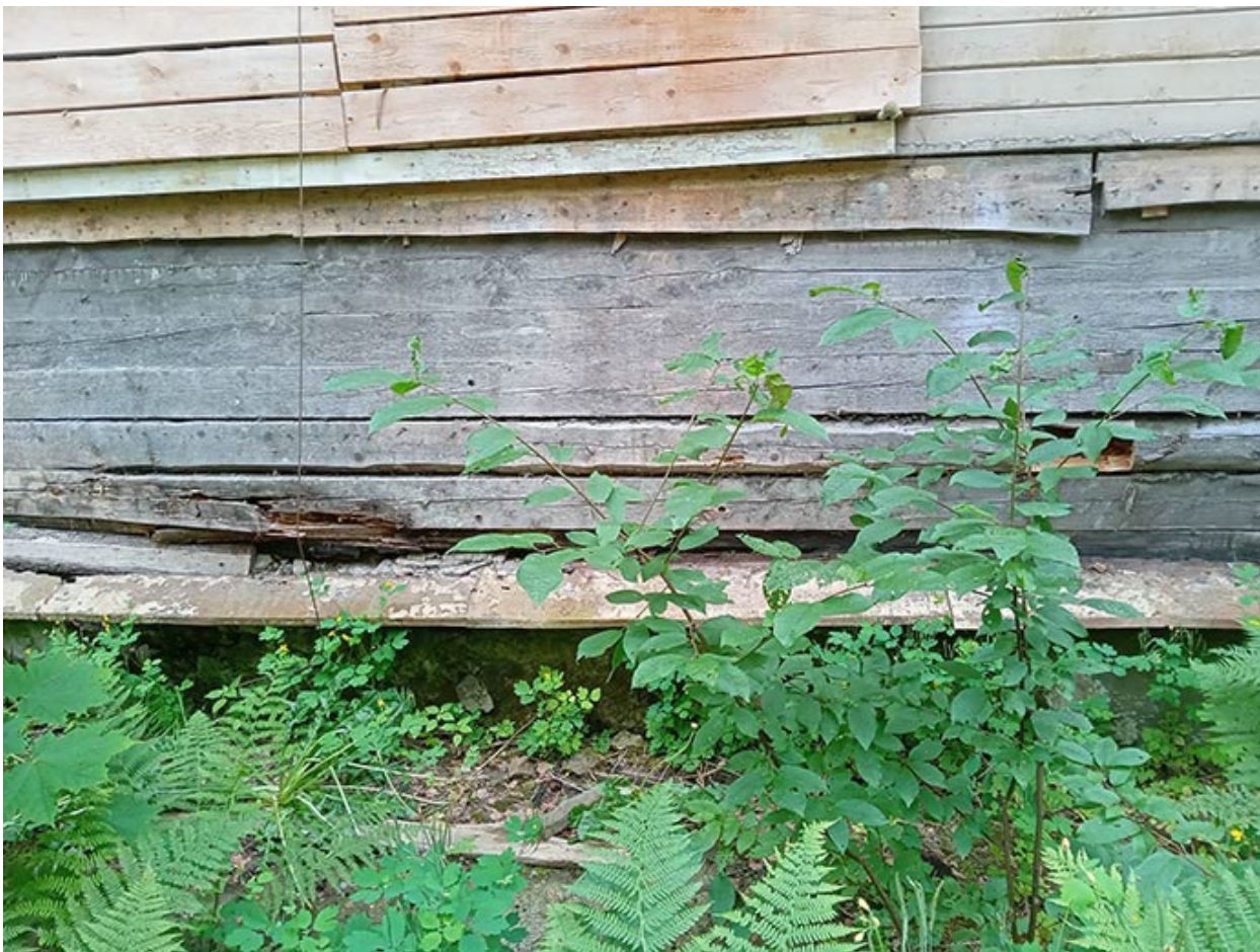
Фото 8. Выявленный объект культурного наследия «Дом купца Елисеева (ресторан) (деревянный)» по адресу: Санкт-Петербург, г. Зеленогорск Приморское шоссе, д. 520 литера Ц.
