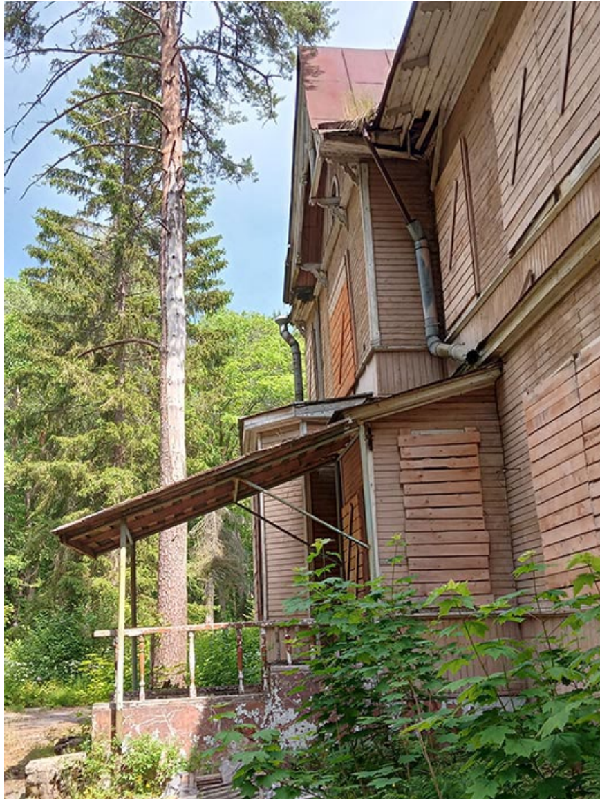
Фото 7. Выявленный объект культурного наследия «Дом купца Елисеева (ресторан) (деревянный)» по адресу: Санкт-Петербург, г. Зеленогорск Приморское шоссе, д. 520 литера Ц.
