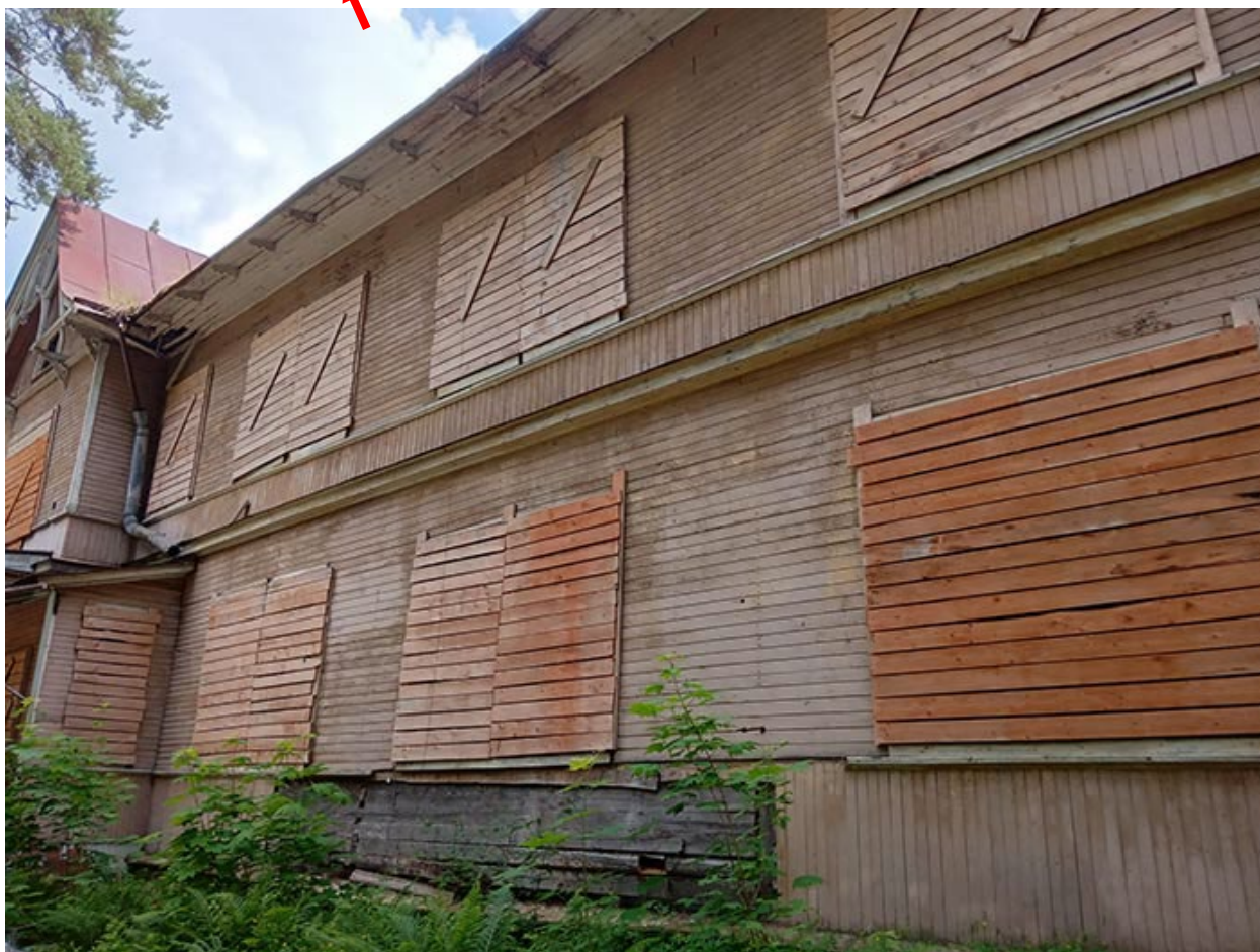
Фото 6. Выявленный объект культурного наследия «Дом купца Елисеева (ресторан) (деревянный)» по адресу: Санкт-Петербург, г. Зеленогорск Приморское шоссе, д. 520 литера Ц.
