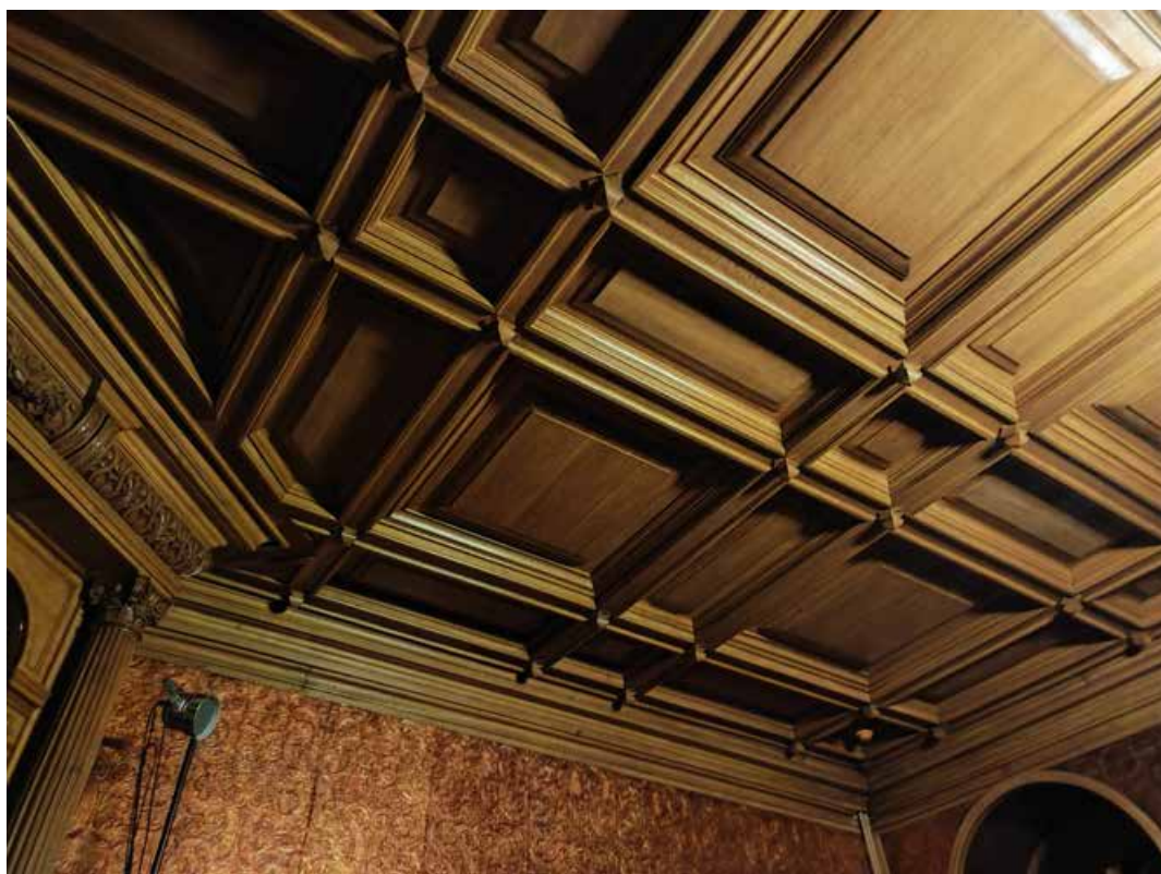
15. Вид западной стены пом. № 17 на 1-м этаже лицевого корпуса по Английской наб.
