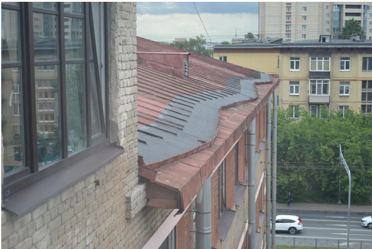
Фото 31. Общий вид на системы водоотведения секции №1 Общежития №6. Вид с северо-востока.
