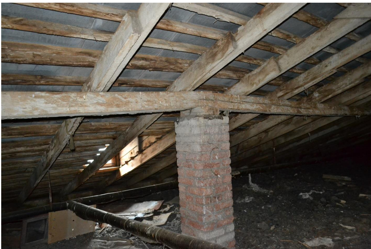
Фото 24. Прогиб прогона секции №1 чердачного пространства Общежития №6. Вид с юго-востока.
