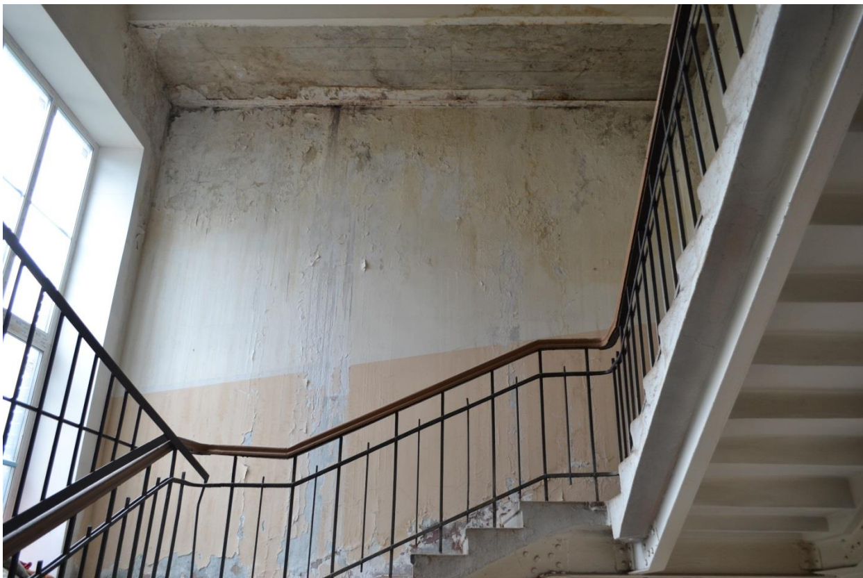
Фото 41. Следы протечек в уровне 5-го этажа на лестничной клетке пом. 17. Общежития №6. Секция №4. Вид с юго-запада.
