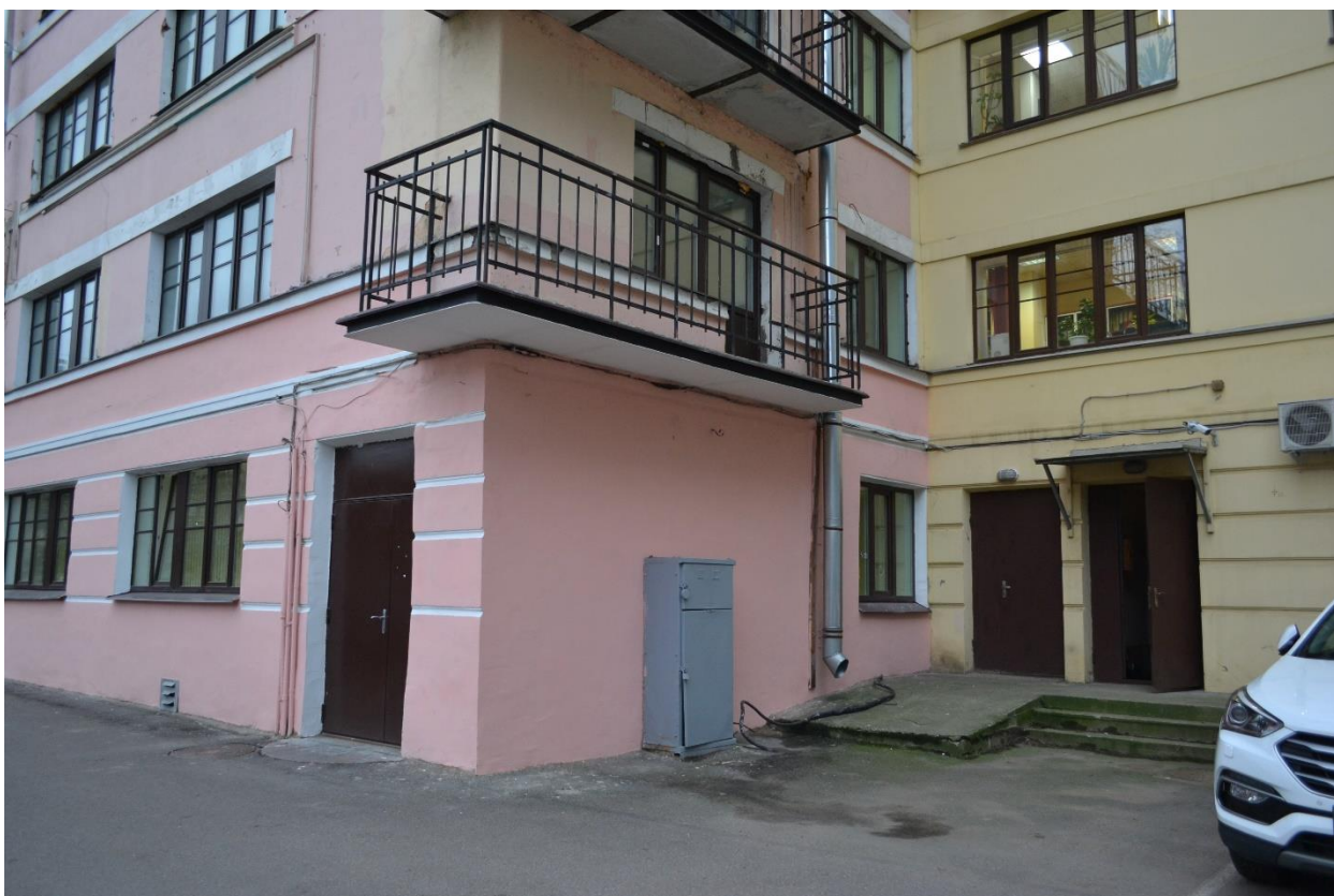
Фото 22. Исторические балконы с металлическим ограждением в виде стоек на дворовом фасаде Общежития №1 («Жилой корпус»). Секция №3. Вид северо-востока.
