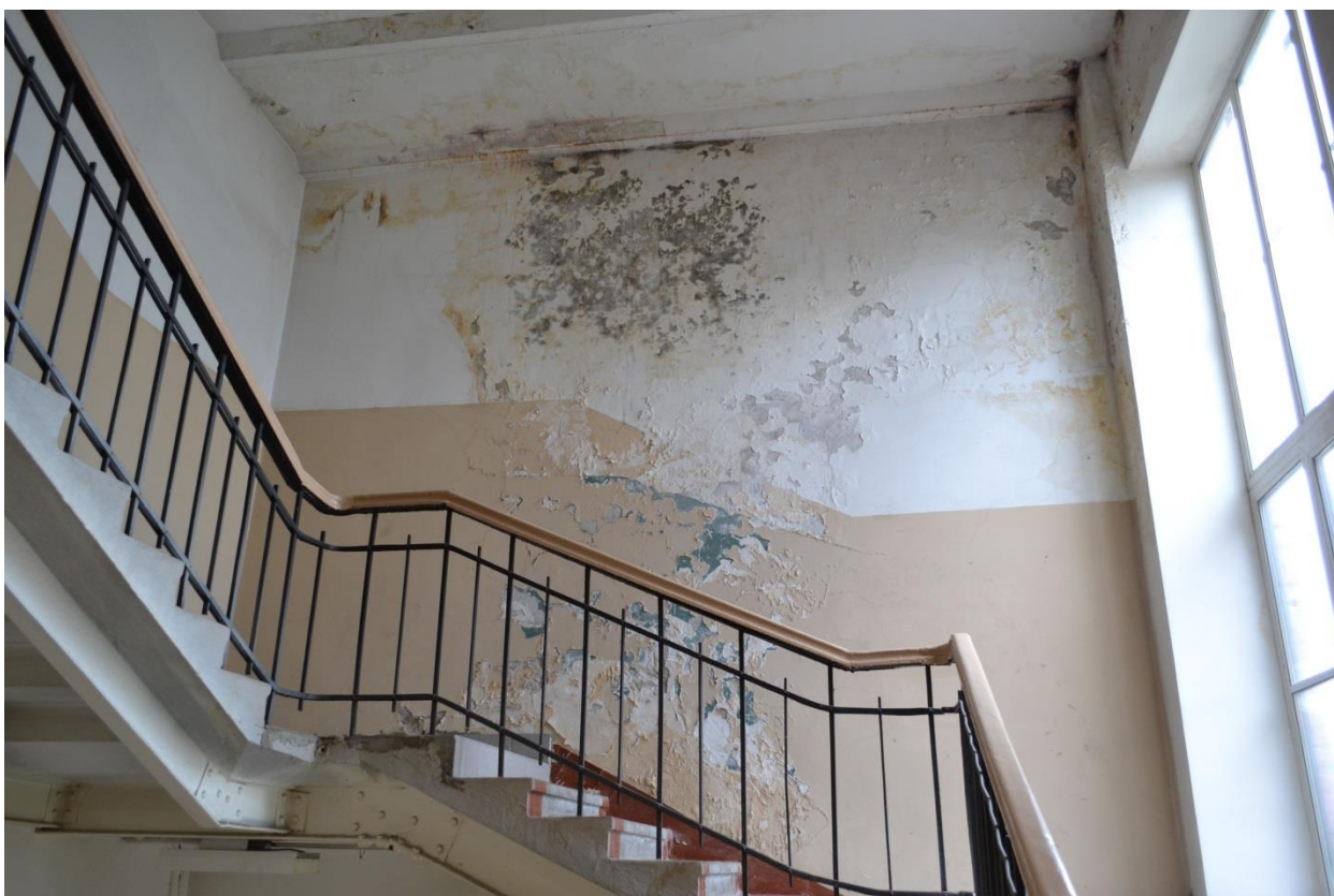
Фото 32. Следы протечек в уровне 5-го этажа на лестничной клетке пом. 21. Общежития №6. Секция №2. Вид с юго-востока.
