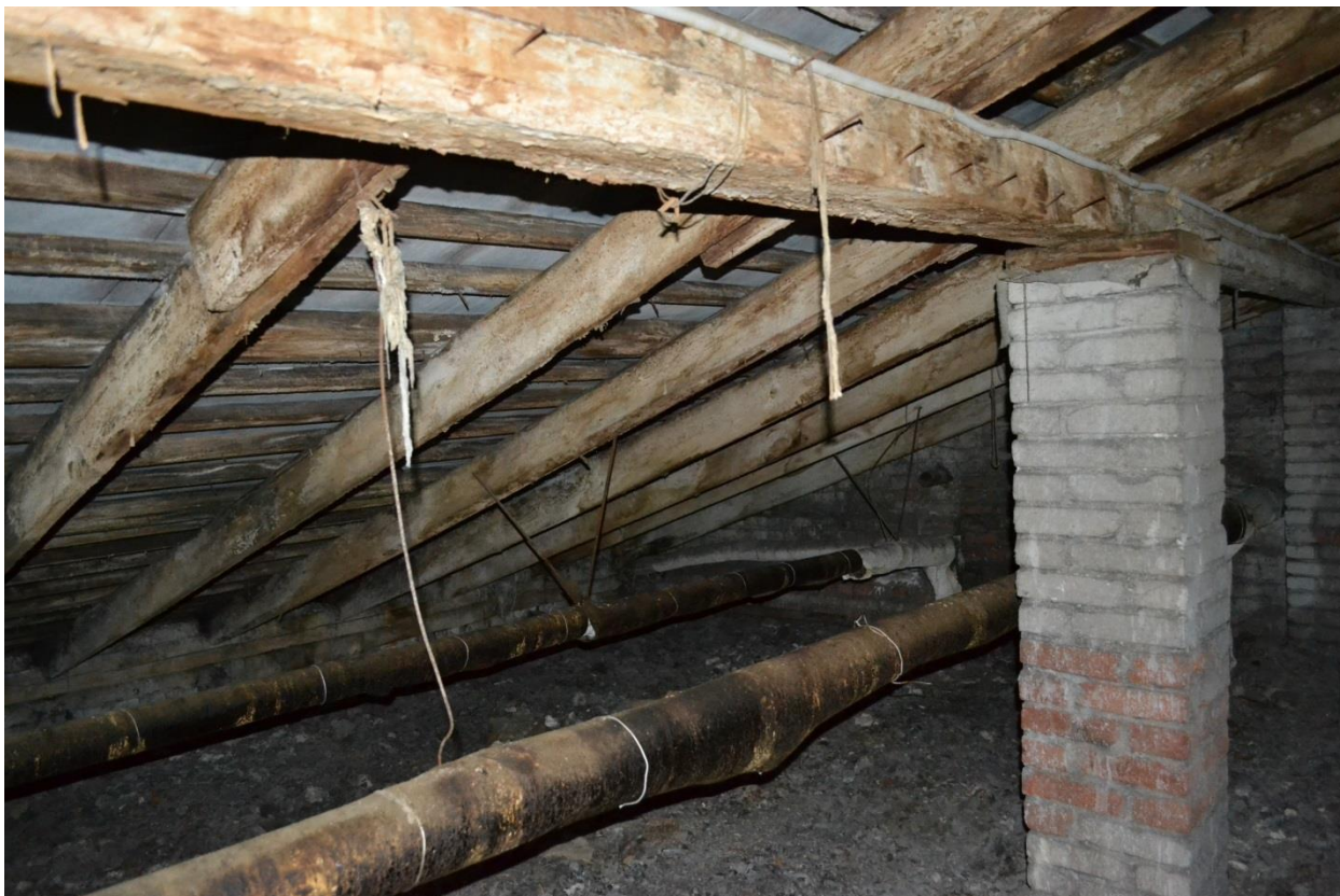
Фото 27. Вид на стропила и деформацию прогона Секции №2 чердачного пространства Общежития №6. Вид с северо-запада.
