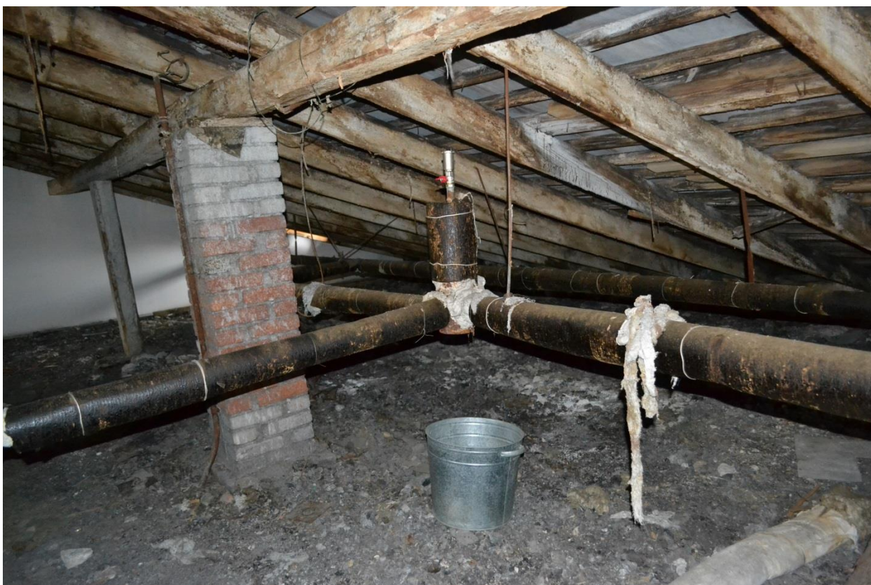
Фото 28. Чердачное пространство Общежития №6. Секция №2. Вид с юго-запада на место протечки.
