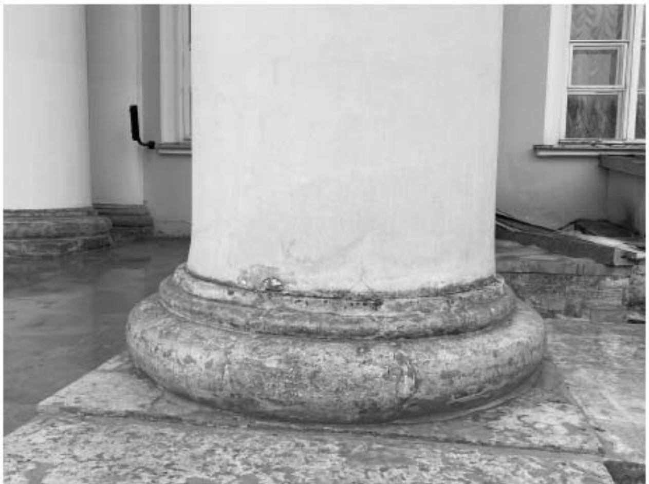
7. База колонны центрального портика Парадного двора объекта культурного наследия федерального значения «Дворец Таврический. Дворец», расположенного по адресу: г. Санкт-Петербург, ул. Шпалерная, д. 47, лит. А. 01.12.2020
