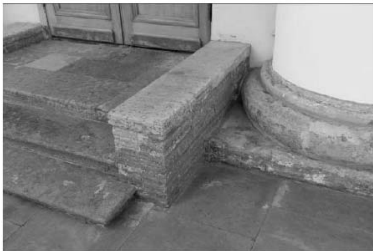
6. Крыльцо центрального портика Парадного двора объекта культурного наследия федерального значения «Дворец Таврический. Дворец», расположенного по адресу: г. Санкт-Петербург, ул. Шпалерная, д. 47, лит. А. 01.12.2020
