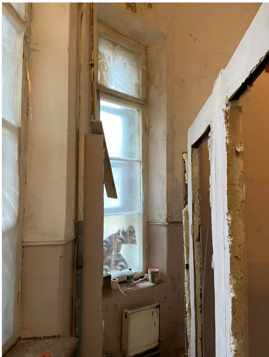
53. ОКН регионального значения «Жилой дом страхового общества “Россия” с садом и оградой» (г. Санкт-Петербург, Моховая ул., 27-29). Квартира № 37. Санузел. Пом. № 13.
