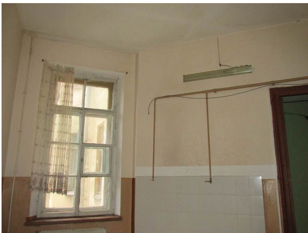
37. ОКН регионального значения «Жилой дом страхового общества “Россия” с садом и оградами» (г. Санкт-Петербург, Моховая ул., 27-29). Квартира № 37. Кухня 16.
