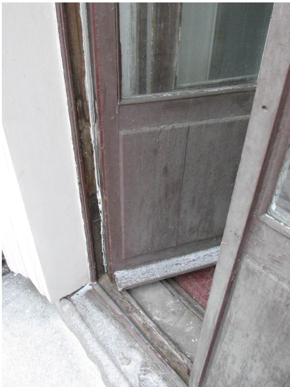
15. ОКН регионального значения «Жилой дом страхового общества “Россия” с садом и оградами» (г. Санкт-Петербург, Моховая ул., 27-29). Квартира № 37. Комната № 2.
