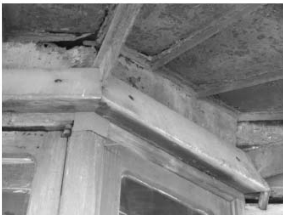
11. «Главное здание», входящее в состав объекта культурного наследия федерального значения «Институт ортопедический», Александровский парк, д.5 литера А. Главный вход. Фрагмент. Фото 11.03.2021 г.
