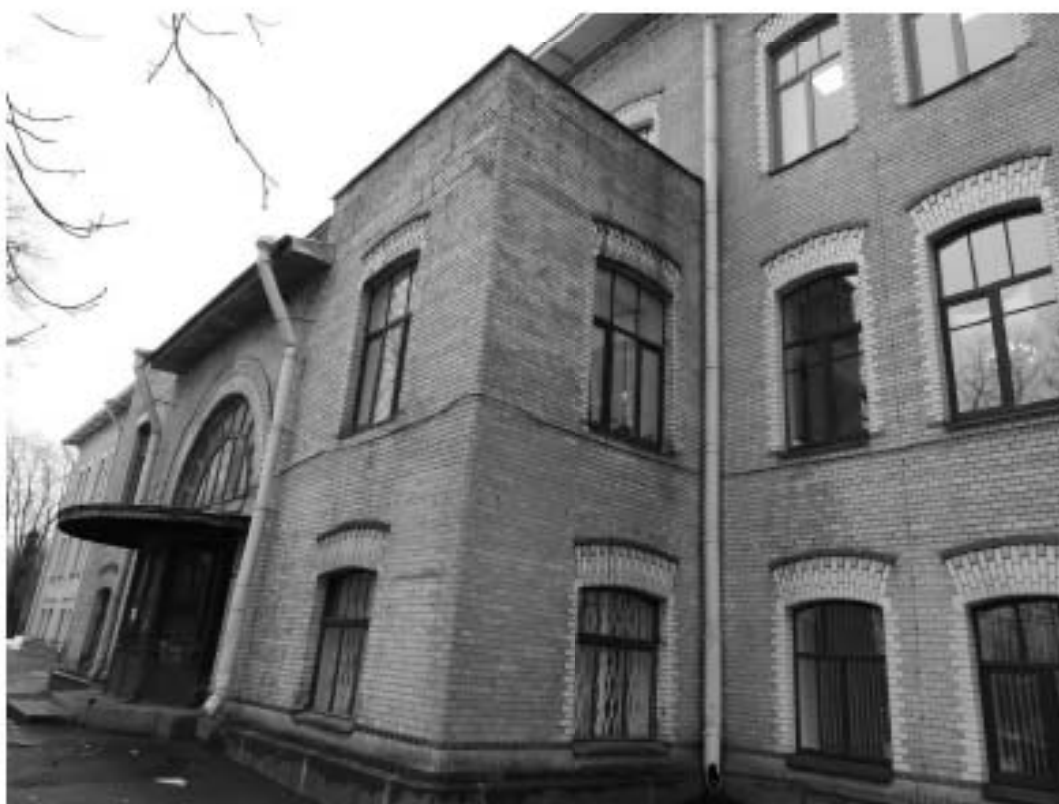
2. «Главное здание», входящее в состав объекта культурного наследия федерального значения «Институт ортопедический», Александровский парк, д. 5 литера А. Юго-западный фасад. Фрагмент. Фото 11.03.2021 г.
