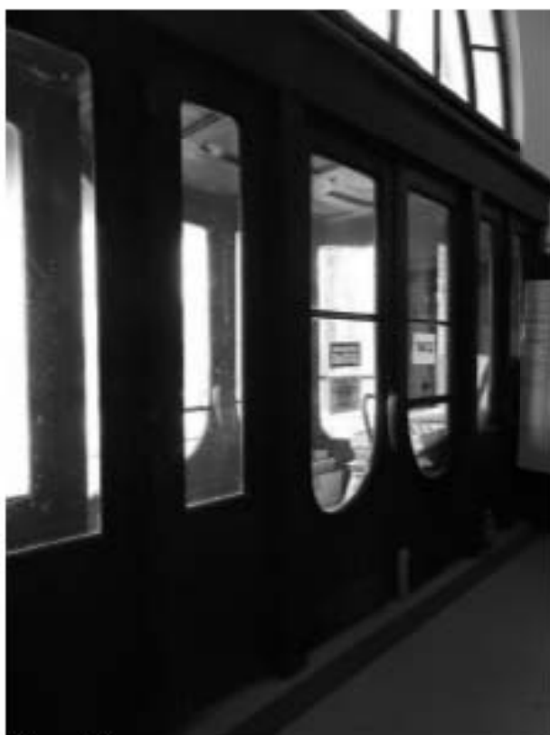
22. «Главное здание», входящее в состав объекта культурного наследия федерального значения «Институт ортопедический», Александровский парк, д.5 литера А. Главный вход. Общий вид тамбура со стороны вестибюля. Фото 11.03.2021 г.
