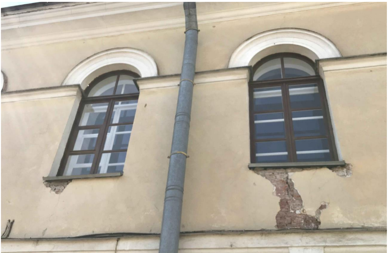
Фото 04. ОКН федерального значения «Дом плац-майорский» (Петропавловская крепость, дом 6 лит В). Северо-восточный фасад. Оконные проёмы в уровне второго этажа. Съёмка 17 мая 2021 г.
