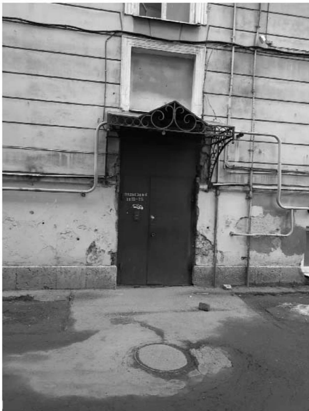
Фото 36. «Флигель жилой» (3-я линия Васильевского острова, д. 2 лит. Б). Фрагмент дворового фасада, вид на входную дверь с восточной стороны.
