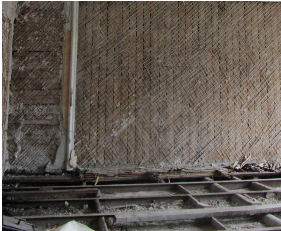
33. ОКН регионального значения «Жилой дом страхового общества “Россия” с садом и огородами» (г. Санкт-Петербург, Моховая ул., 27-29). Квартира № 34.
