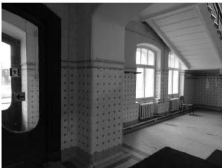
29. «Главное здание», входящее в состав объекта культурного наследия федерального значения «Институт ортопедический», Александровский парк, д. 5 литера А. Вход со стороны Троицкой площади. Вестибюль. Фрагмент. Фото 11.03.2021 г.
