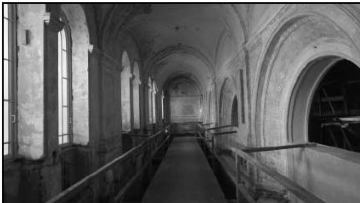
50. Объект культурного наследия федерального значения «Консерватория». Помещение 4-го этажа в осях «1» - «3»/«Д» - «Н».
