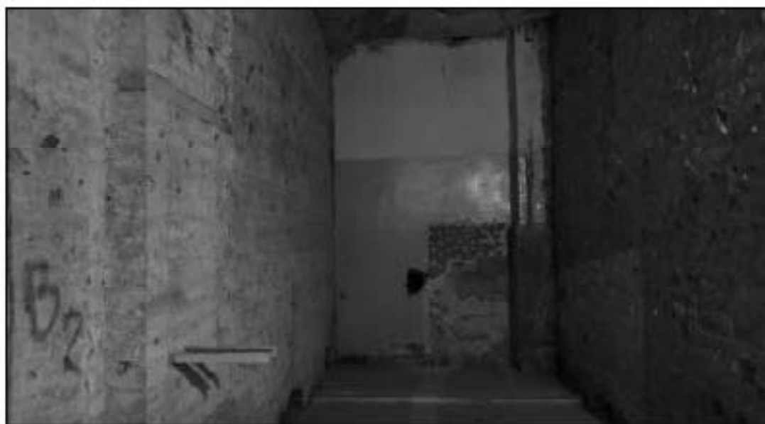
49. Объект культурного наследия федерального значения «Консерватория». Помещение 3-го этажа в осях «П» - «Н»/«32» - «35».
