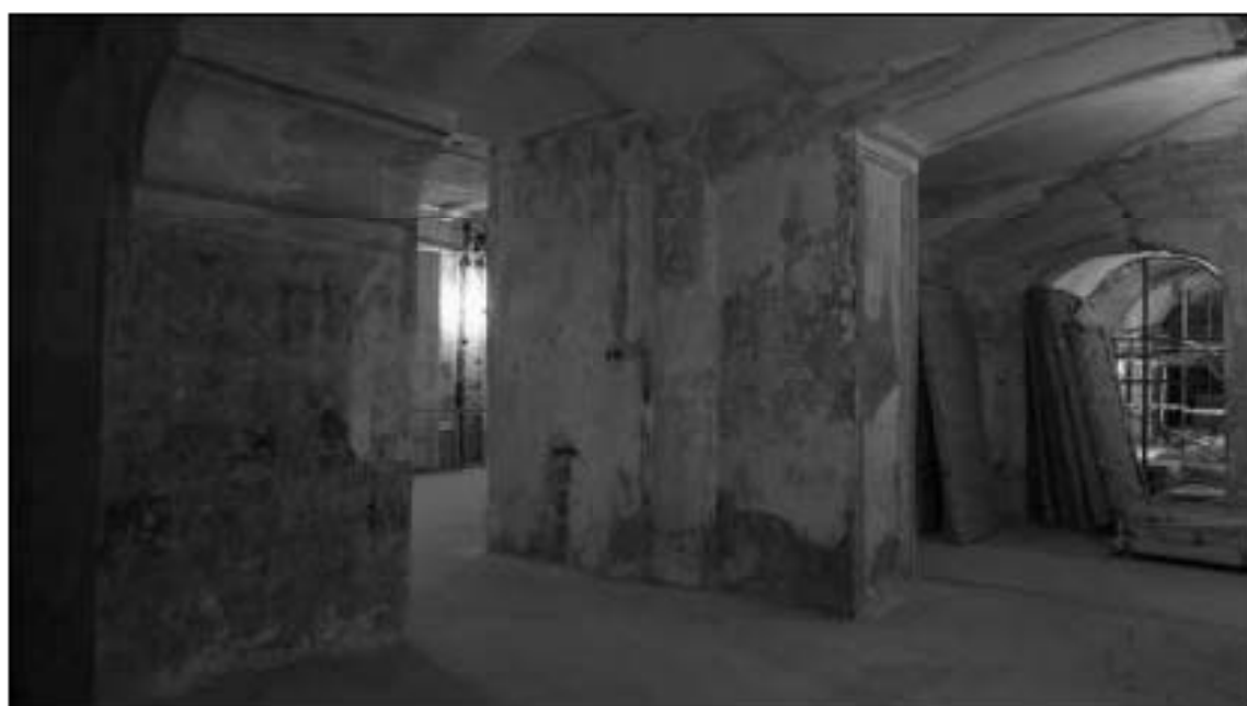
37. Объект культурного наследия федерального значения «Консерватория». Помещение 1-го этажа в осях «И» - «Д»/«8» - «17».
