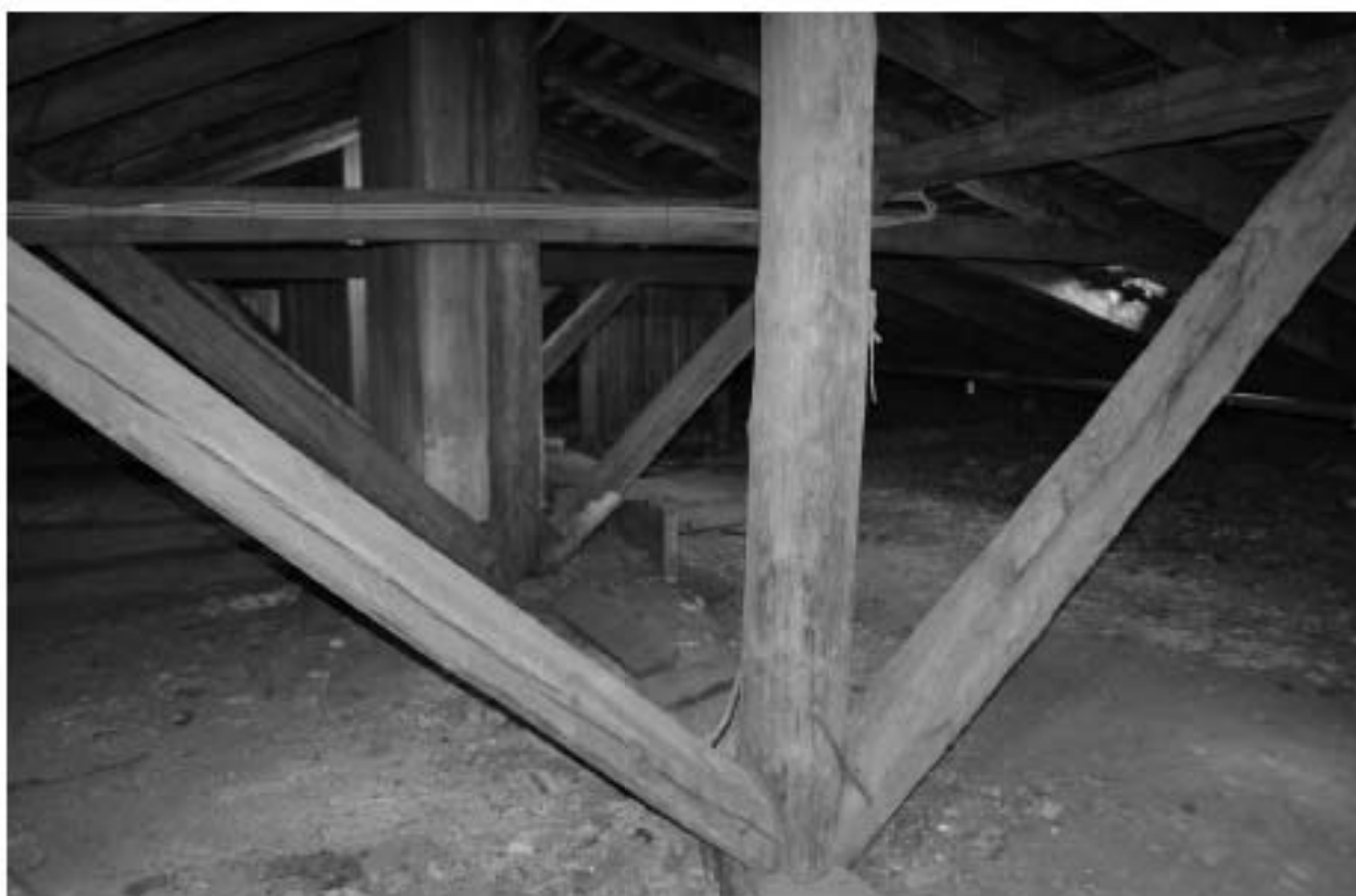
Фото 51. ОКН регионального значения «Особняк Строгановой А.Д.». Чердак. Стропильная система. Фрагмент. Съёмка 21.06.2021 г.
