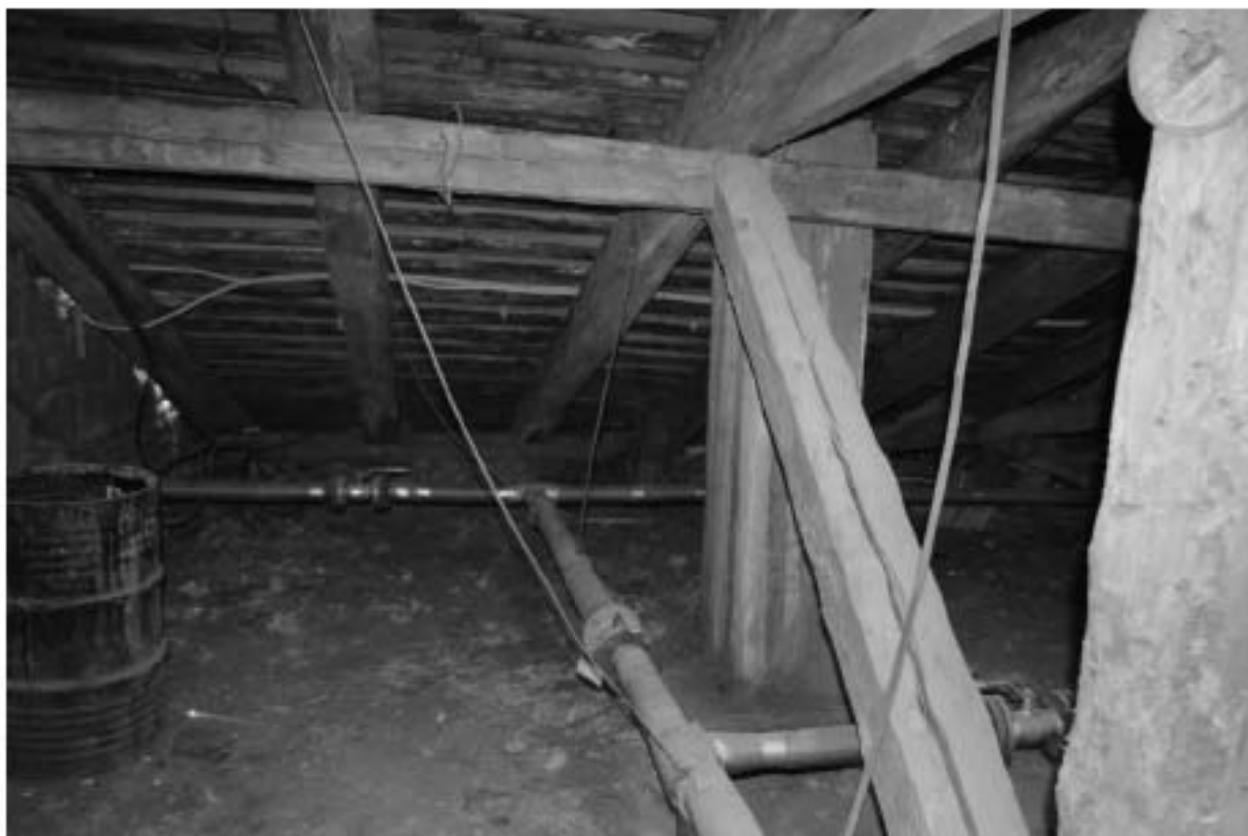
Фото 49. ОКН регионального значения «Особняк Строгановой А.Д.». Чердак. Стропильная система. Фрагмент. Съёмка 21.06.2021 г.
