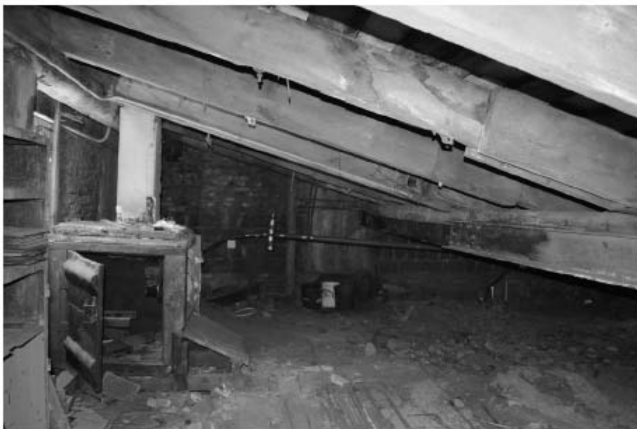
Фото 40. ОКН регионального значения «Особняк Строгановой А.Д.». Чердак. Стропильная система. Фрагмент. Съёмка 21.06.2021 г.
