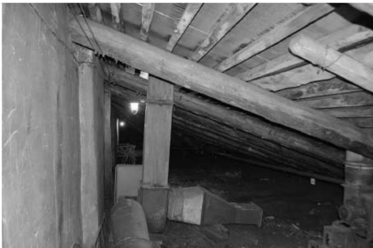
Фото 38. ОКН регионального значения «Особняк Строгановой А.Д.». Чердак. Стропильная система. Фрагмент. Съёмка 21.06.2021 г.
