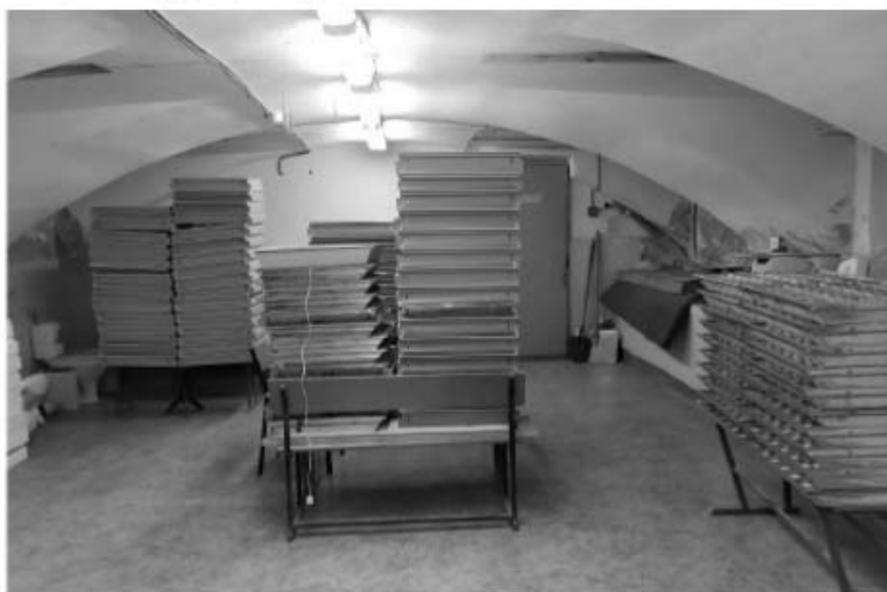
Фото 56. ОКН регионального значения «Особняк Строгановой А.Д.». Подвальное помещение 2-Н (6). Общий вид. Съёмка 21.06.2021 г.
