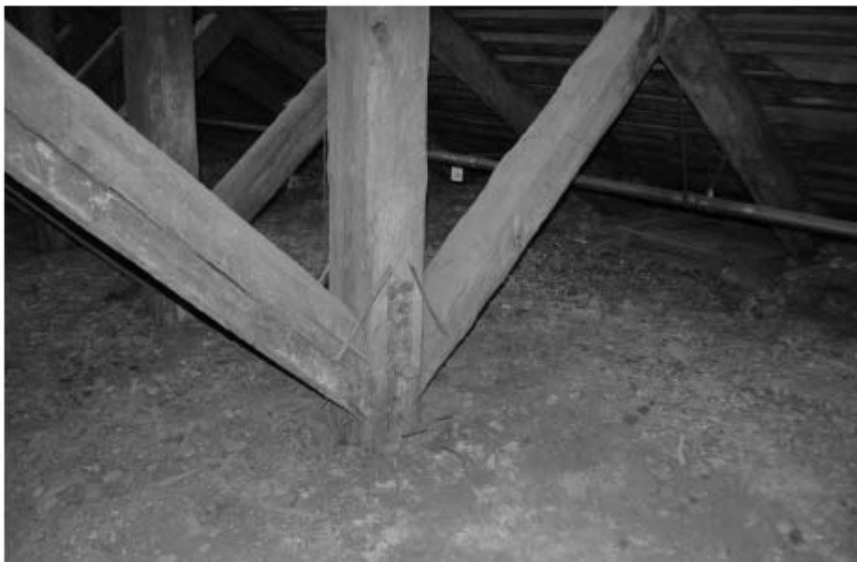
Фото 43. ОКН регионального значения «Особняк Строгановой А.Д.». Чердак. Стропильная система. Фрагмент. Съёмка 21.06.2021 г.
