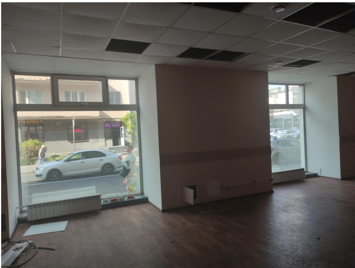
Фото 30. Выявленный объект культурного наследия «Дом А.А. Каплуна». Санкт-Петербург, Каменноостровский проспект, дом 53/22 лит.А (Каменноостровский пр., 53; Профессора Попова ул., 22 (угловой дом)). Помещение 10. Дата съёмки – 12.07.2021 г.
