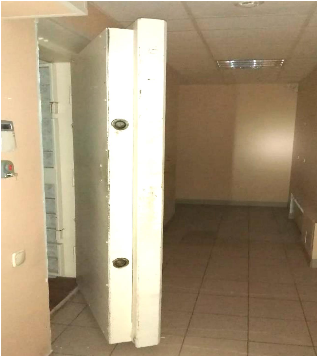
Фото 16. Выявленный объект культурного наследия «Дом А.А. Каплуна». Санкт-Петербург, Каменноостровский проспект, дом 53/22 лит.А (Каменноостровский пр., 53; Профессора Попова ул., 22 (угловой дом). Помещение 22. Дверное заполнение входа в помещение 21 (бывшее хранилище банка). Дата съёмки – 12.07.2021 г.
