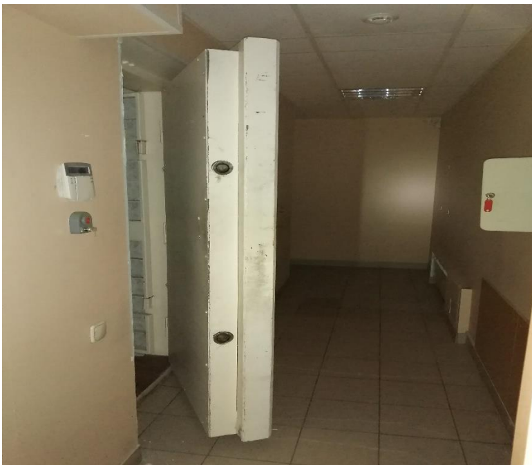
Фото 16. Выявленный объект культурного наследия «Дом А.А. Каплуна». Санкт-Петербург, Каменноостровский проспект, дом 53/22 лит.А (Каменноостровский пр., 53; Профессора Попова ул., 22 (угловой дом)). Помещение 22. Дверное заполнение входа в помещение 21 (бывшее хранилище банка).
