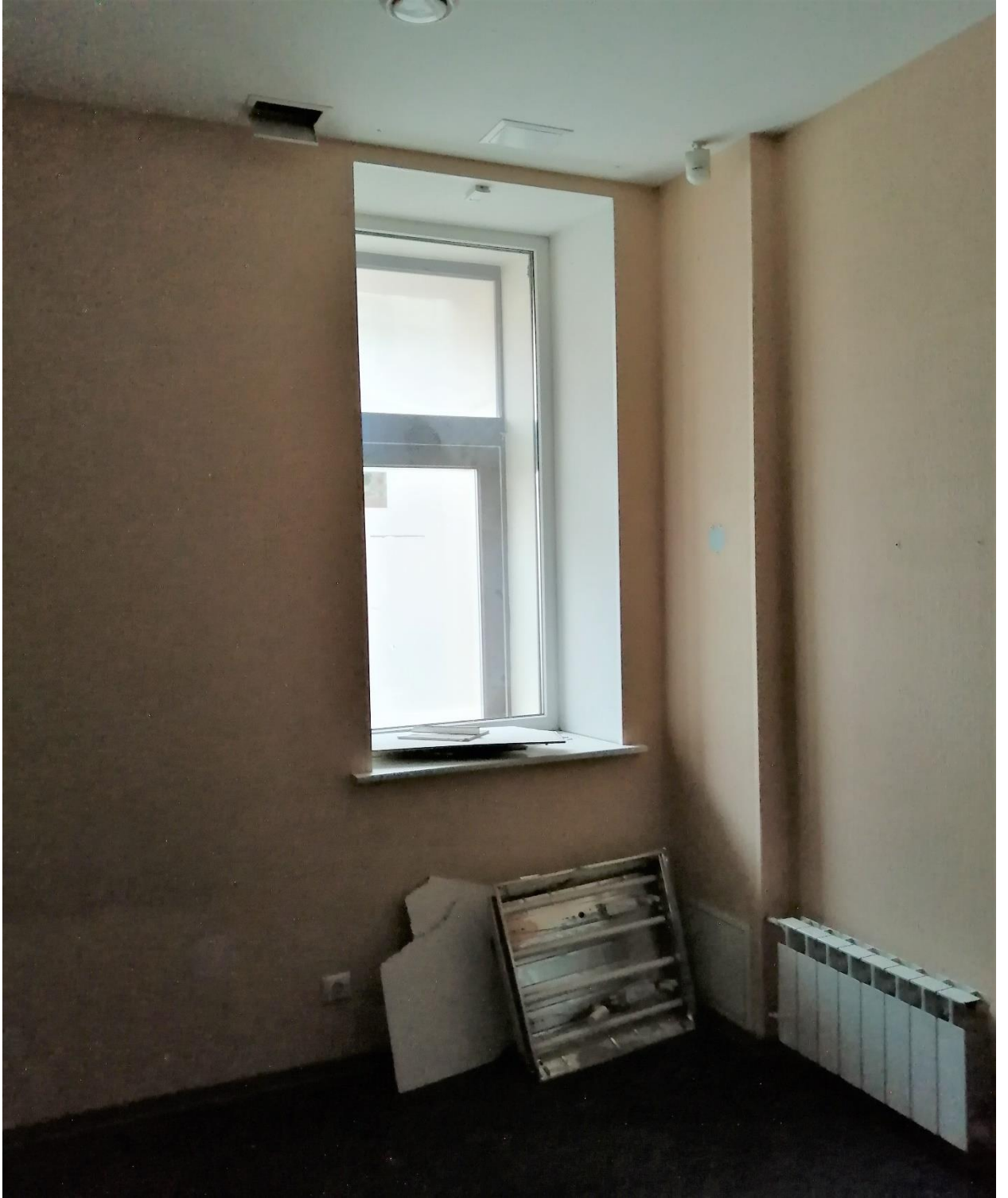
Фото 12. Выявленный объект культурного наследия «Дом А.А. Каплуна». Санкт-Петербург, Каменноостровский проспект, дом 53/22 лит.А (Каменноостровский пр., 53; Профессора Попова ул., 22 (угловой дом). Помещение 36. Вид на оконный проем, с заполнением, на месте дверного проема видна часть внешнего дверного заполнения.
