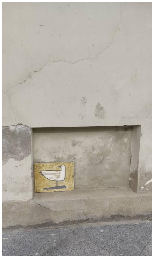
Фото 11. Заложенные оконные заполнения фасада выявленного объекта культурного наследия «Жилой дом» по наб. реки Фонтанки
