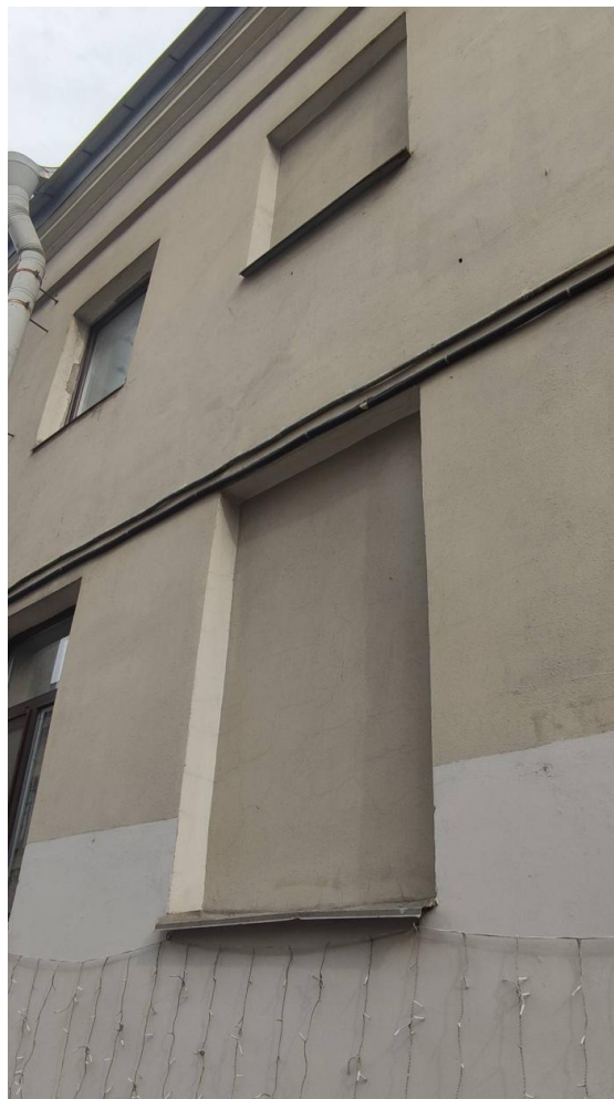
Фото 7. Фрагмент фасада выявленного объекта культурного наследия «Жилой дом» по ул. Оружейника Федорова, заложённые оконные проёмы
