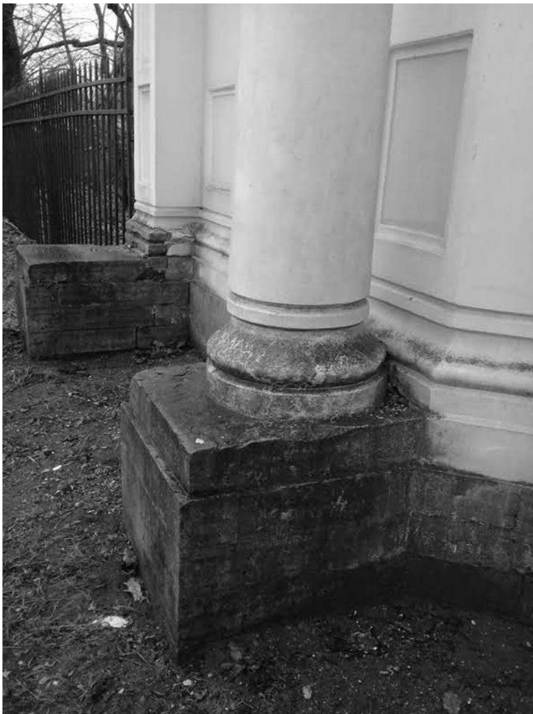
Фото № 26. Оранжерея № 1. Известняковые тумбы в основании колон и пилястр со стороны восточного фасада.
