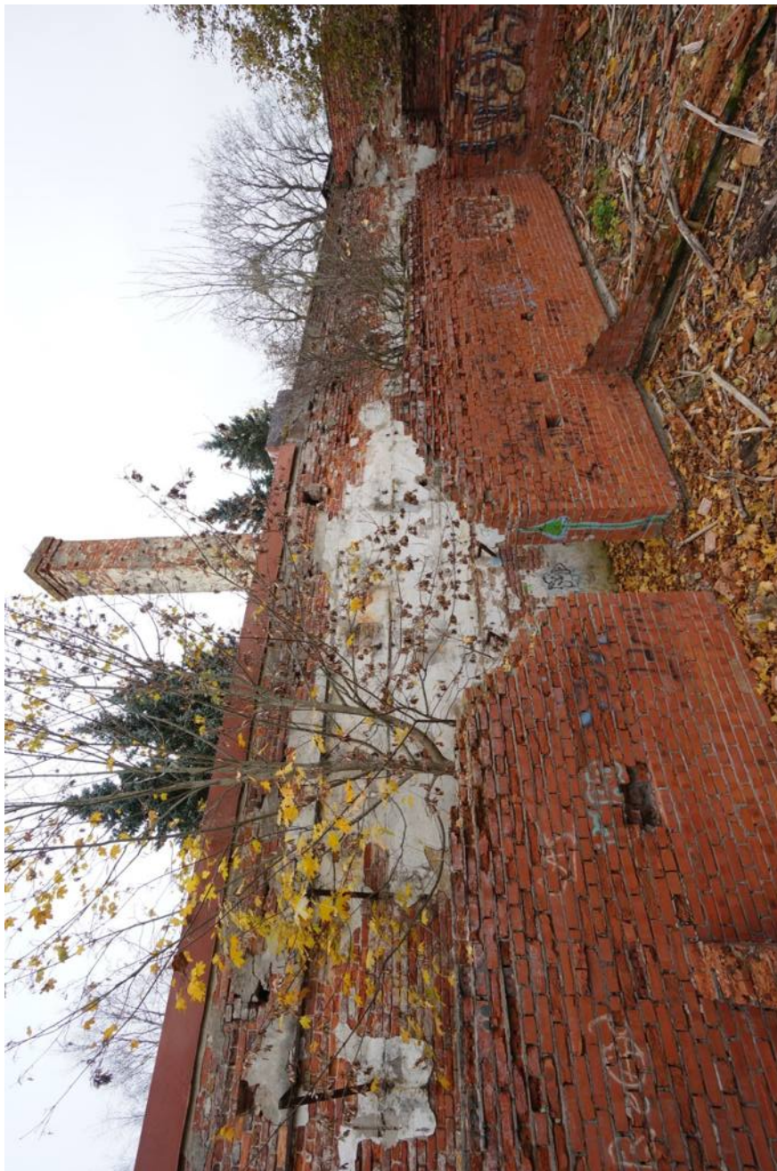
Илл. 85. Оранжерея № 5. Западная часть здания со стороны разрушенного южного фасада. Фото 2016 г. из архива материалов заказчика.
