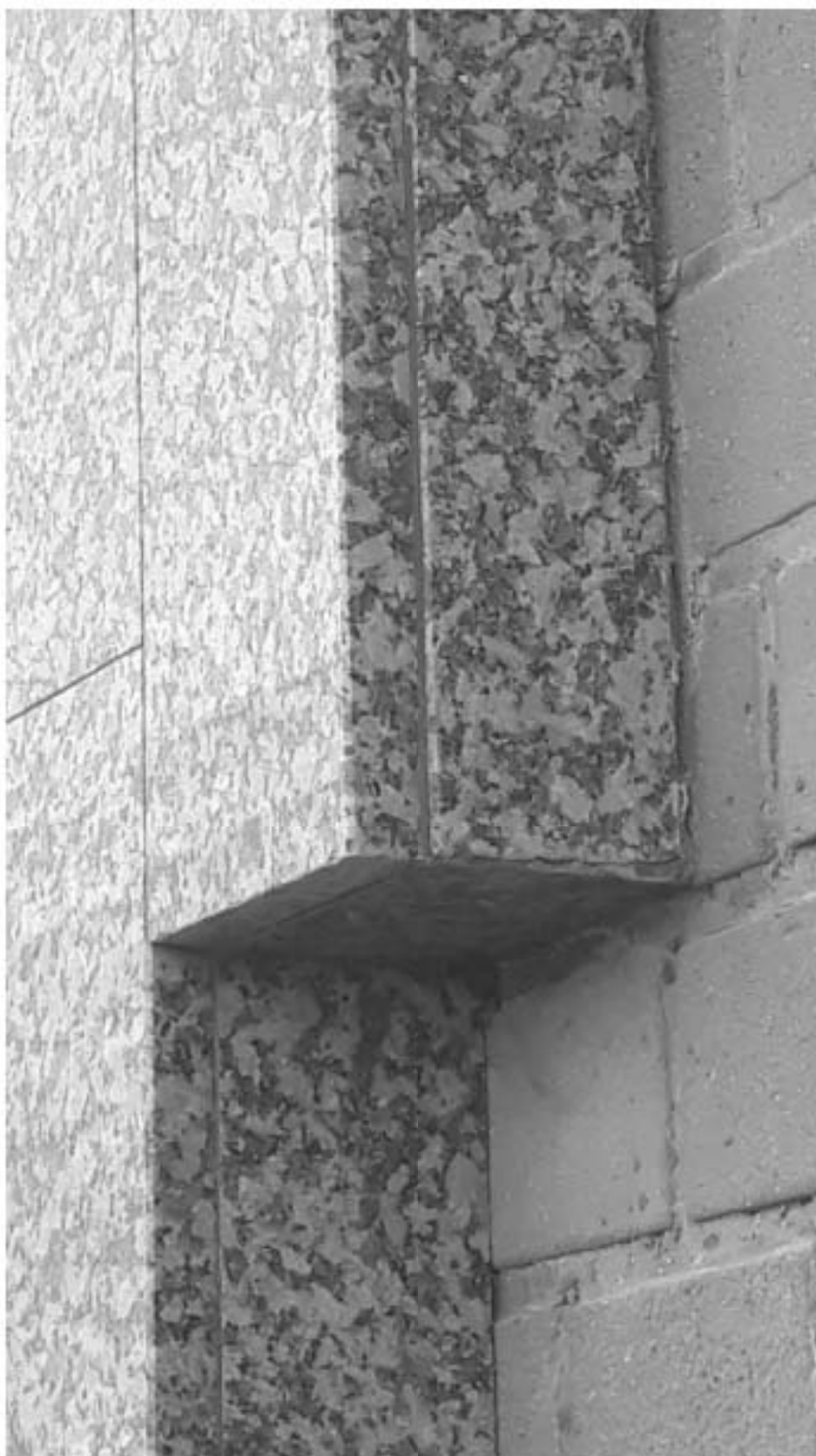
5. Фрагмент поздней гранитной облицовки на лицевом фасаде объекта культурного наследия регионального значения «Доходный дом Александро-Невской Лавры», расположенного по адресу: г. Санкт-Петербург, Невский пр., д. 153, литера А.
