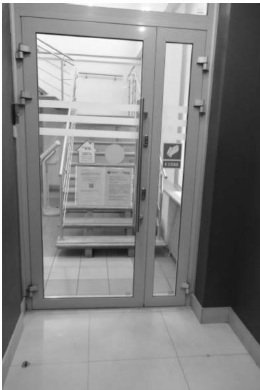
11. Фрагмент интерьера тамбура пом. 12-Н (4) объекта культурного наследия регионального значения «Доходный дом Александро-Невской Лавры», расположенного по адресу: г. Санкт-Петербург, Невский пр., д. 153, литера А.
