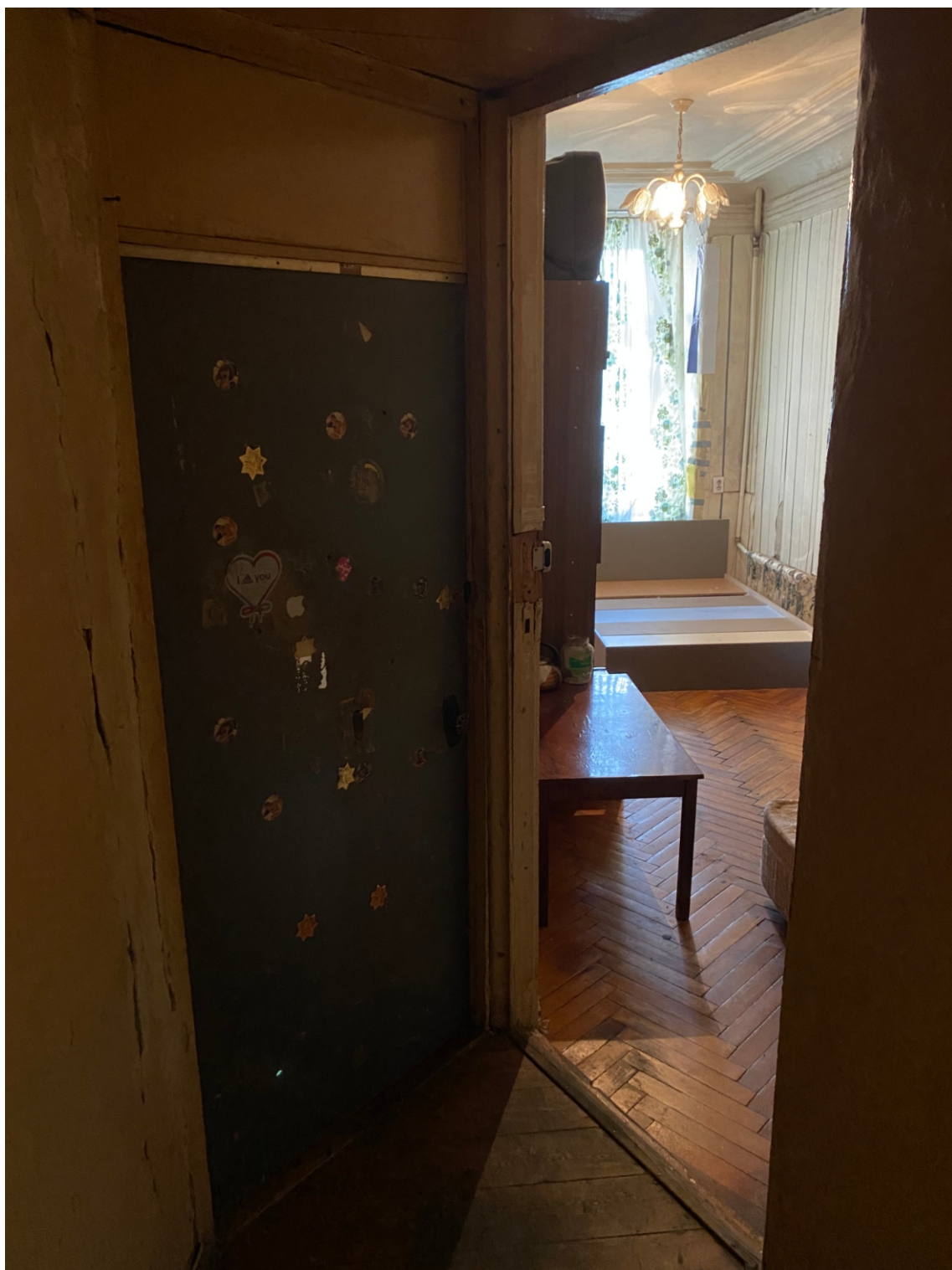
17. Дом Т.П. Павловой. Конная ул., 8, литера А. Интерьер помещения 3-Н кв. №53. фото: 17.05.2021.
