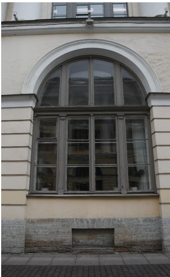
Фото 3. Окно по фасаду на ул. 3. Росси
