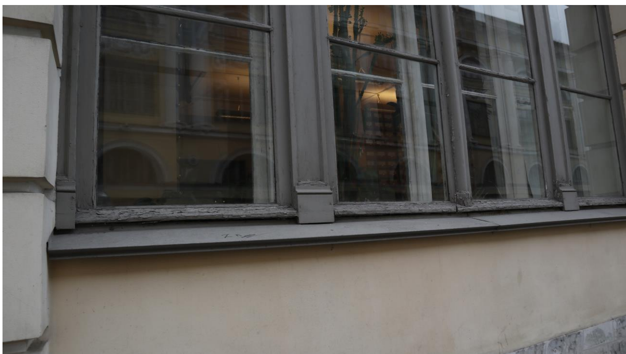
Фото 6. Окно по фасаду на ул. 3. Росси
