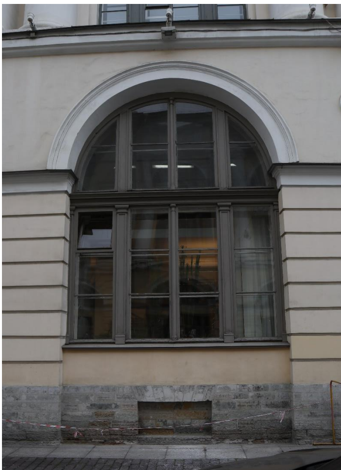
Фото 5. Окно по фасаду на ул. 3. Росси
