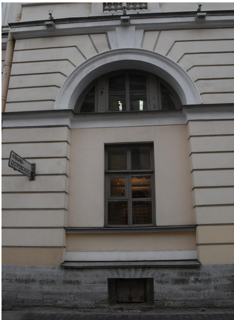
Фото 7. Окно по фасаду на ул. 3. Росси
