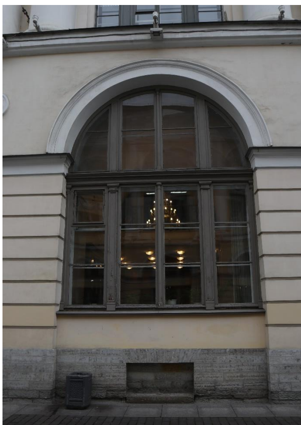
Фото 4. Окно по фасаду на ул. 3. Росси
