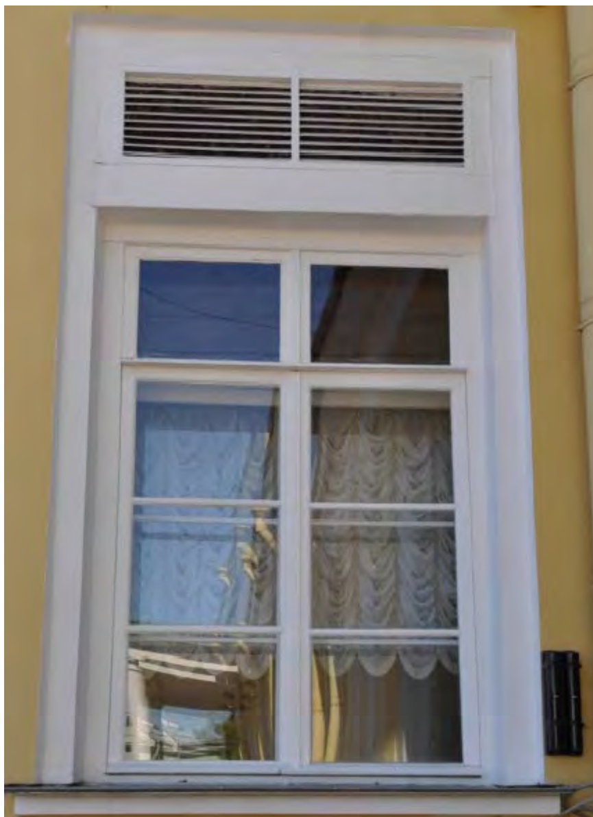
8. Оконное заполнение в уровне 1-ого этажа на дворовом фасаде объекта культурного наследия федерального значения «Дворец Таврический. Дворец», расположенного по адресу: г. Санкт-Петербург, ул. Шпалерная, д. 47, лит. А. 15.12.2022
