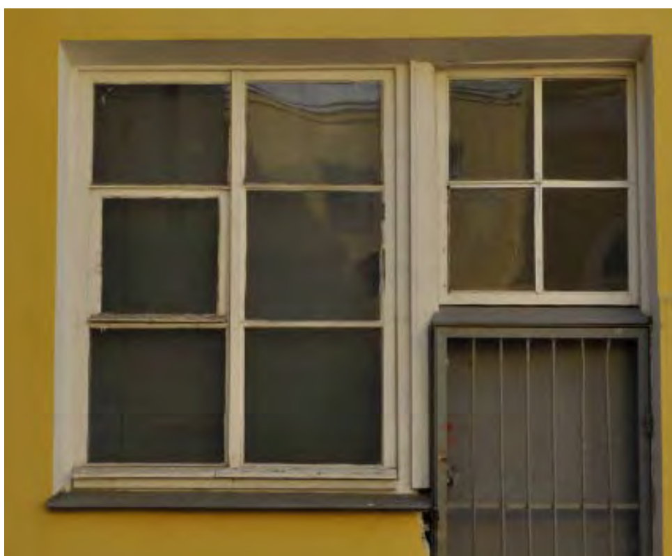
18. Оконное заполнение в уровне 1-ого этажа на дворовом фасаде объекта культурного наследия федерального значения «Дворец Таврический. Дворец», расположенного по адресу: г. Санкт-Петербург, ул. Шпалерная, д. 47, лит. А. 15.12.2022
