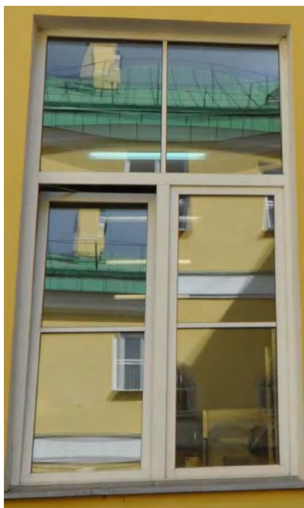
17. Оконное заполнение в уровне 1-ого этажа на дворовом фасаде объекта культурного наследия федерального значения «Дворец Таврический. Дворец», расположенного по адресу: г. Санкт-Петербург, ул. Шпалерная, д. 47, лит. А. 15.12.2022
