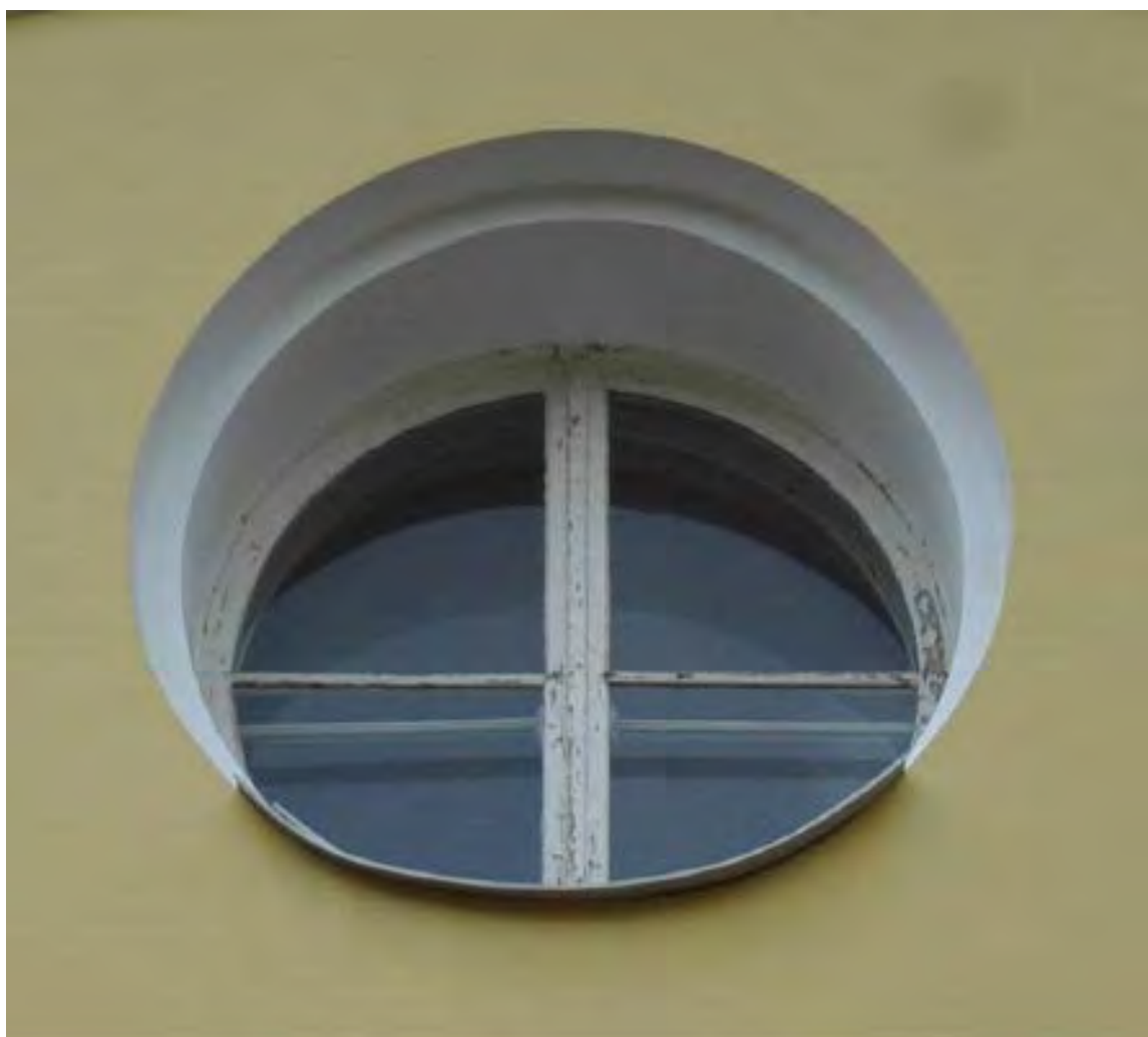
25. Оконное заполнение в уровне 2-ого этажа объекта культурного наследия федерального значения «Дворец Таврический. Дворец», расположенного по адресу: г. Санкт-Петербург, ул. Шпалерная, д. 47, лит. А. 15.12.2022
