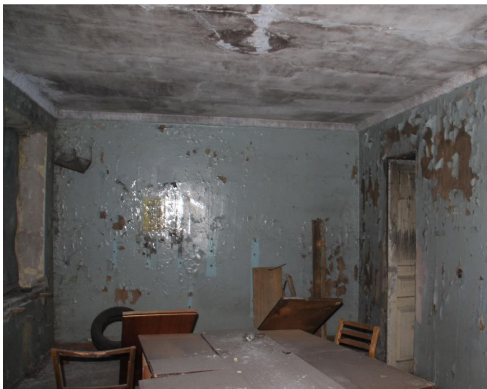
66. Объект культурного наследия регионального значения «Жилой дом», входящий в состав объекта культурного наследия регионального значения «Дача Сиверса (Кировский городок)», расположенный по адресу: Санкт-Петербург, Кировский район, пр. Стачек, д. 172, литера А. Помещение второго этажа. Фрагмент интерьера.
