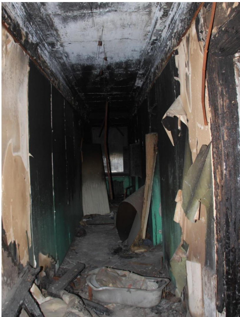
95. Объект культурного наследия регионального значения «Жилой дом», входящий в состав объекта культурного наследия регионального значения «Дача Сиверса (Кировский городок)», расположенный по адресу: Санкт-Петербург, Кировский район, пр. Стачек, д. 172, литера А. Помещение четвертого этажа. Фрагмент интерьера.
