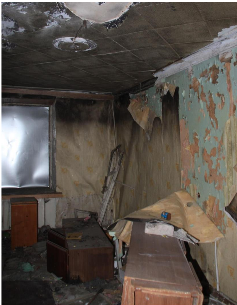
64. Объект культурного наследия регионального значения «Жилой дом», входящий в состав объекта культурного наследия регионального значения «Дача Сиверса (Кировский городок)», расположенный по адресу: Санкт-Петербург, Кировский район, пр. Стачек, д. 172, литера А. Помещение второго этажа. Фрагмент интерьера.
