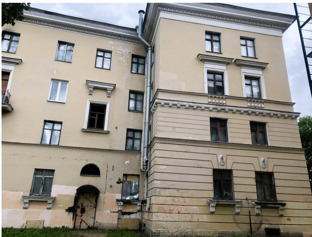
15. Объект культурного наследия регионального значения «Жилой дом», входящий в состав объекта культурного наследия регионального значения «Дача Сиверса (Кировский городок)», расположенный по адресу: Санкт-Петербург, Кировский район, пр. Стачек, д. 172, литера А. Дворовый фасад. Фрагмент.
