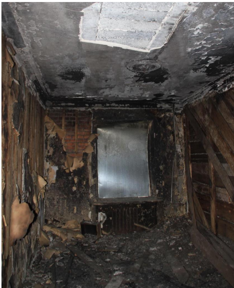
100. Объект культурного наследия регионального значения «Жилой дом», входящий в состав объекта культурного наследия регионального значения «Дача Сиверса (Кировский городок)», расположенный по адресу: Санкт-Петербург, Кировский район, пр. Стачек, д. 172, литера А. Помещение четвертого этажа. Фрагмент интерьера.
