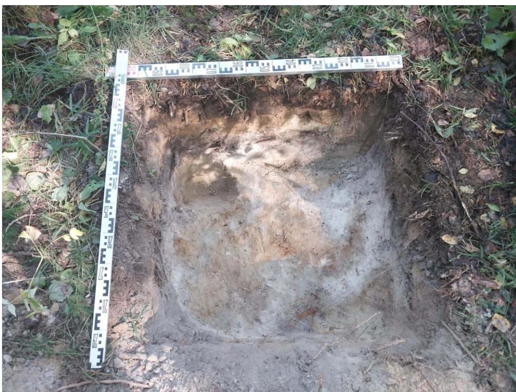
Рис. 29. г. Санкт-Петербург, Колпинский район. «Капитальный ремонт магистрального газопровода». Шурф 3. Общий вид после проведения земляных работ. Вид сверху с востока. В качестве масштабов использованы линейки длиной 1 м.
