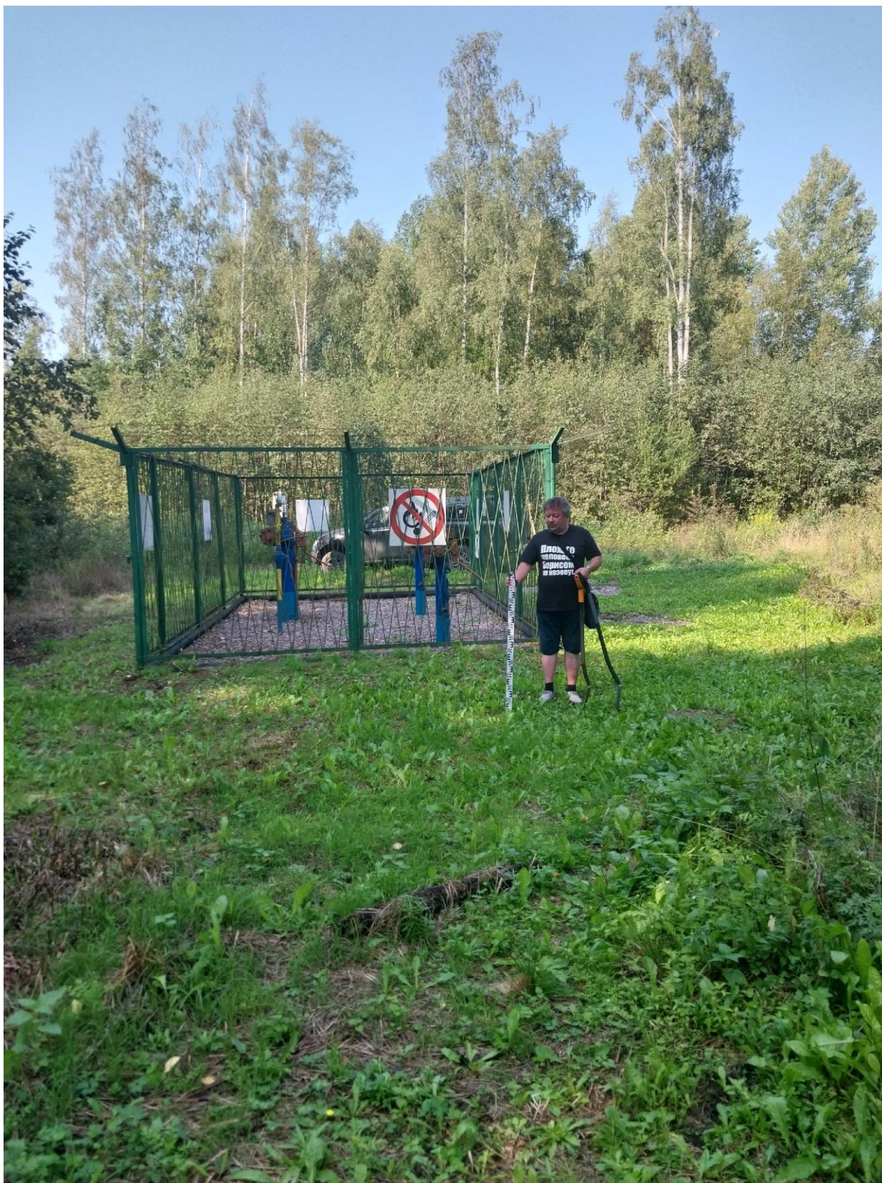
Рис. 11. г. Санкт-Петербург, Колпинский район. «Капитальный ремонт магистрального газопровода. Газопровод-отвод к ГРС пос. Никольское, Инв. № 000013994, ГО на ГРС «Никольское» с 0 км по 7,825 км. Колпинское ЛПУМГ». Начало маршрута обследования. Точка фотофиксации 1. Вид с запада.
