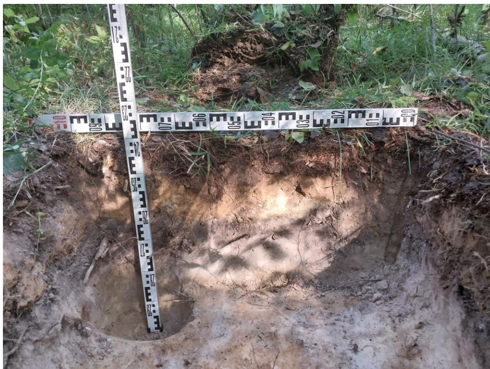
Рис. 30. г. Санкт-Петербург, Колпинский район. «Капитальный ремонт магистрального газопровода». Шурф 3. Западная стенка. Стратиграфия. Контрольный прокоп. Вид с востока. В качестве масштабов использованы линейки длиной 1 м.
