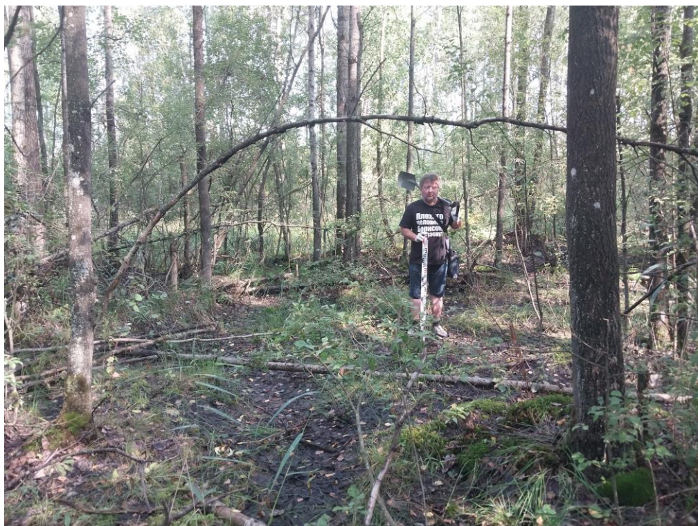
Рис. 12. г. Санкт-Петербург, Колпинский район. «Капитальный ремонт магистрального газопровода». Шурф 1. Общий вид на место закладки. Вид с юга.
