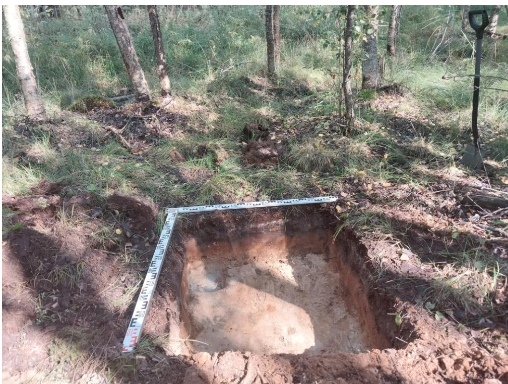
Рис. 21. г. Санкт-Петербург, Колпинский район. «Капитальный ремонт магистрального газопровода». Шурф 2. Общий вид после проведения земляных работ. Вид с юга. В качестве масштабов использованы линейки длиной 1 м.
