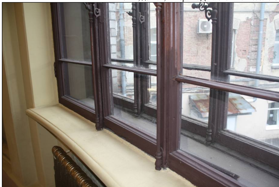
16. Оконные заполнения второго этажа. Объект культурного наследия федерального значения «Дом, где в первой половине XIX в. размещалась Российско-Американская компания. Здесь в 1820-х гг. жили декабристы Бестужев-Марлинский А.А. и Рылеев К.Ф.», расположенный по адресу: Санкт-Петербург, Адмиралтейский район, набережная реки Мойки, дом 72, литера А. Дата съемки: 21.06.2019.
