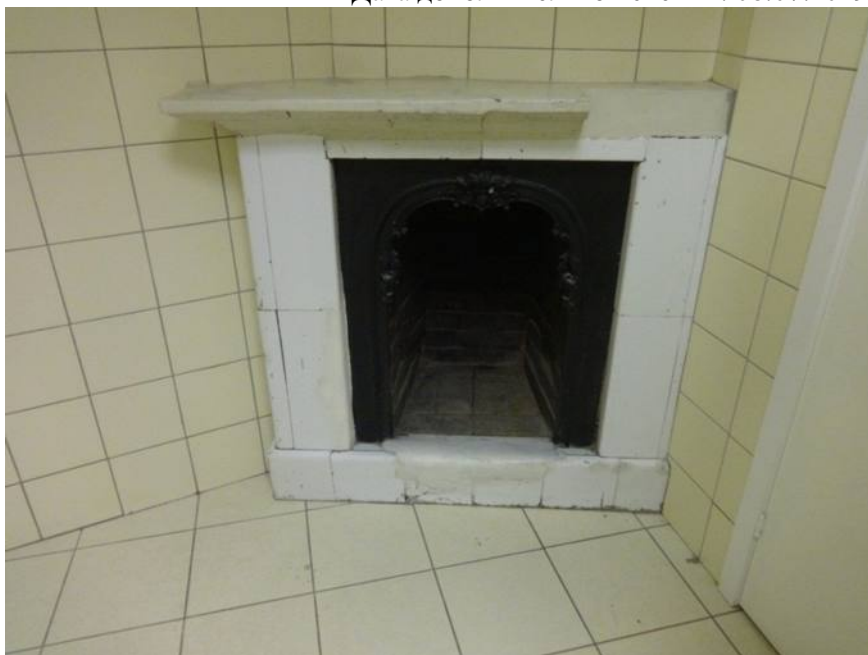
40. Камин угловой одноярусный. Объект культурного наследия федерального значения «Дом, где в первой половине XIX в. размещалась Российско-Американская компания. Здесь в 1820-х гг. жили декабристы Бестужев-Марлинский А.А. и Рылеев К.Ф.», расположенный по адресу: Санкт-Петербург, Адмиралтейский район, набережная реки Мойки, дом 72, литера А. Дата дополнительной съемки: 08.07.2019.
