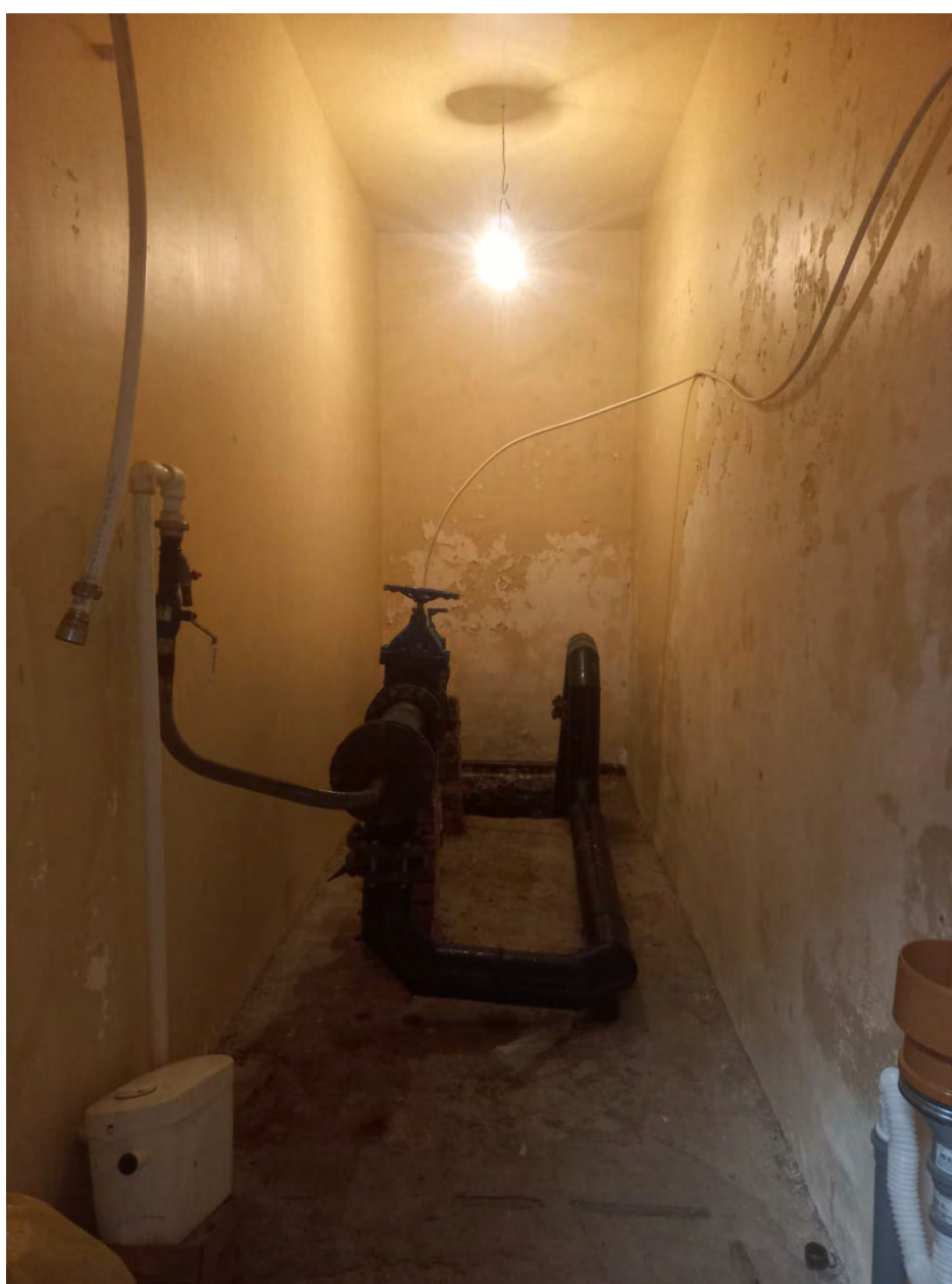
Фото 17. Внутренние помещения Бокового корпуса. Водомерный узел.
