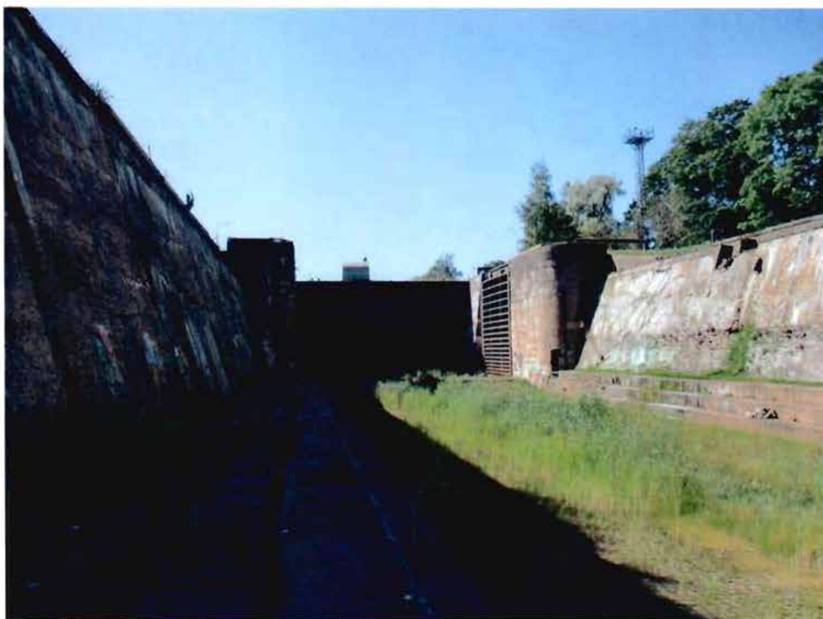
4. Вид на батопорт и двустворчатые ворота в южной части дока со стороны камеры
