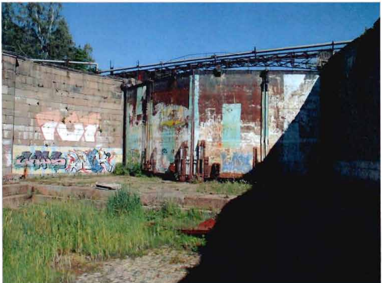
6. Вид на двустворчатые ворота и переходной мост в северной части дока со стороны камеры
