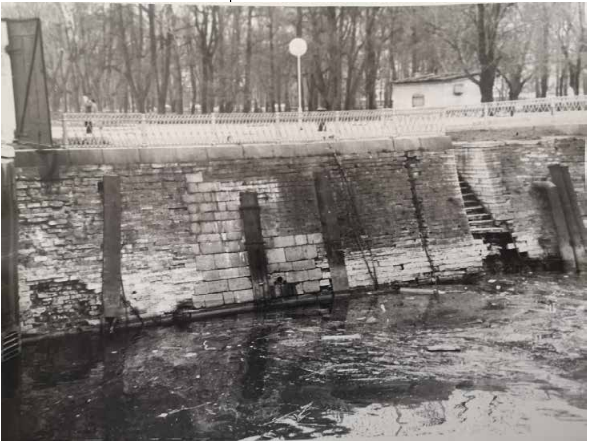
Илл. 44. Петровский док-канал. Состояние стены у моста дока. 1983 г. //Фототека отд. охраны памятников № 128463. Архив КГИОП. П. 615
