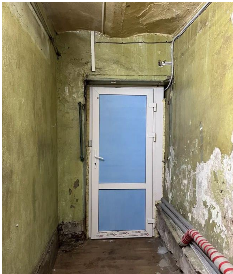
75. Объект культурного наследия федерального значения «Усадьба Демидовых» по адресу: г. Санкт-Петербург, пер. Гривцова, д. 5, лит. А (Гривцова пер., 1). Восточный флигель. Коридор цокольного этажа. Общий вид. Помещение 0(В)-1
