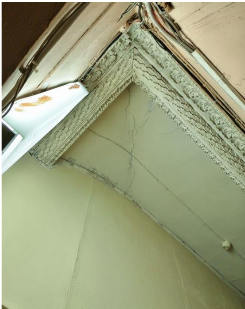
41. Объект культурного наследия федерального значения «Усадьба Демидовых» по адресу: г. Санкт-Петербург, пер. Гривцова, д. 5, лит. А (Гривцова пер., 1). Главный дом. Второй этаж. Коридор. Фрагмент интерьера. Помещение 1(Г)-17. Лепной антаблемент
