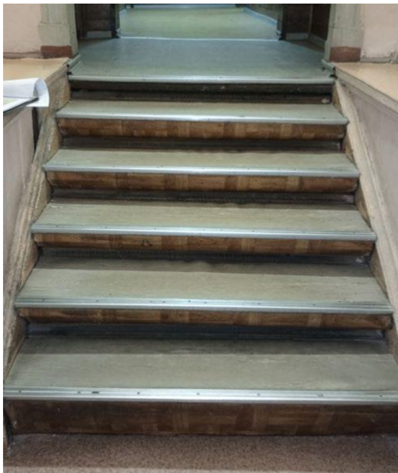
26. Объект культурного наследия федерального значения «Усадьба Демидовых» по адресу: г. Санкт-Петербург, пер. Гривцова, д. 5, лит. А (Гривцова пер., 1). Главный дом. Третий этаж. Служебная лестница. Деревянная лестница ЛК-6
