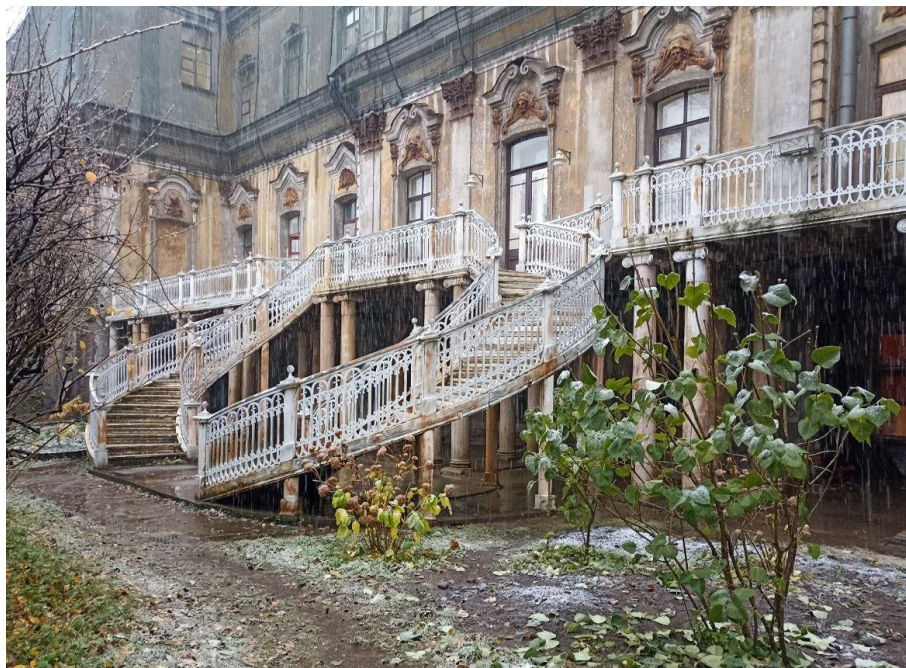
3. Объект культурного наследия федерального значения «Усадьба Демидовых» по адресу: г. Санкт-Петербург, пер. Гривцова, д. 5, лит. А (Гривцова пер., 1). Главный дом. Садовый фасад
