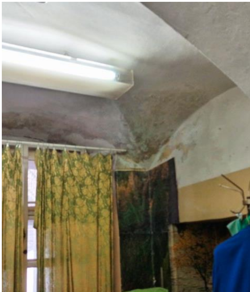
36. Объект культурного наследия федерального значения «Усадьба Демидовых» по адресу: г. Санкт-Петербург, пер. Гривцова, д. 5, лит. А (Гривцова пер., 1). Главный дом. Помещение первого этажа. Фрагмент интерьера. Помещение 1(Г)-27
