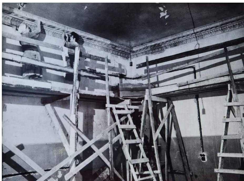
32. Усадьба Демидовых. Главный дом. Рабочий момент реставрации 1948 г. Фотография. ЦГА НТД СПб. Ф. 488. Оп. 3-1. Д. 115. Л. 17.
