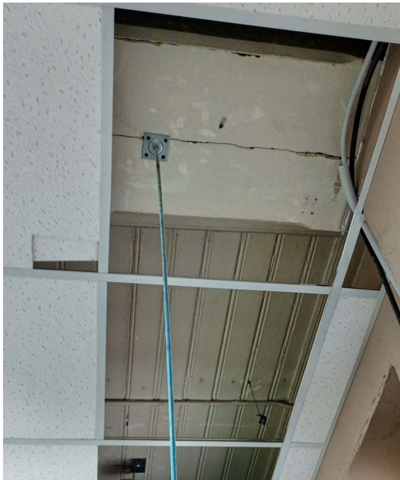
83. Объект культурного наследия федерального значения «Усадьба Демидовых» по адресу: г. Санкт-Петербург, пер. Гривцова, д. 5, лит. А (Гривцова пер., 1). Кегельбан. Конструкция чердачного перекрытия
