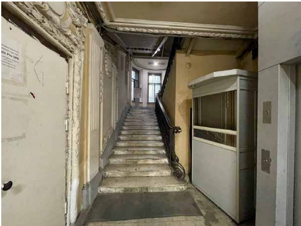
9. Общий вид лестничной клетки в уровне первого этажа. Справа под лестницей установлена сторожевая будка, а также лифтовая шахта (на всю высоту здания).
