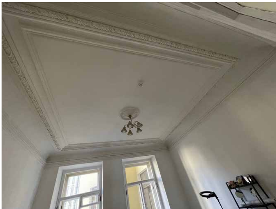
94. Общий вид оформления потолка помещения 23-Н(3): многоуровневый профилированный карниз с падугой и карнизом в виде гирлянды растительного мотива. Розетка в центре потолка поздняя.
