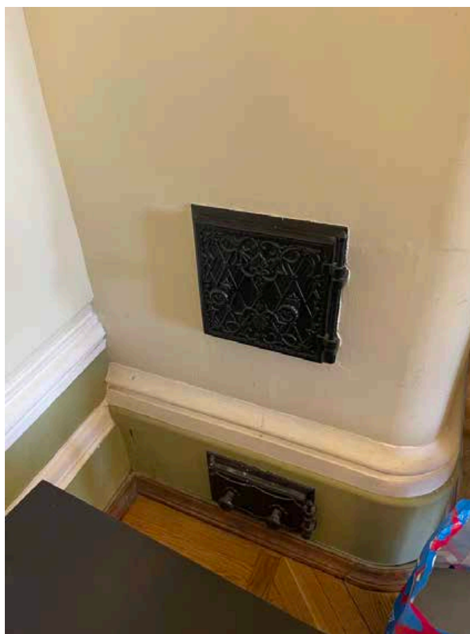
140. Дверцы металлические в печи в помещении 26(Н)-2.
