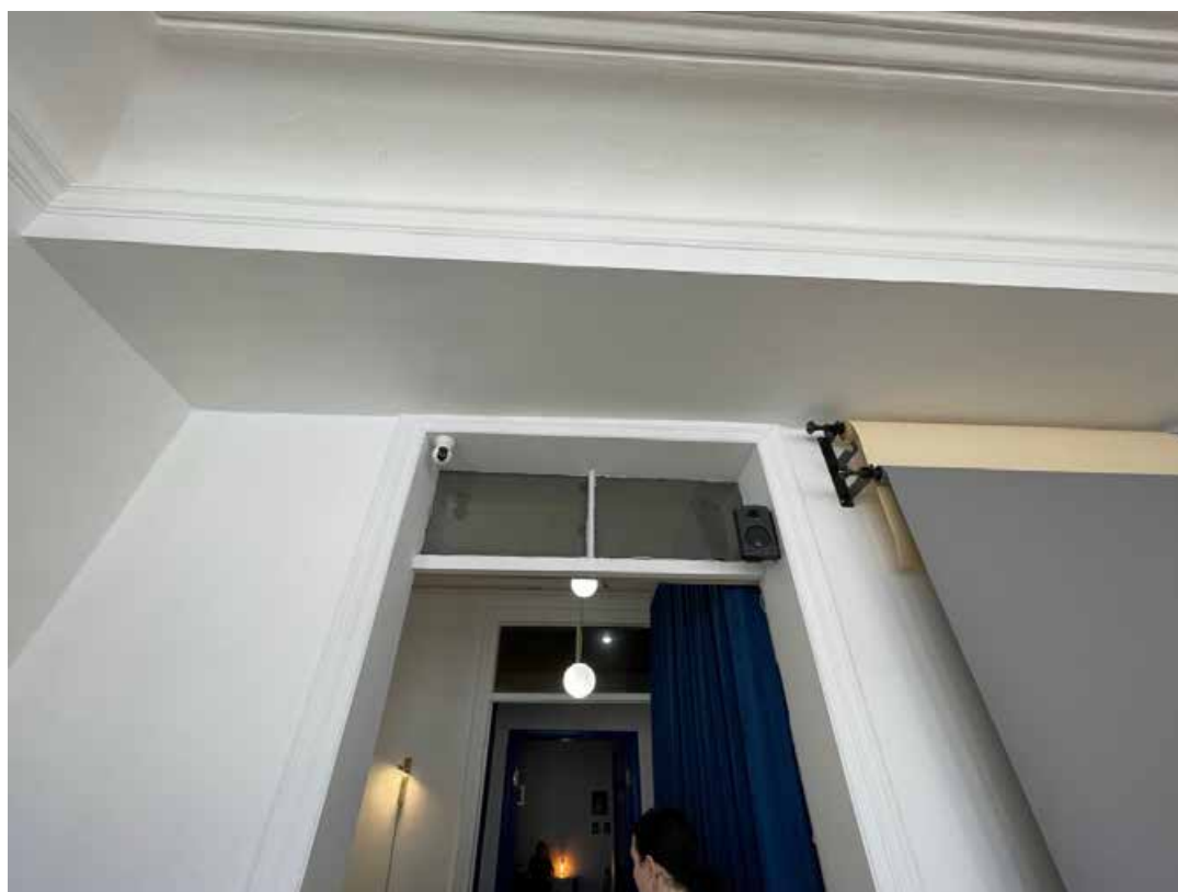
110. Оформление дверного проема (поздний) в помещении 23-Н(8). Заполнений не имеет, кроме остекленной фрамуги.
