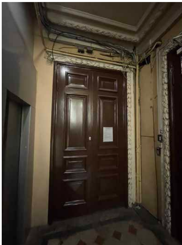
65. Дверной проем в помещение 22-Н(2). Имеются утраты наличника с растительными элементами в профилированной раме. Лепной декоративный элемент с картушем над дверным проемом отсутствует.
