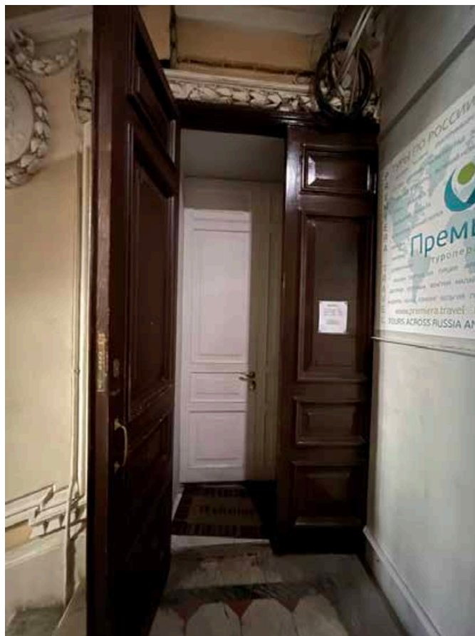
63. Дверной проем в помещение 12-Н(1). Оформление лепной композицией с картушем над дверным проемом отсутствует.
