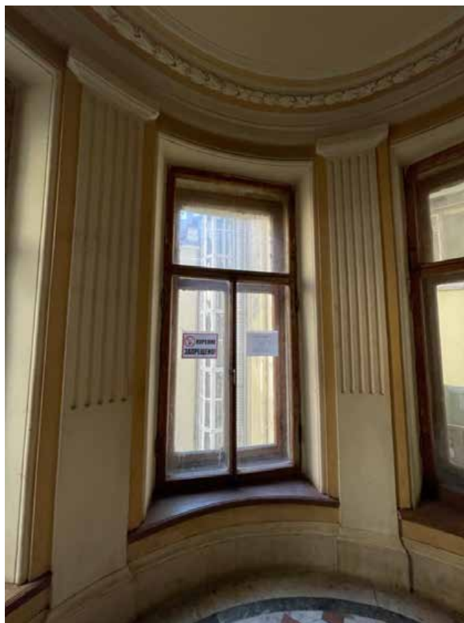
83. Оконный проем круглого ризалита лестничной площадки между четвертым и пятым этажами. Вид в южную сторону. Оформление пилястр маскаронами в простенках между окнами отсутствует.
