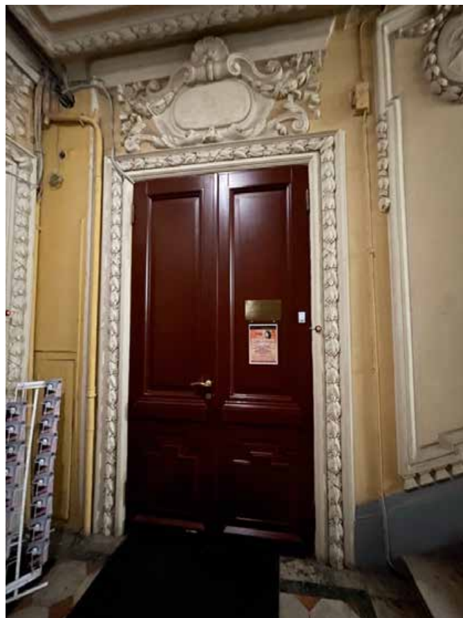
51. Дверной проем в помещении 4-Н(1). Дверное заполнение и оформление проема аналогичны заполнениям на этаже. Утраты минимальные.
