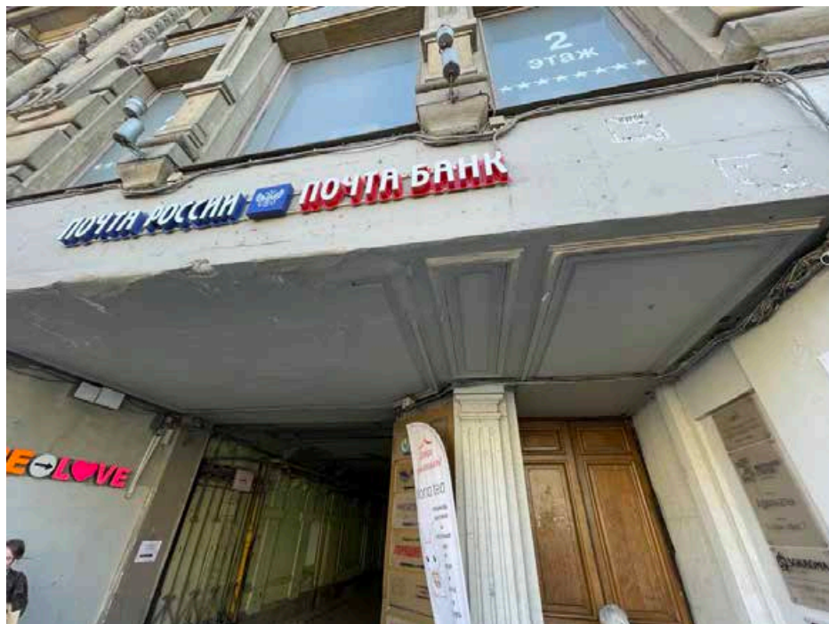
9. Общий вид профилированных панелей потолка над проездной аркой и главным входом с Невского проспекта.
