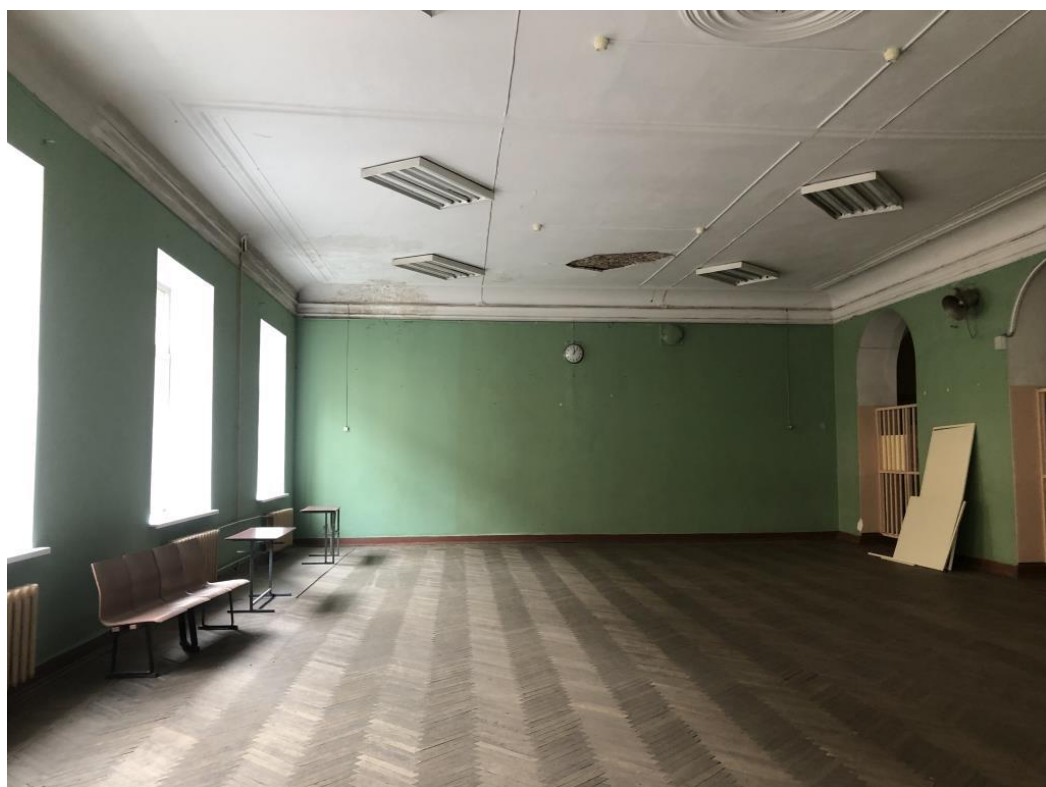
38. Здание Петровского коммерческого училища Санкт-Петербургского купеческого общества (с флигелями, сквером, металлической оградой). 2-й этаж. Рекреации. Штиглиц М.С. 30.11.2020.
