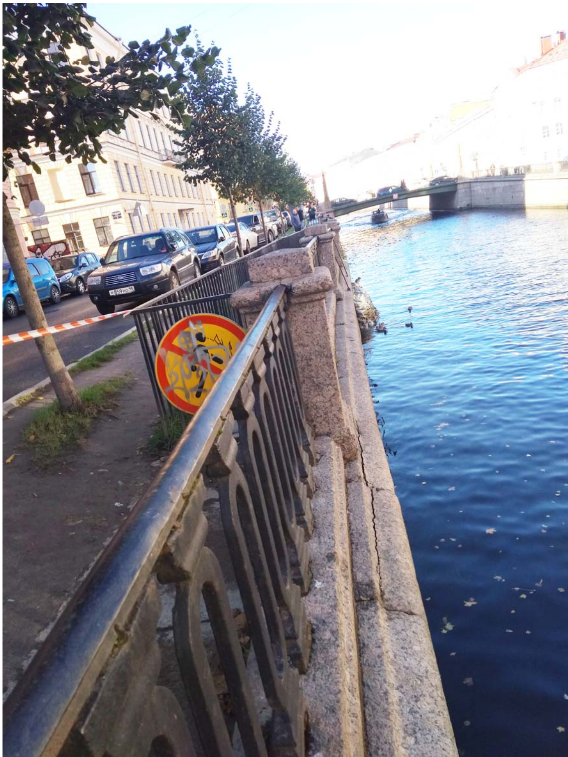
Фото 3. Набережная канала Грибоедова. Фрагмент аварийного участка.
