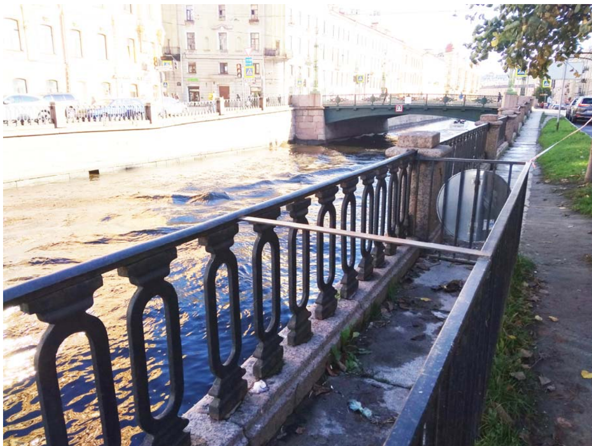
Фото 6. Набережная канала Грибоедова. Ограждение аварийного участка
