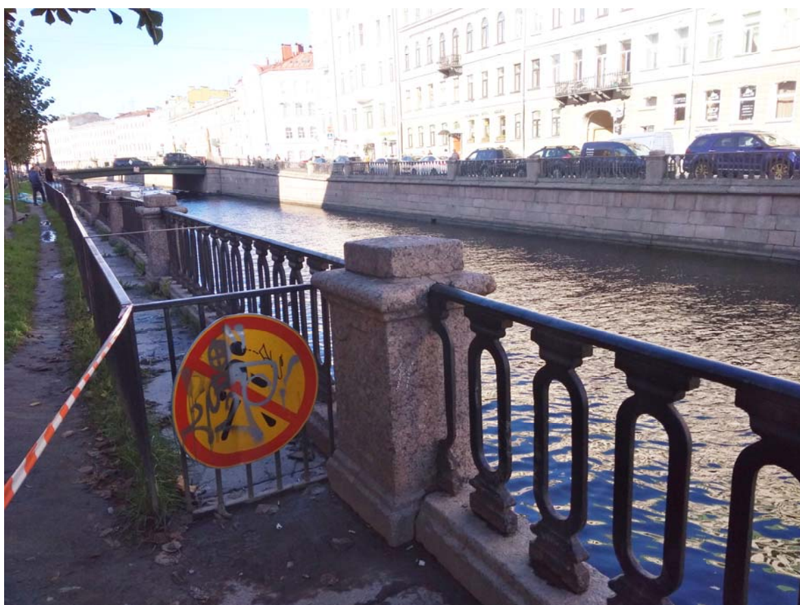
Фото 7. Набережная канала Грибоедова. Ограждение аварийного участка.
