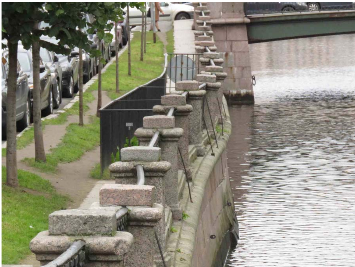
Фото 4. Набережная канала Грибоедова. Общий вид аварийного участка.
