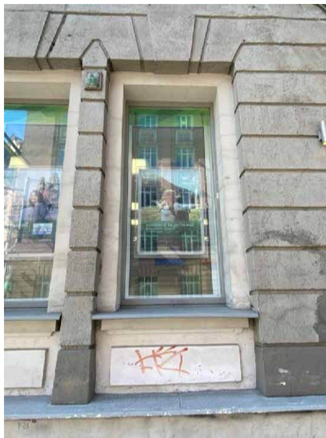
Фото 15. Оформление оконных проемов 1-го этажа замковыми камнями и филенками в подоконных простенках.
