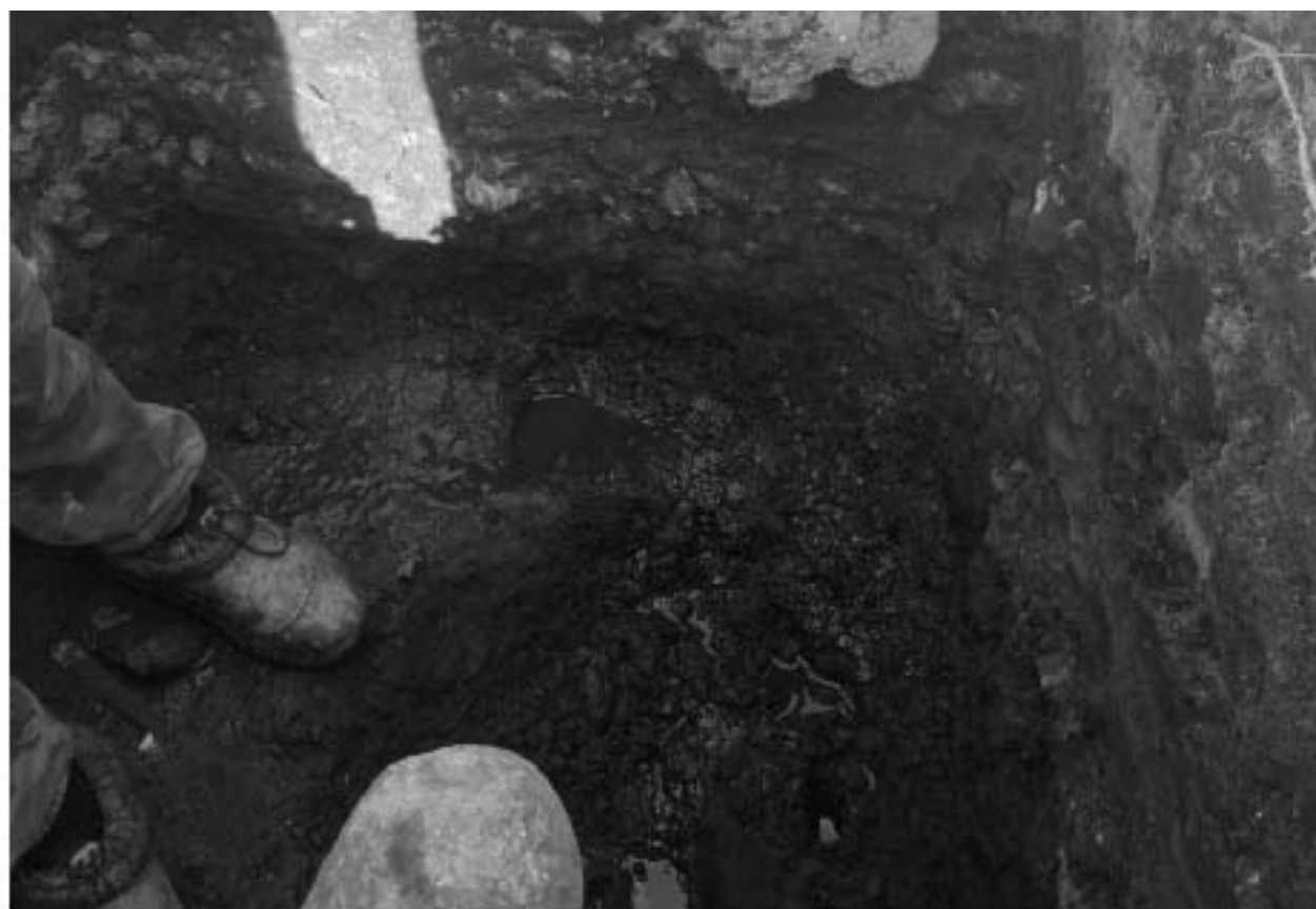
Илл. 18. г. Санкт-Петербург, муниципальное образование Большая Охта, Салтыковская дорога, участок 17 (кад. № 78:11:0604302:1139). Выход грунтовых вод на уровне нивелировочных подсыпок. Рабочий момент.
