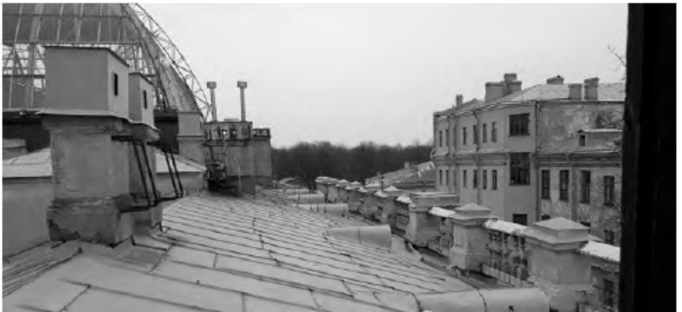
Фото 9. Объект культурного наследия федерального значения "Центральное училище технического рисования и музей Штиглица А.Л" по адресу: Санкт-Петербург, Соляной пер., д. 13-15, лит. А. Кровля и медный купол здания Музея
