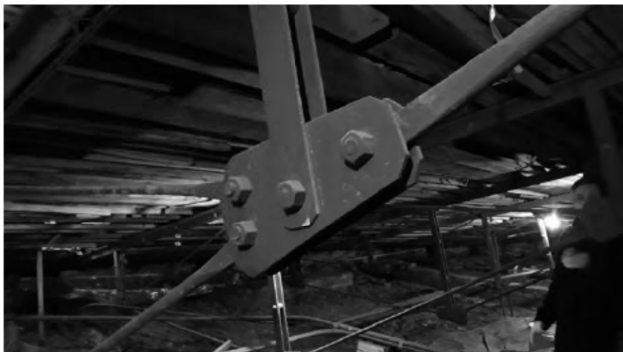
Фото 3. Объект культурного наследия федерального значения "Центральное училище технического рисования и музей Штиглица А.Л" по адресу: Санкт-Петербург, Соляной пер., д. 13-15, лит. А. Кровля и медный купол здания Музея
