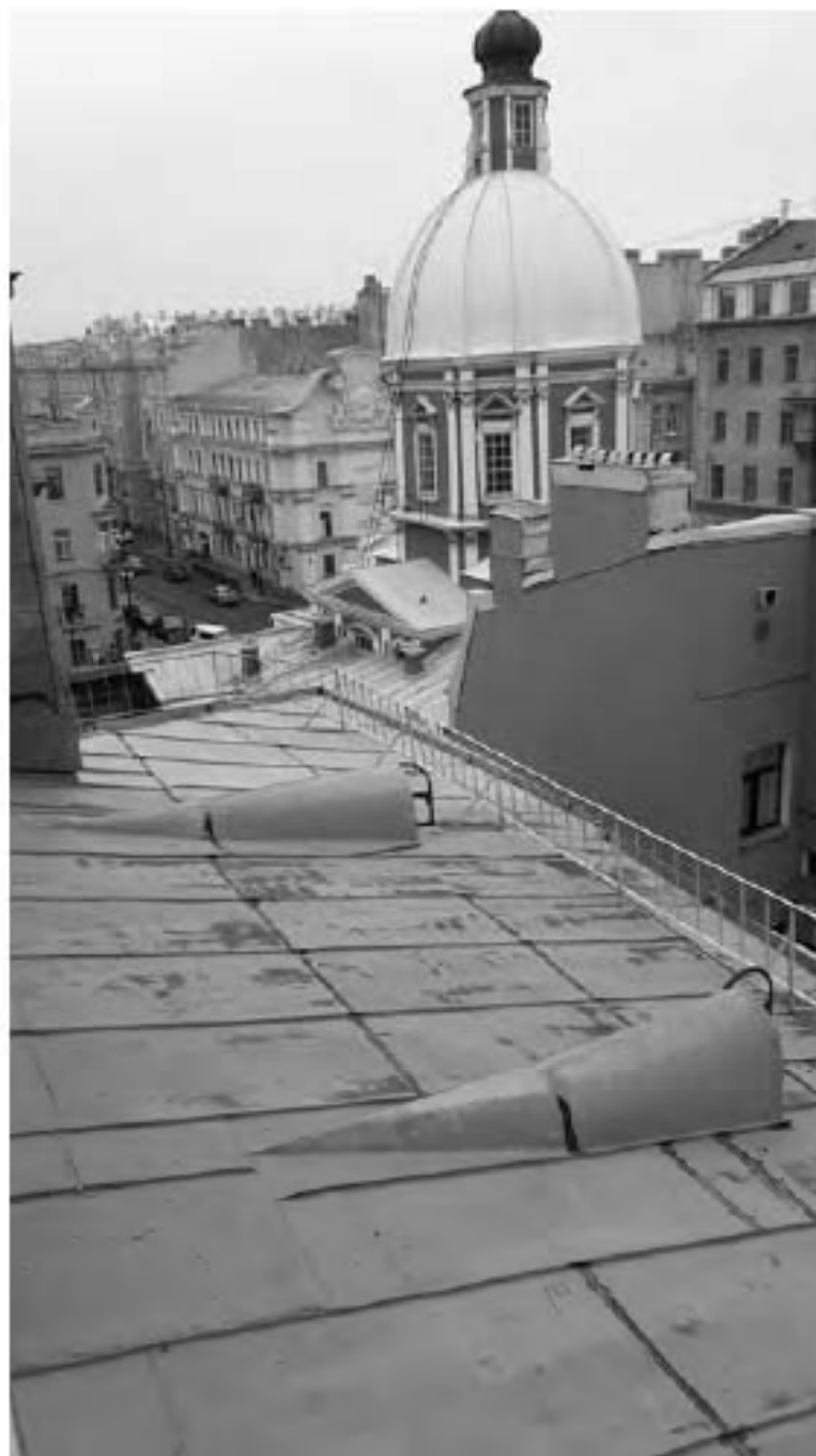
Фото 12. Объект культурного наследия федерального значения "Центральное училище технического рисования и музей Штиглица А.Л" по адресу: Санкт-Петербург, Соляной пер., д. 13-15, лит. А. Кровля и медный купол здания Музея
