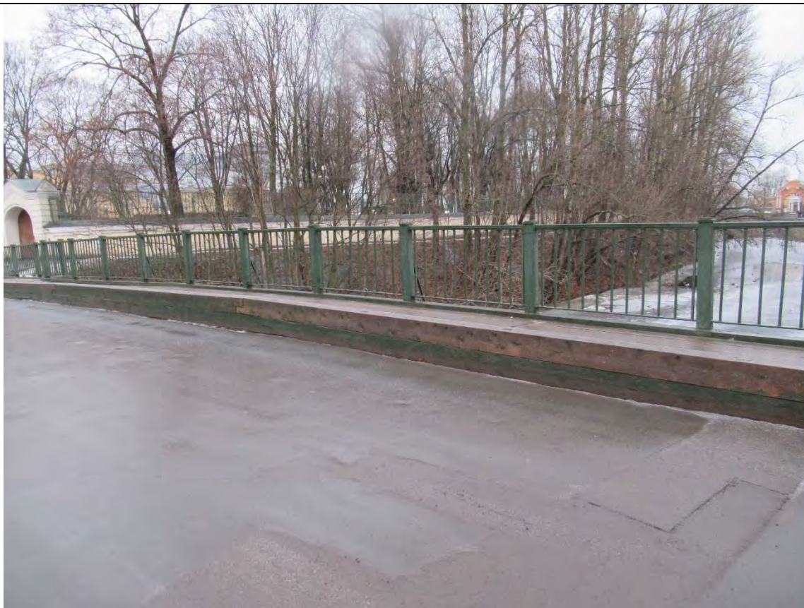
31. Объект культурного наследия регионального значения «Лаврский 2-ой мост» по адресу: г. Санкт-Петербург, через реку Монастырку по Лаврскому проезду. Вид на колесоотбойное ограждение – деревянный брус - верховой части моста. (Дата съемки 01.12.2020)
