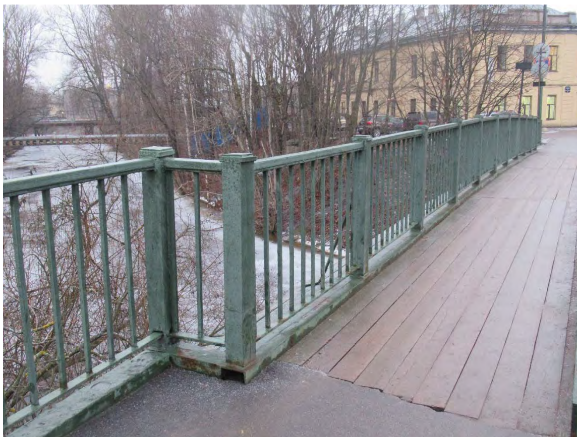
28. Объект культурного наследия регионального значения «Лаврский 2-ой мост» по адресу: г. Санкт-Петербург, через реку Монастырку по Лаврскому проезду. Вид на перильную ограду низовой части моста. (Дата съемки 01.12.2020)
