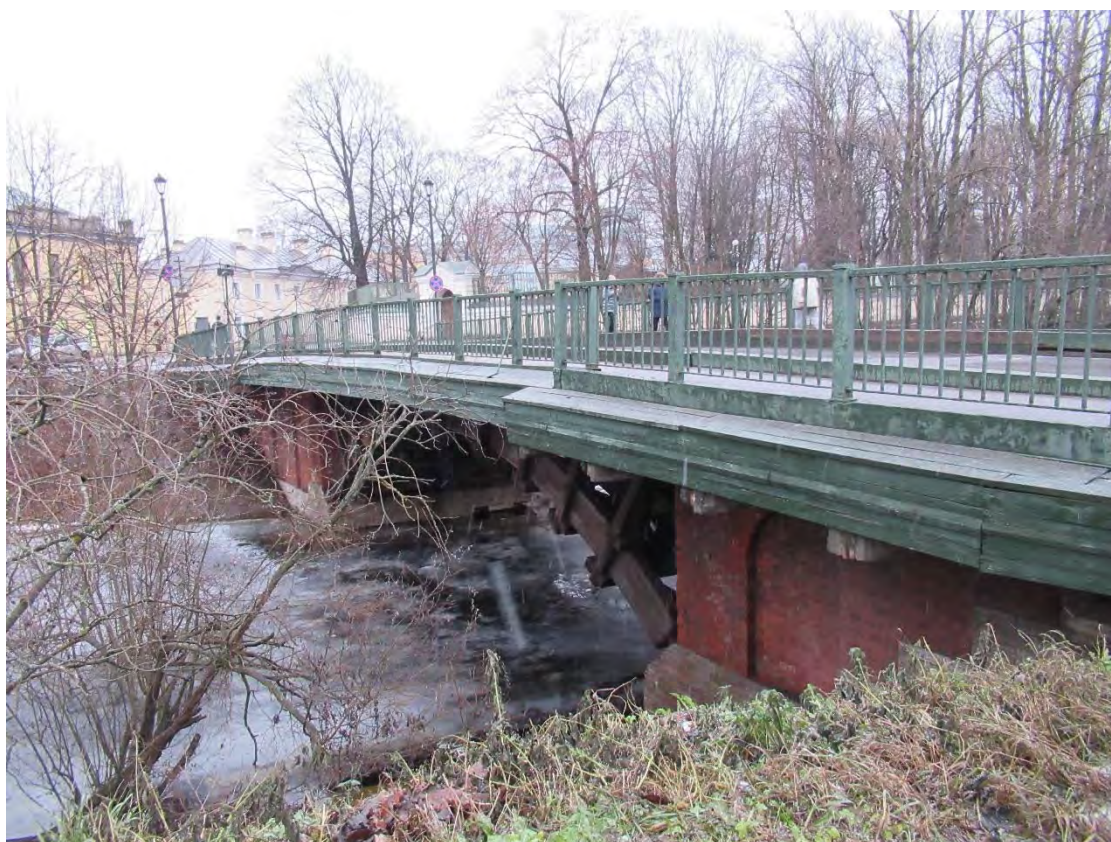
37. Объект культурного наследия регионального значения «Лаврский 2-ой мост» по адресу: г. Санкт-Петербург, через реку Монастырку по Лаврскому проезду. Вид на дощатый карниз нижней части моста от Епархиальной просфорной. (Дата съемки 01.12.2020)
