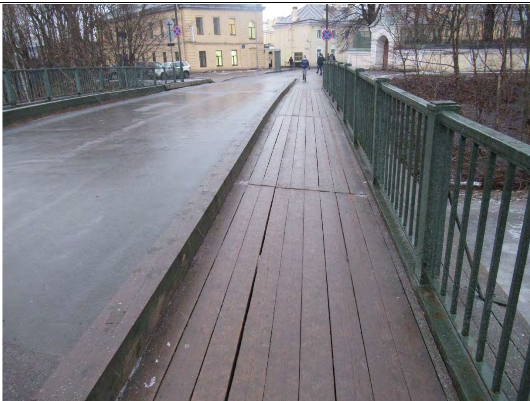
38. Объект культурного наследия регионального значения «Лаврский 2-ой мост» по адресу: г. Санкт-Петербург, через реку Монастырку по Лаврскому проезду. Вид на мостового покрытия (дошатога настила) верховой части моста. (Дата съемки 01.12.2020)
