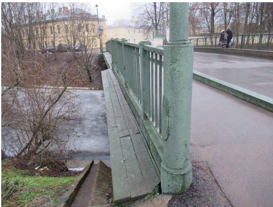
16. Объект культурного наследия регионального значения «Лаврский 2-ой мост» по адресу: г. Санкт-Петербург, через реку Монастырку по Лаврскому проезду. Вид на фрагмент фонарного столба и перильную ограду низовой части моста. (Дата съемки 01.12.2020)
