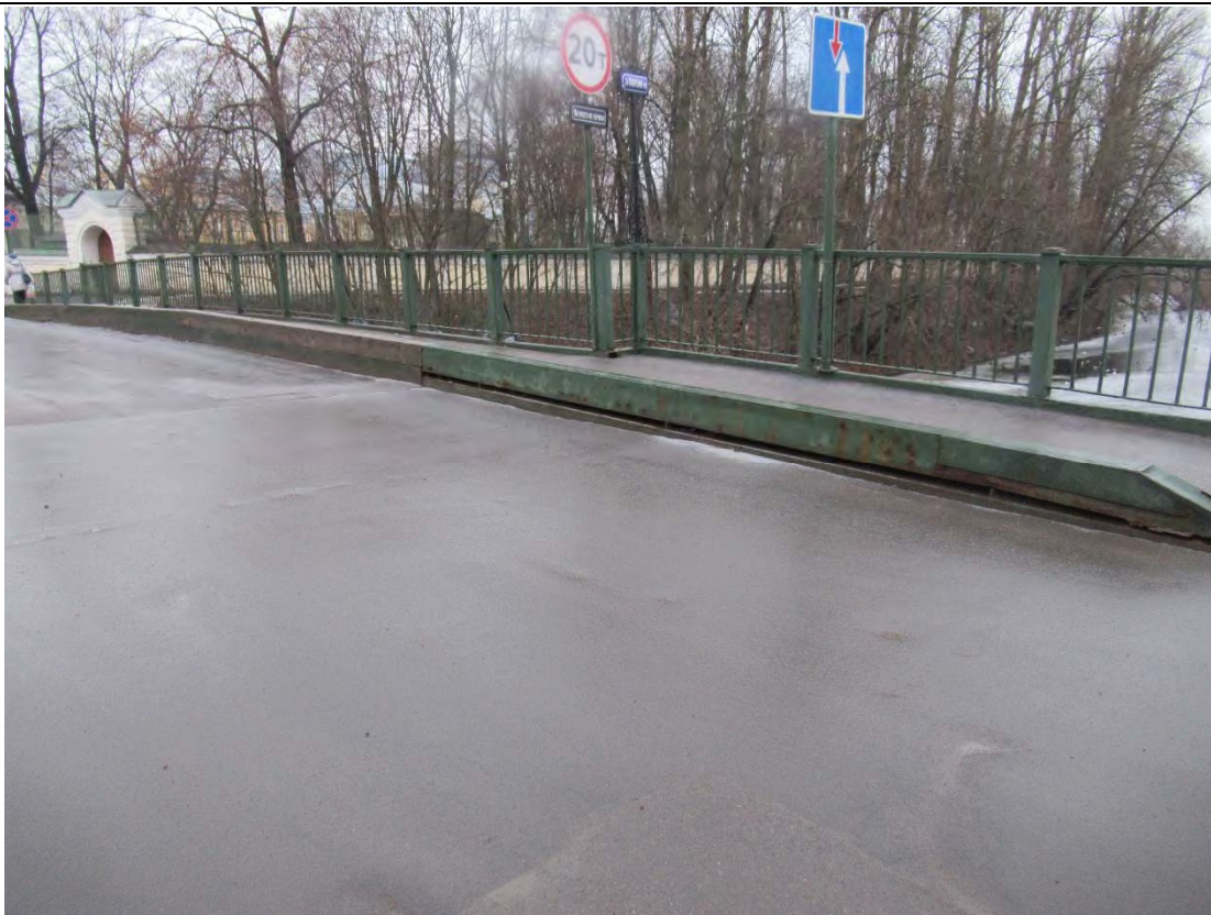
29. Объект культурного наследия регионального значения «Лаврский 2-ой мост» по адресу: г. Санкт-Петербург, через реку Монастырку по Лаврскому проезду. Вид на колесоотбойное ограждение верховой части моста. (Дата съемки 01.12.2020)
