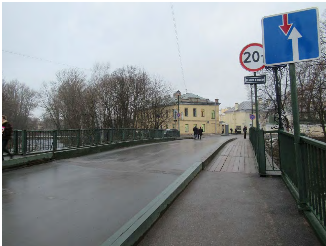
17. Объект культурного наследия регионального значения «Лаврский 2-ой мост» по адресу: г. Санкт-Петербург, через реку Монастырку по Лаврскому проезду. Вид на мост. (Дата съемки 01.12.2020)
