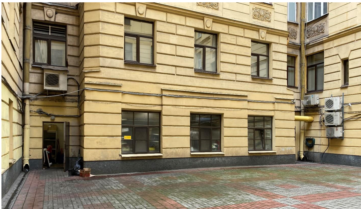
Фото 3. Фрагмент юго-восточного фасада первого двора-колодца. На первом этаже находится нежилое помещение 3-Н. Вид с юго-востока
