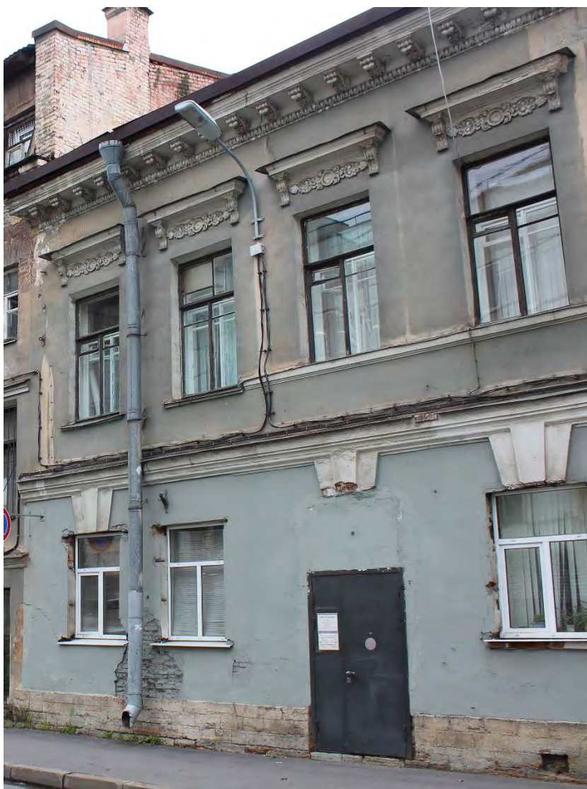
21. г. Санкт-Петербург, Кожевенная линия, д. 1-3. Выявленный объект культурного наследия «Кожевенный завод А.А. Парамонова». Особняк владельца (Кожевенная линия, д. 1-3, лит. Р). Фрагмент лицевого (юго-восточного) фасада. Вид с Кожевенной линии. Дата фотофиксации: 13.09.2021.
