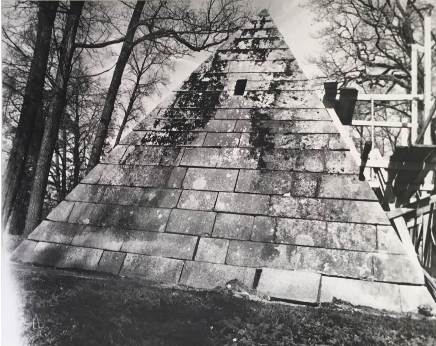
8. Пирамида, юго-западный фасад. Фотофиксация до начала реставрационных работ. Проект реставрации ИЧП Архитектурно-реставрационной мастерской Павловой И. Е. «Ирина». 1996 // Архив ГМЗ «Царское Село» инв. № 1733
