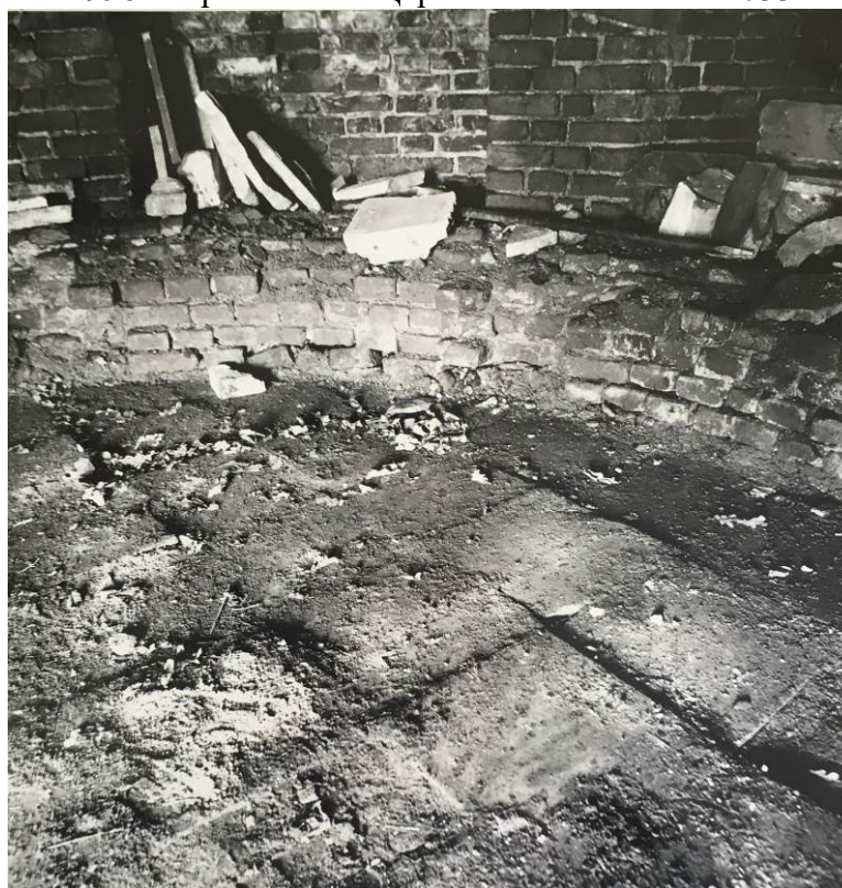
12. Пирамида, полы. Фотофиксация до начала реставрационных работ. Проект реставрации ИЧП Архитектурно-реставрационной мастерской Павловой И. Е. «Ирина». 1996 // Архив ГМЗ «Царское Село» инв. № 1733
