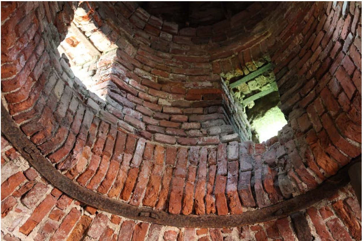
13. Свод объекта культурного наследия федерального значения «Пирамида с четырьмя колоннами», расположенного по адресу: Санкт-Петербург, г. Пушкин, Екатерининский парк, литера БЗ, входящего в состав объекта культурного наследия федерального значения «Екатерининский дворец и парк. Парк Екатерининский». 24.08.2021.
