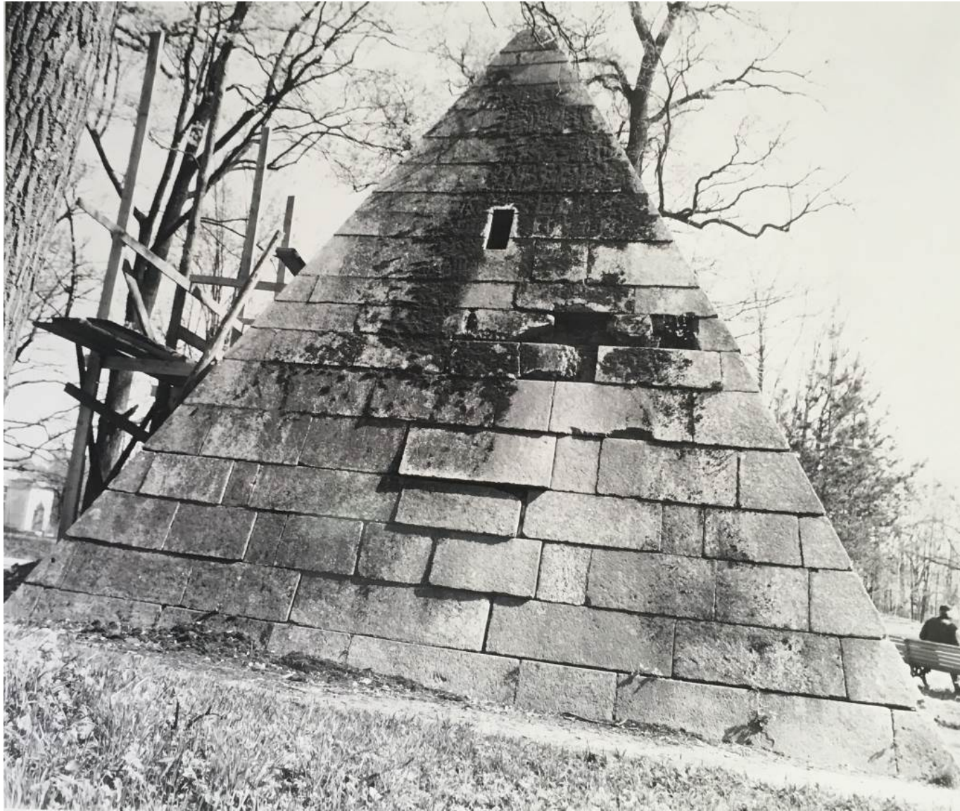
7. Пирамида, северо-западный фасад. Фотофиксация до начала реставрационных работ. Проект реставрации ИЧП Архитектурно-реставрационной мастерской Павловой И. Е. «Ирина». 1996 // Архив ГМЗ «Царское Село» инв. № 1733.
