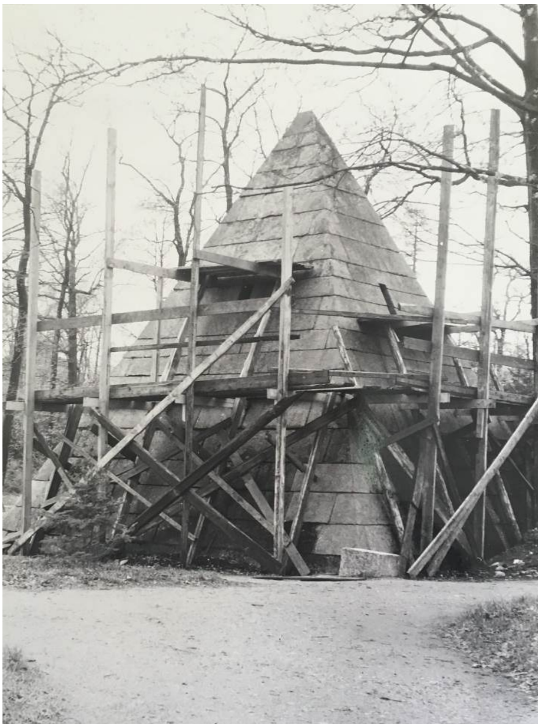
9. Пирамида, юго-восточный и северо-восточный фасады. Фотофиксация до начала реставрационных работ. Проект реставрации ИЧП Архитектурно-реставрационной мастерской Павловой И. Е. «Ирина». 1996 // Архив ГМЗ «Царское Село» инв. № 1733
