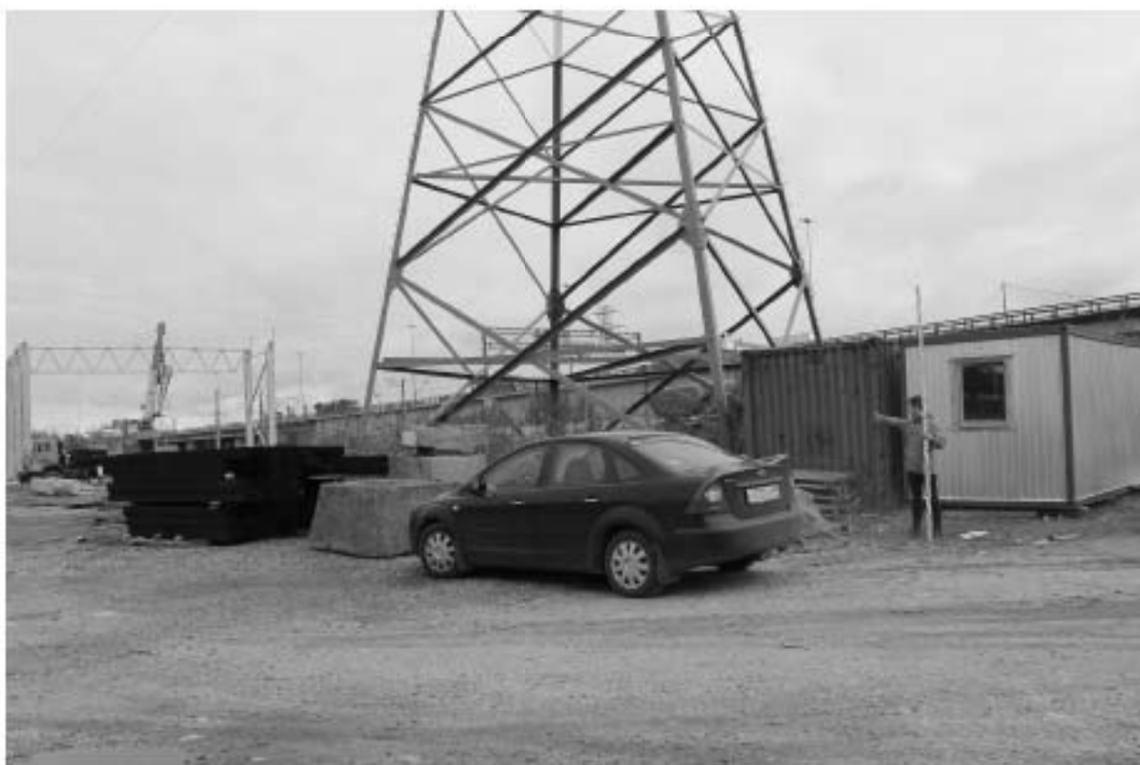
Рис. 33. Санкт Петербург, Фрунзенский район, Грузовой проезд, восточнее д. 23, литера П. Общий вид на участок работ с ЮЗ. Точка съемки 7.
