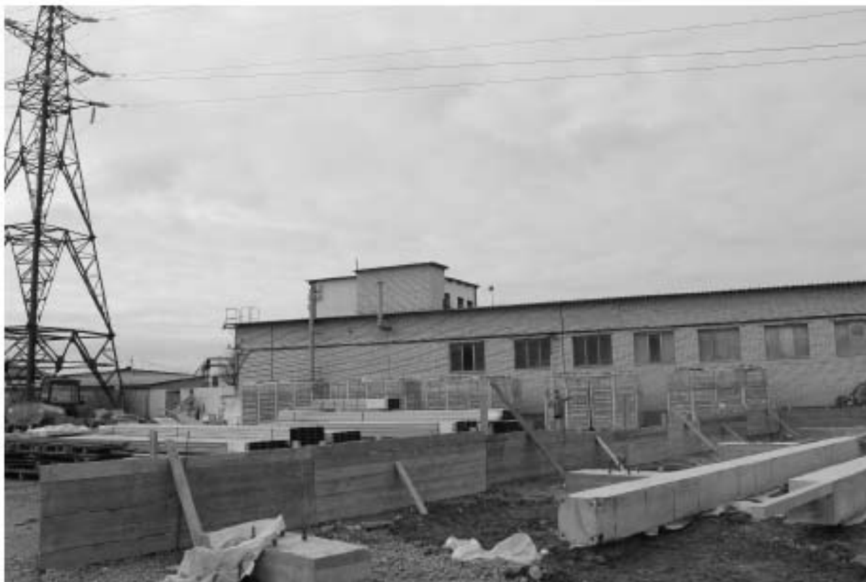
Рис. 30. Санкт Петербург, Фрунзенский район, Грузовой проезд, восточнее д. 23, литера П. Общий вид на участок работ с СВ. Точка съемки 6.
